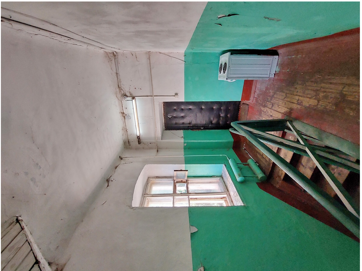
21 ОКН федерального значения “Казарма, где в 1764-1768 гг. квартировали солдаты Суздальского пехотного полка, командиром которого был Суворов Александр Васильевич” Ленинградская область, Волховский район, г. Новая Ладога, Пролетарский канал, д. 12. Лестница А. 2 этаж. Дата съемки: 30.06.2022 г.
