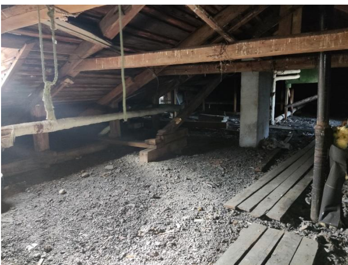
29. «Дом Лунда», Ленинградская область, Выборгский район, г. Выборг, ул. Прогонная, д.6. Чердак. Фрагмент. Фото 20.08.2022г.
