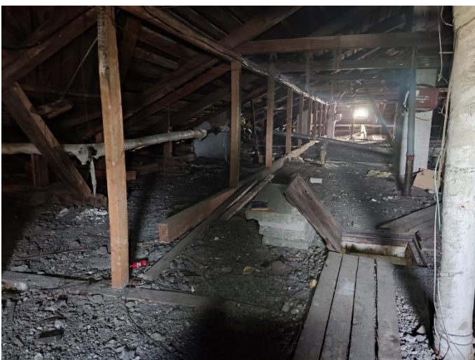
34. «Дом Лунда», Ленинградская область, Выборгский район, г. Выборг, ул. Прогонная, д.6. Чердак. Фрагмент. Фото 20.08.2022г.
