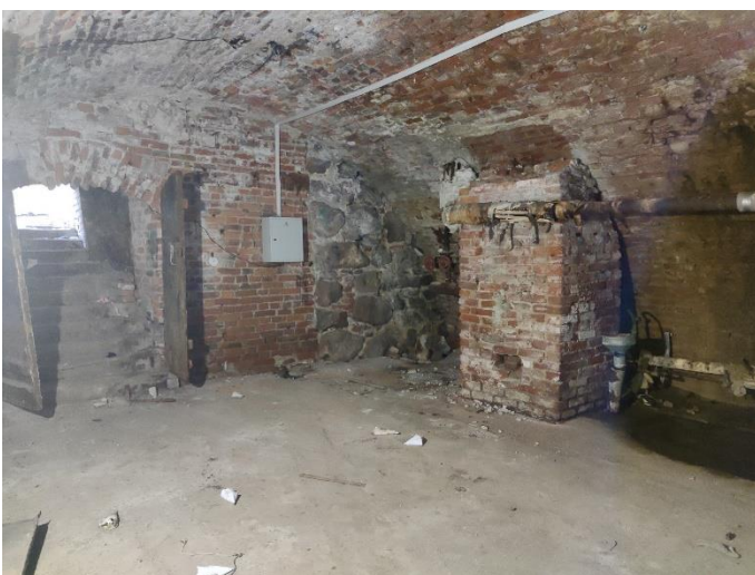
17. «Дом Лунда», Ленинградская область, Выборгский район, г. Выборг, ул. Прогонная, д.6. Подвал. Общий вид. Фото 20.08.2022г.
