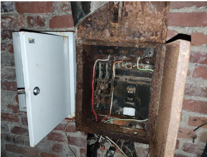
21. «Дом Лунда», Ленинградская область, Выборгский район, г. Выборг, ул. Прогонная, д.6. Подвал. Фрагмент. Фото 20.08.2022г.
