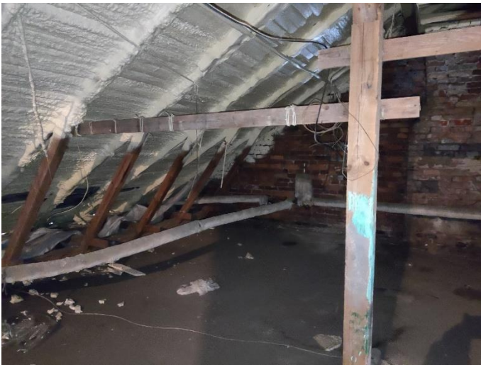
36. «Жилой дом акционерного общества «Калеваринне»», Ленинградская область, Выборгский район, г. Выборг, ул. Первомайская, д.2. Чердак. Фрагмент. Фото 20.08.2022г.
