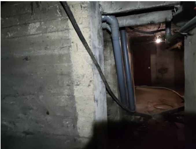
30. «Жилой дом акционерного общества «Калеваринне»», Ленинградская область, Выборгский район, г. Выборг, ул. Первомайская, д.2. Подвал. Фрагмент. Фото 20.08.2022г.
