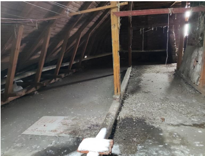
42. «Жилой дом акционерного общества «Калеваринне»», Ленинградская область, Выборгский район, г. Выборг, ул. Первомайская, д.2. Чердак. Фрагмент. Фото 20.08.2022г.
