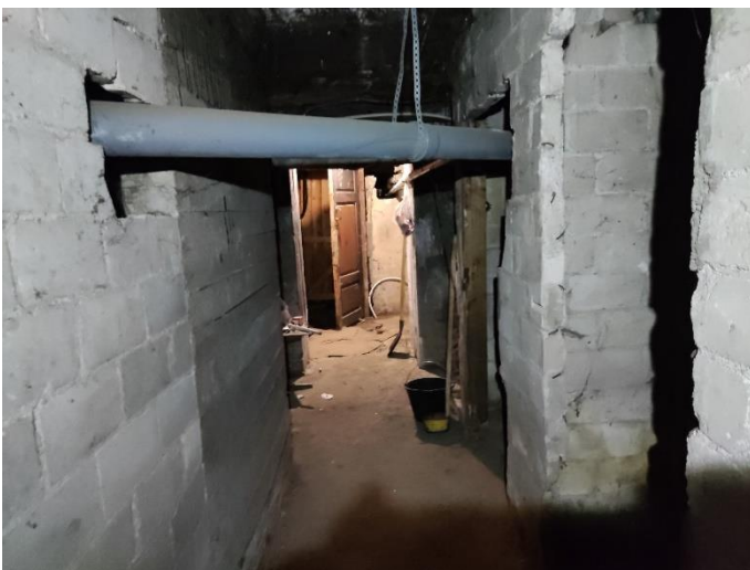
26. «Жилой дом акционерного общества «Калеваринне»», Ленинградская область, Выборгский район, г. Выборг, ул. Первомайская, д.2. Подвал. Фрагмент. Фото 20.08.2022г.
