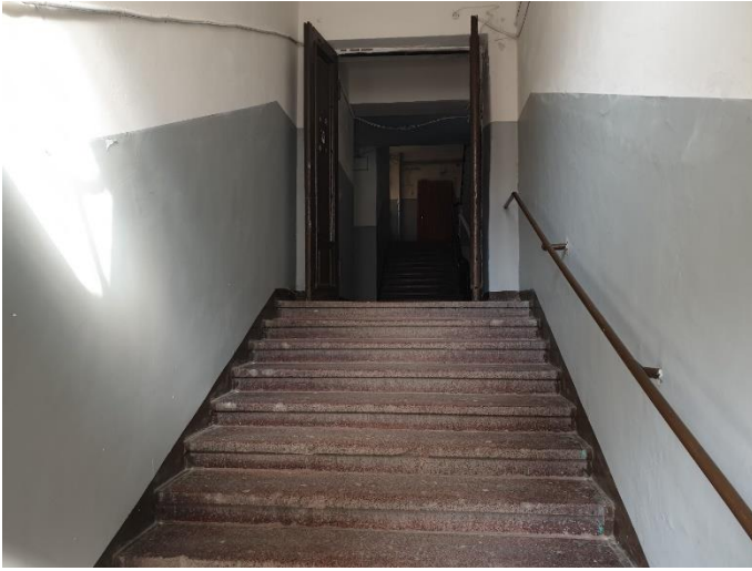
3. «Жилой дом акционерного общества «Калеваринне»», Ленинградская область, Выборгский район, г. Выборг, ул. Первомайская, д.2. Подъезд. Общий вид. Фото 20.08.2022г.
