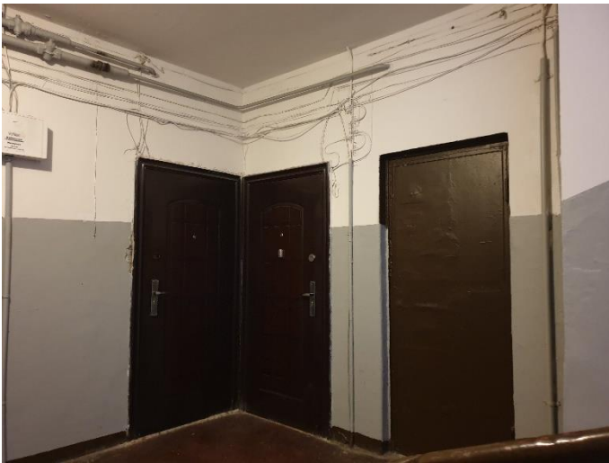
12. «Жилой дом акционерного общества «Калеваринне»», Ленинградская область, Выборгский район, г. Выборг, ул. Первомайская, д.2. Подъезд. Фрагмент. Фото 20.08.2022г.
