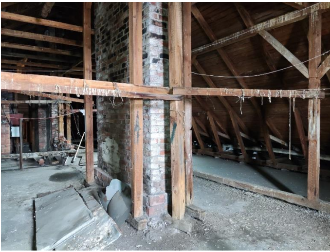
45. «Жилой дом акционерного общества «Калеваринне»», Ленинградская область, Выборгский район, г. Выборг, ул. Первомайская, д.2. Чердак. Фрагмент. Фото 20.08.2022г.
