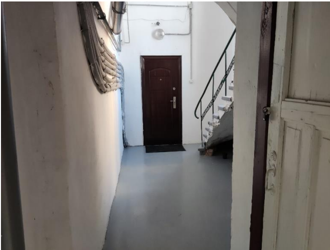
22. «Жилой дом», Ленинградская область, Выборгский район, г. Выборг, пр. Суворова, д.3. Подъезд №3. Фрагмент. Фото 20.08.2022г.
