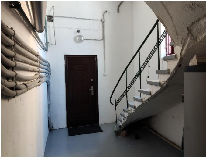
24. «Жилой дом», Ленинградская область, Выборгский район, г. Выборг, пр. Суворова, д.3. Подъезд №3. Фрагмент. Фото 20.08.2022г.
