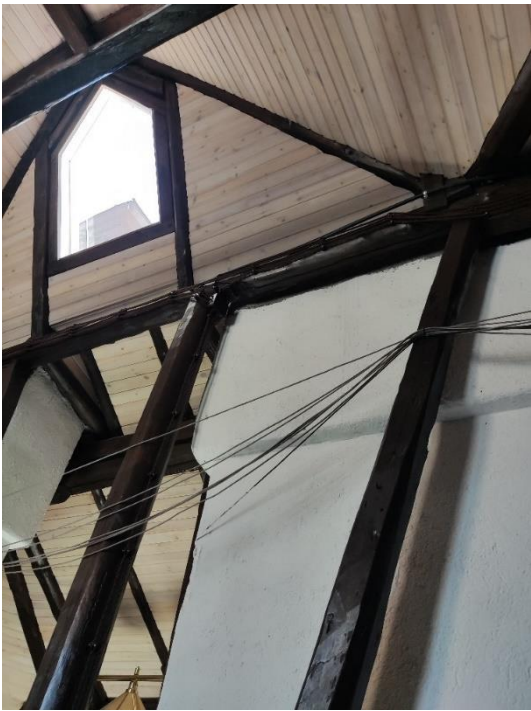
50. «Жилой дом», Ленинградская область, Выборгский район, г. Выборг, пр. Суворова, д.3. Чердак. Фрагмент. Фото 20.08.2022г.
