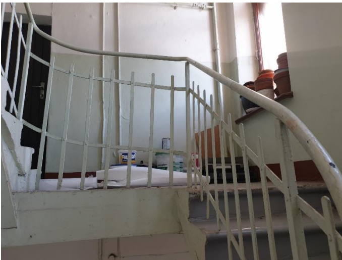
16. «Жилой дом», Ленинградская область, Выборгский район, г. Выборг, пр. Суворова, д.3. Подъезд №2. Фрагмент. Фото 20.08.2022г.
