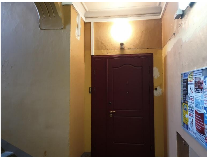
5. «Жилой дом», Ленинградская область, Выборгский район, г. Выборг, пр. Суворова, д.3. Подъезд №1. Фрагмент. Фото 20.08.2022г.
