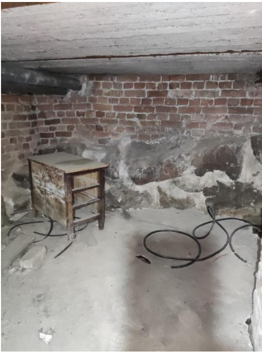
39. «Жилой дом», Ленинградская область, Выборгский район, г. Выборг, пр. Суворова, д.3. Подвал. Фрагмент. Фото 20.08.2022г.
