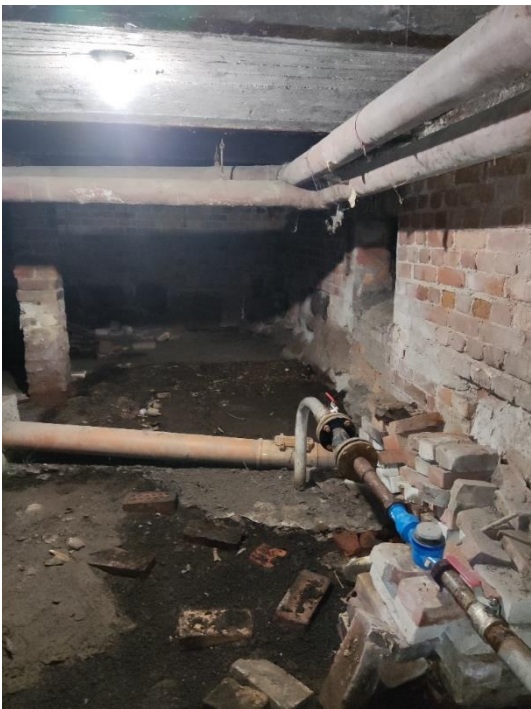
30. «Жилой дом», Ленинградская область, Выборгский район, г. Выборг, пр. Суворова, д.3. Подвал. Фрагмент. Фото 20.08.2022г.
