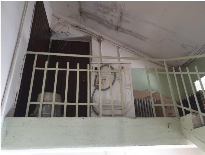
18. «Жилой дом», Ленинградская область, Выборгский район, г. Выборг, пр. Суворова, д.3. Подъезд №2. Фрагмент. Фото 20.08.2022г.
