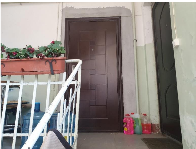
14. «Жилой дом», Ленинградская область, Выборгский район, г. Выборг, пр. Суворова, д.3. Подъезд №2. Фрагмент. Фото 20.08.2022г.
