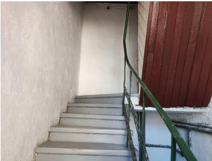
21. «Жилой дом», Ленинградская область, Выборгский район, г. Выборг, пр. Суворова, д.3. Подъезд №3. Фрагмент. Фото 20.08.2022г.
