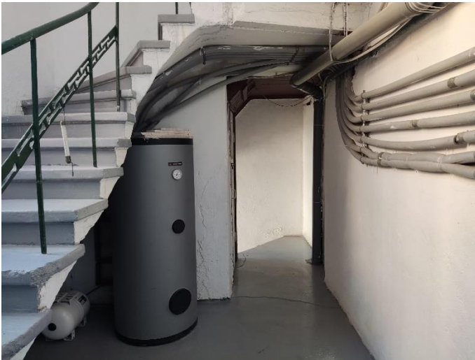
25. «Жилой дом», Ленинградская область, Выборгский район, г. Выборг, пр. Суворова, д.3. Подъезд №3. Фрагмент. Фото 20.08.2022г.
