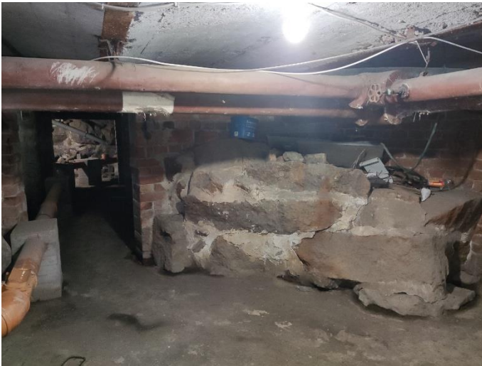
38. «Жилой дом», Ленинградская область, Выборгский район, г. Выборг, пр. Суворова, д.3. Подвал. Фрагмент. Фото 20.08.2022г.
