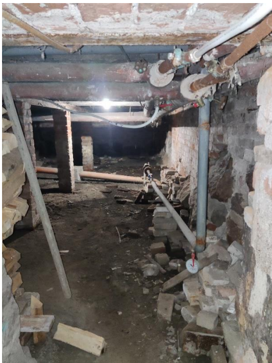
33. «Жилой дом», Ленинградская область, Выборгский район, г. Выборг, пр. Суворова, д.3. Подвал. Фрагмент. Фото 20.08.2022г.
