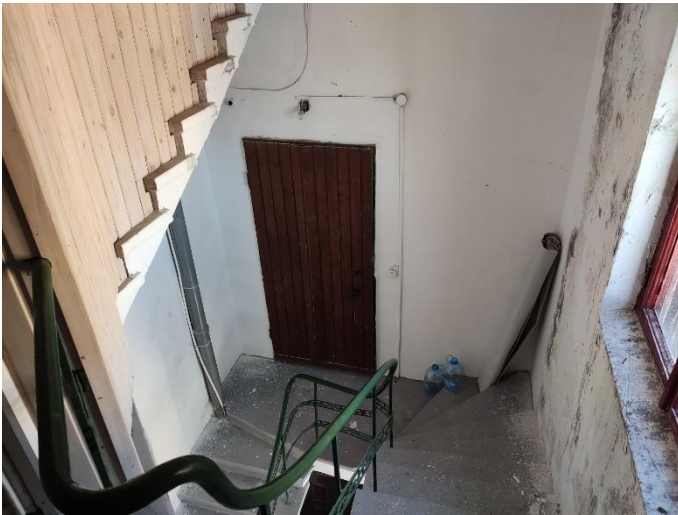
28. «Жилой дом», Ленинградская область, Выборгский район, г. Выборг, пр. Суворова, д.3. Подъезд №3. Фрагмент. Фото 20.08.2022г.
