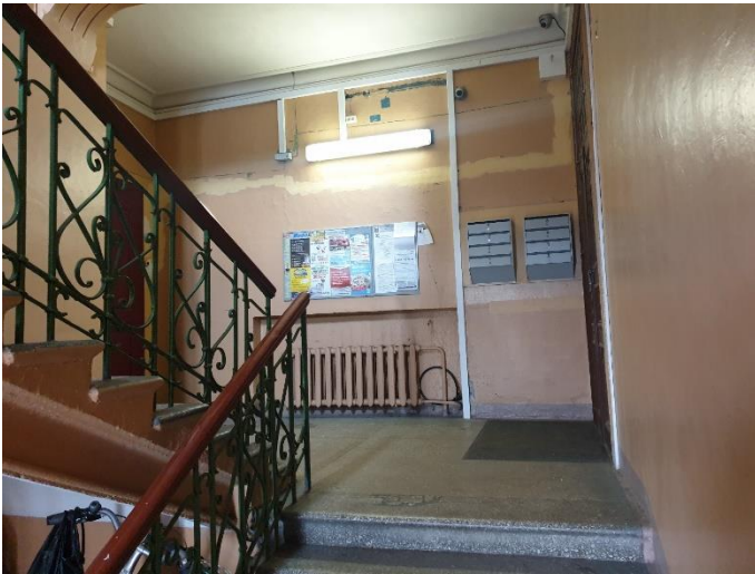
4. «Жилой дом», Ленинградская область, Выборгский район, г. Выборг, пр. Суворова, д.3. Подъезд №1. Фрагмент. Фото 20.08.2022г.
