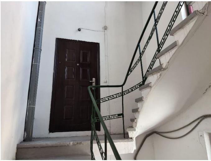
27. «Жилой дом», Ленинградская область, Выборгский район, г. Выборг, пр. Суворова, д.3. Подъезд №3. Фрагмент. Фото 20.08.2022г.
