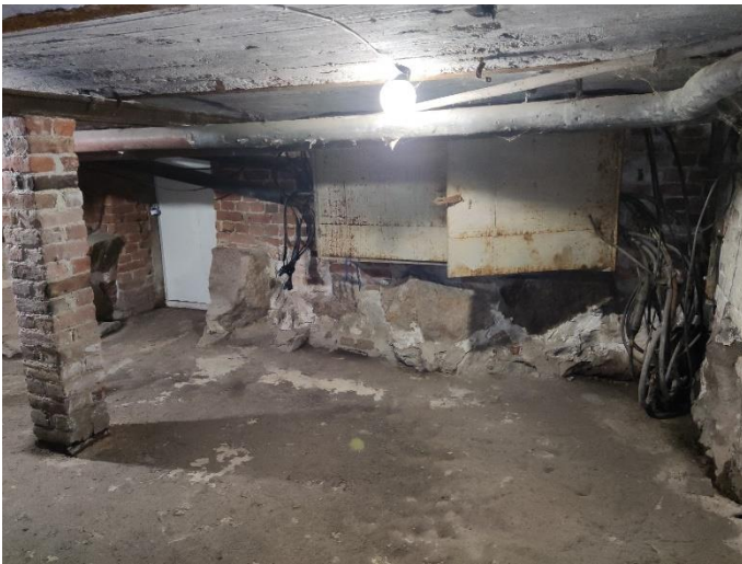
37. «Жилой дом», Ленинградская область, Выборгский район, г. Выборг, пр. Суворова, д.3. Подвал. Фрагмент. Фото 20.08.2022г.
