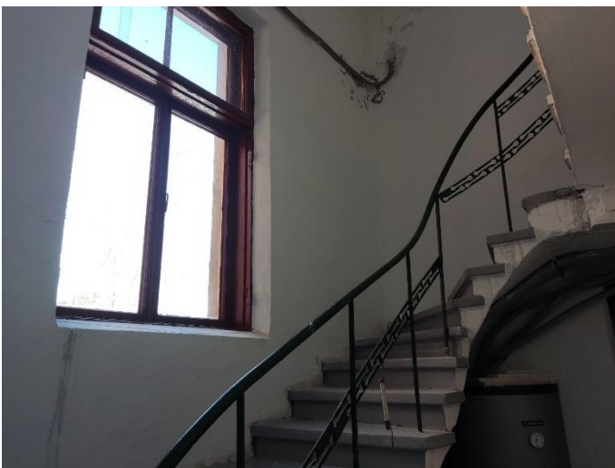
26. «Жилой дом», Ленинградская область, Выборгский район, г. Выборг, пр. Суворова, д.3. Подъезд №3. Фрагмент. Фото 20.08.2022г.
