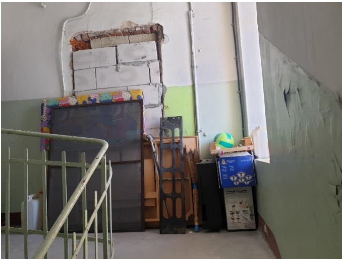
12. «Жилой дом», Ленинградская область, Выборгский район, г. Выборг, пр. Суворова, д.3. Подъезд №2. Фрагмент. Фото 20.08.2022г.
