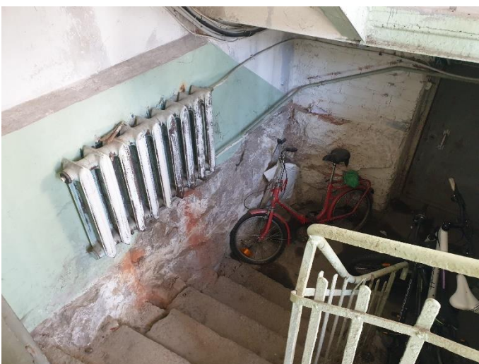
11. «Жилой дом», Ленинградская область, Выборгский район, г. Выборг, пр. Суворова, д.3. Подъезд №2. Фрагмент. Фото 20.08.2022г.
