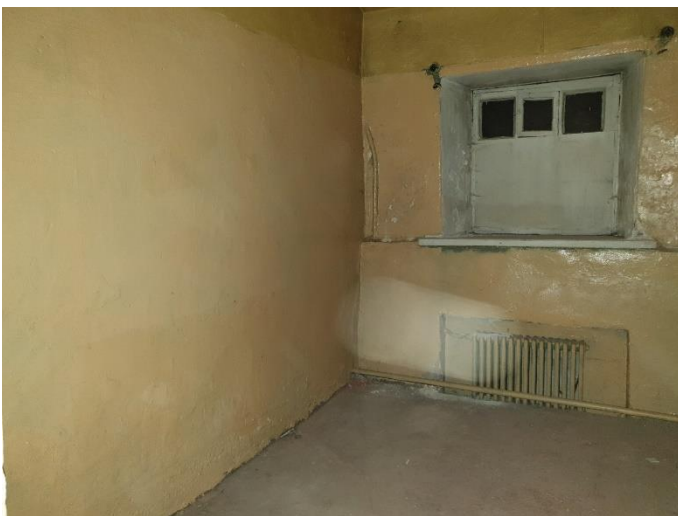
23. «Губернский почтовый дом», Ленинградская область, Выборгский район, г. Выборг, ул. Крепостная, д.3. Подвал. Фрагмент. Фото 20.08.2022г.
