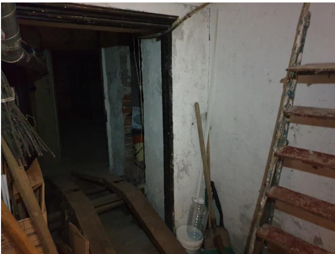
25. «Губернский почтовый дом», Ленинградская область, Выборгский район, г. Выборг, ул. Крепостная, д.3. Подвал. Фрагмент. Фото 20.08.2022г.
