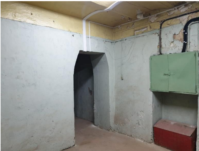
21. «Губернский почтовый дом», Ленинградская область, Выборгский район, г. Выборг, ул. Крепостная, д.3. Подвал. Фрагмент. Фото 20.08.2022г.
