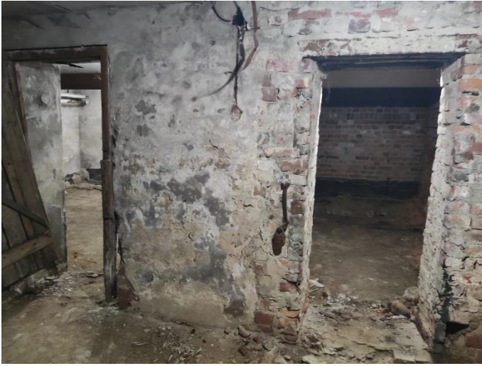
52. «Жилой дом акционерного общества «Пеликан», Ленинградская область, Выборгский район, г. Выборг, Ленинградский пр., д.2. Подвал. Фрагмент. Фото 20.08.2022г.
