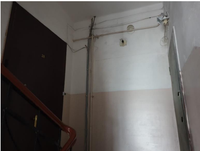
38. «Жилой дом акционерного общества «Пеликан», Ленинградская область, Выборгский район, г. Выборг, Ленинградский пр., д.2. Подъезд №7. Фрагмент. Фото 20.08.2022г.
