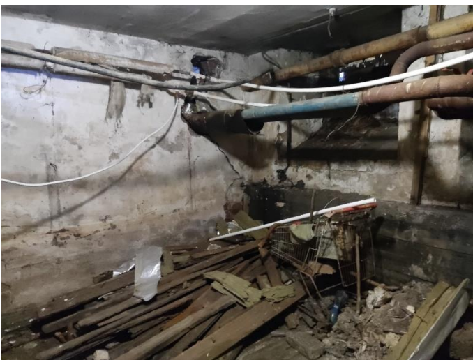
51. «Жилой дом акционерного общества «Пеликан», Ленинградская область, Выборгский район, г. Выборг, Ленинградский пр., д.2. Подвал. Фрагмент. Фото 20.08.2022г.
