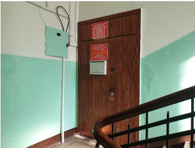
4. «Жилой дом акционерного общества «Пеликан», Ленинградская область, Выборгский район, г. Выборг, Ленинградский пр., д.2. Подъезд №1. Фрагмент. Фото 20.08.2022г.
