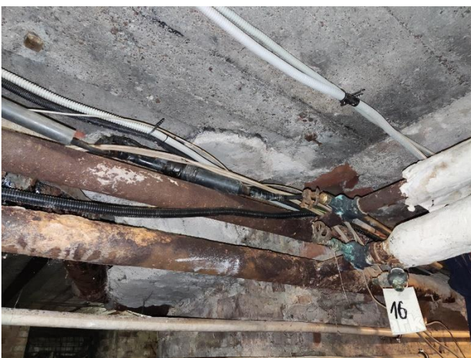
59. «Жилой дом акционерного общества «Пеликан», Ленинградская область, Выборгский район, г. Выборг, Ленинградский пр., д.2. Подвал. Фрагмент. Фото 20.08.2022г.
