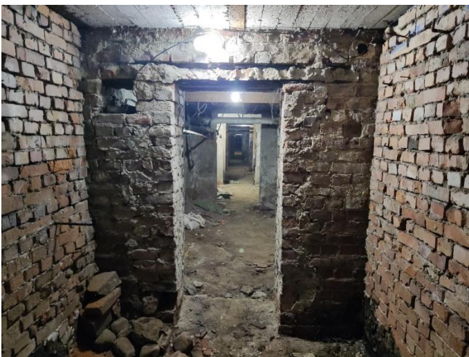
54. «Жилой дом акционерного общества «Пеликан», Ленинградская область, Выборгский район, г. Выборг, Ленинградский пр., д.2. Подвал. Фрагмент. Фото 20.08.2022г.
