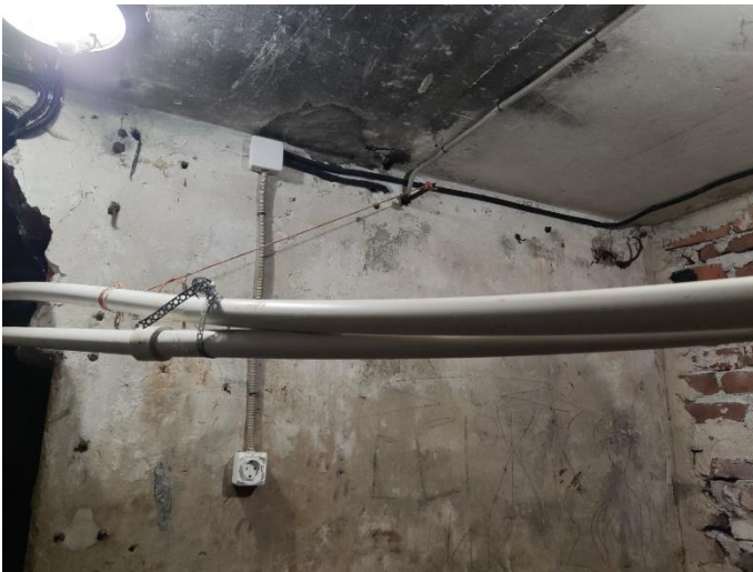
47. «Жилой дом акционерного общества «Пеликан», Ленинградская область, Выборгский район, г. Выборг, Ленинградский пр., д.2. Подвал. Фрагмент. Фото 20.08.2022г.
