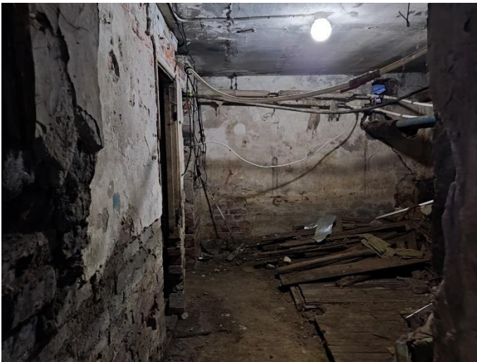
50. «Жилой дом акционерного общества «Пеликан», Ленинградская область, Выборгский район, г. Выборг, Ленинградский пр., д.2. Подвал. Фрагмент. Фото 20.08.2022г.
