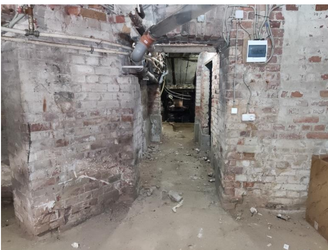
60. «Жилой дом акционерного общества «Пеликан», Ленинградская область, Выборгский район, г. Выборг, Ленинградский пр., д.2. Подвал. Фрагмент. Фото 20.08.2022г.
