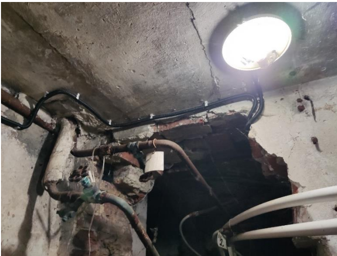
49. «Жилой дом акционерного общества «Пеликан», Ленинградская область, Выборгский район, г. Выборг, Ленинградский пр., д.2. Подвал. Фрагмент. Фото 20.08.2022г.
