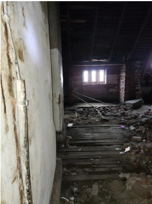
63. «Жилой дом акционерного общества «Пеликан», Ленинградская область, Выборгский район, г. Выборг, Ленинградский пр., д.2. Чердак. Фрагмент. Фото 20.08.2022г.
