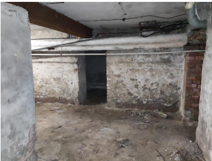
58. «Жилой дом акционерного общества «Пеликан», Ленинградская область, Выборгский район, г. Выборг, Ленинградский пр., д.2. Подвал. Фрагмент. Фото 20.08.2022г.
