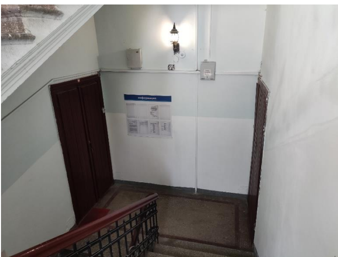
14. «Жилой дом акционерного общества «Пеликан», Ленинградская область, Выборгский район, г. Выборг, Ленинградский пр., д.2. Подъезд №3. Фрагмент. Фото 20.08.2022г.
