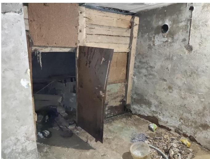
57. «Жилой дом акционерного общества «Пеликан», Ленинградская область, Выборгский район, г. Выборг, Ленинградский пр., д.2. Подвал. Фрагмент. Фото 20.08.2022г.
