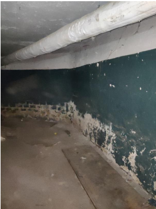
23. «Жилой дом», Ленинградская область, Выборгский район, г. Выборг, ул. Водной заставы., д.6. Подвал. Фрагмент. Фото 20.08.2022г.
