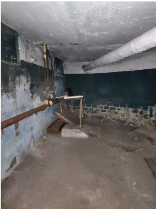
24. «Жилой дом», Ленинградская область, Выборгский район, г. Выборг, ул. Водной заставы., д.6. Подвал. Фрагмент. Фото 20.08.2022г.
