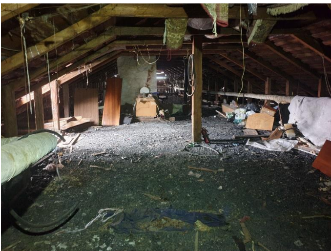
20. «Жилой дом акционерного общества «Айнола», Ленинградская область, Выборгский район, г. Выборг, ул. Некрасова, д.1. Чердак. Общий вид. Фото 20.08.2022г.
