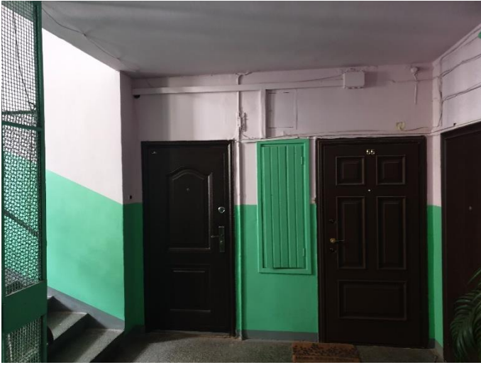
12. «Дом жилой с магазинами, гаражом», Ленинградская область, Выборгский район, г. Выборг, ул. Крепостная, д.47. Подъезд. Фрагмент. Фото 20.08.2022г.
