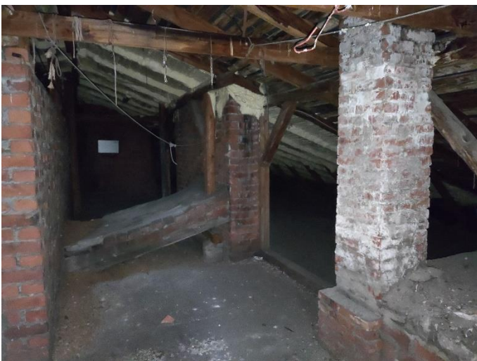
23. «Дом жилой с магазинами, гаражом», Ленинградская область, Выборгский район, г. Выборг, ул. Крепостная, д.47. Чердак. Фрагмент. Фото 20.08.2022г.
