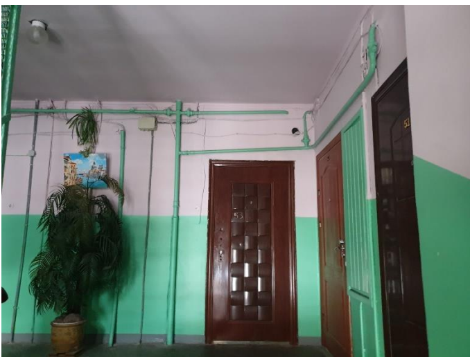
11. «Дом жилой с магазинами, гаражом», Ленинградская область, Выборгский район, г. Выборг, ул. Крепостная, д.47. Подъезд. Фрагмент. Фото 20.08.2022г.
