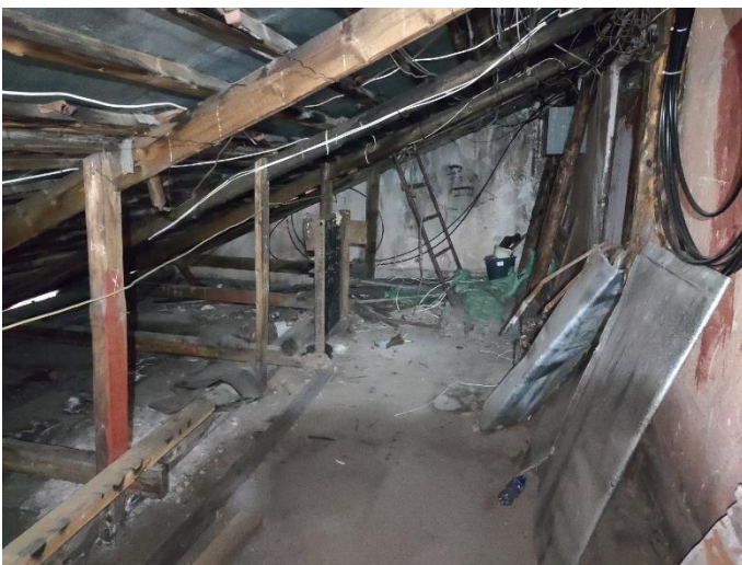
47. «Жилой дом с магазинами акционерного общества «Илвес», Ленинградская область, Выборгский район, г. Выборг, Ленинградское шоссе, д.11. Чердак. Общий вид. Фото 20.08.2022г.
