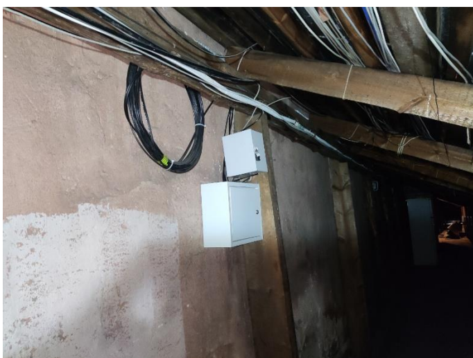
49. «Жилой дом с магазинами акционерного общества «Илвес», Ленинградская область, Выборгский район, г. Выборг, Ленинградское шоссе, д.11. Чердак. Фрагмент. Фото 20.08.2022г.
