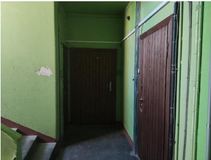
6. «Жилой дом с магазинами акционерного общества «Илвес», Ленинградская область, Выборгский район, г. Выборг, Ленинградское шоссе, д.11. Подъезд №1. Фрагмент. Фото 20.08.2022г.
