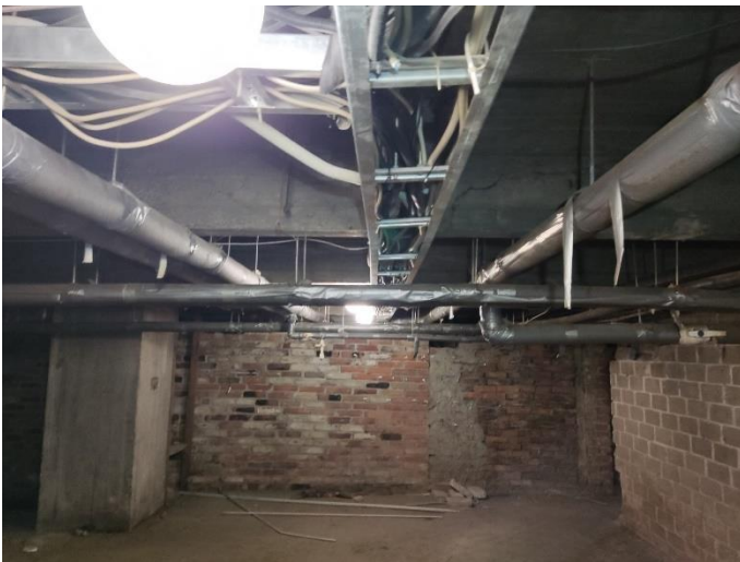
34. «Жилой дом с магазинами акционерного общества «Илвес», Ленинградская область, Выборгский район, г. Выборг, Ленинградское шоссе, д.11. Подвал. Фрагмент. Фото 20.08.2022г.
