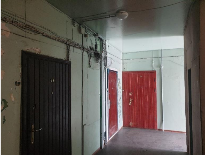
15. «Жилой дом с магазинами акционерного общества «Илвес», Ленинградская область, Выборгский район, г. Выборг, Ленинградское шоссе, д.11. Подъезд №2. Фрагмент. Фото 20.08.2022г.
