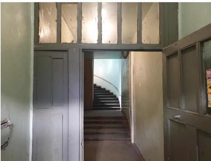
10. «Жилой дом с магазинами акционерного общества «Илвес», Ленинградская область, Выборгский район, г. Выборг, Ленинградское шоссе, д.11. Подъезд №2. Общий вид. Фото 20.08.2022г.
