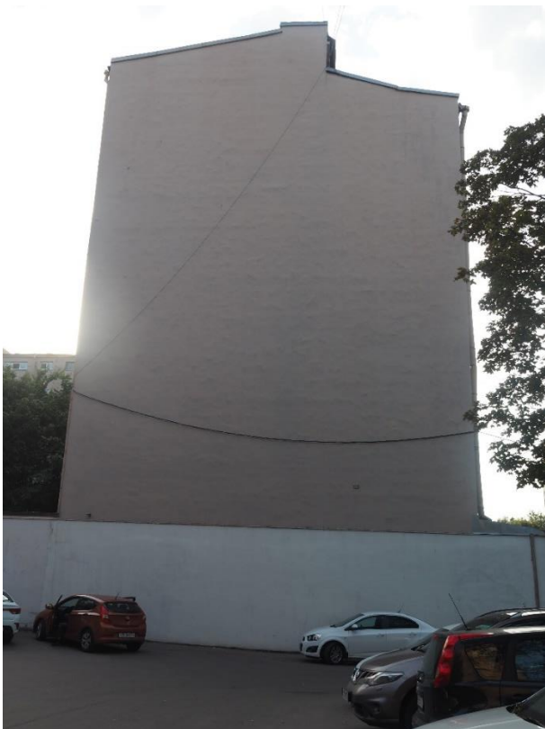
2. «Жилой дом с магазинами акционерного общества «Илвес», Ленинградская область, Выборгский район, г. Выборг, Ленинградское шоссе, д.11. Северо-восточный фасад. Общий вид. Фото 20.08.2022г.
