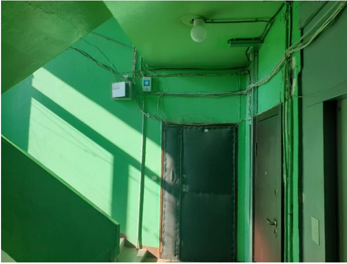
30. «Жилой дом с магазинами акционерного общества «Илвес», Ленинградская область, Выборгский район, г. Выборг, Ленинградское шоссе, д.11. Подъезд №4. Фрагмент. Фото 20.08.2022г.
