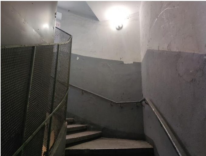
16. «Жилой дом», Ленинградская область, Выборгский район, г. Выборг, ул. Северная, д.10. Подъезд №2. Фрагмент. Фото 20.08.2022г.
