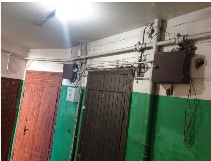
8. «Жилой дом», Ленинградская область, Выборгский район, г. Выборг, ул. Северная, д.10. Подъезд №1. Фрагмент. Фото 20.08.2022г.
