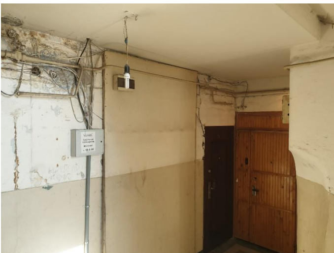
29. «Жилой дом», Ленинградская область, Выборгский район, г. Выборг, ул. Северная, д.10. Подъезд №3. Фрагмент. Фото 20.08.2022г.
