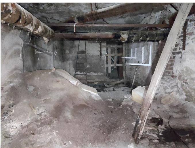
43. «Жилой дом», Ленинградская область, Выборгский район, г. Выборг, ул. Северная, д.10. Подвал. Фрагмент. Фото 20.08.2022г.
