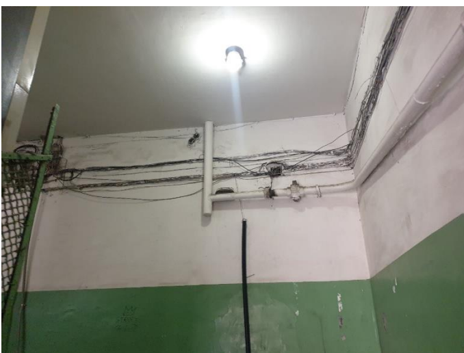
5. «Жилой дом», Ленинградская область, Выборгский район, г. Выборг, ул. Северная, д.10. Подъезд №1. Фрагмент. Фото 20.08.2022г.
