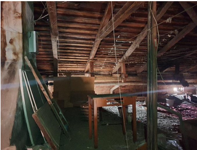
21. «Жилой дом В. Жаворонкова», Ленинградская область, Выборгский район, г. Выборг, ул. Крепостная, д.5а. Чердак. Фрагмент. Фото 20.08.2022г.
