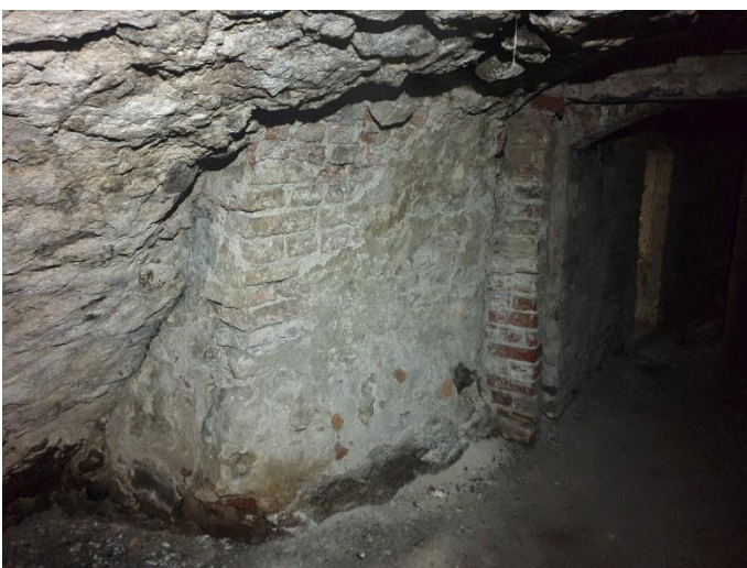
26. «Жилой дом Теслевых», Ленинградская область, Выборгский район, г. Выборг, ул. Прогонная, д.14. Подвал. Фрагмент. Фото 20.08.2022г.
