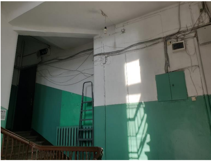
12. «Жилой дом Теслевых», Ленинградская область, Выборгский район, г. Выборг, ул. Прогонная, д.14. Подъезд. Фрагмент. Фото 20.08.2022г.
