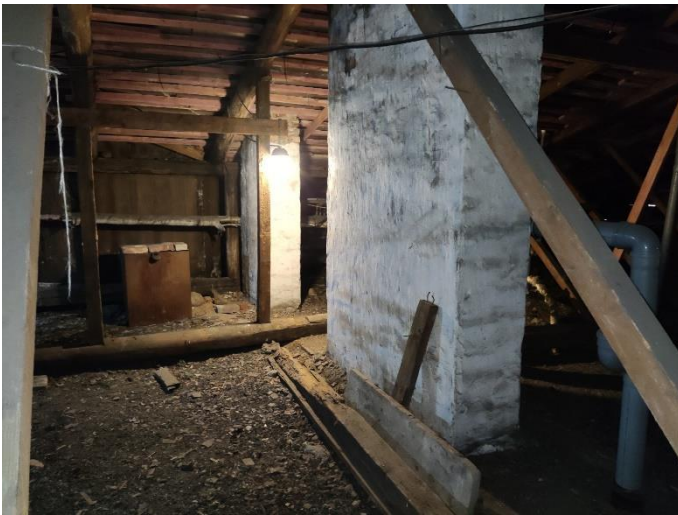
34. «Жилой дом Теслевых», Ленинградская область, Выборгский район, г. Выборг, ул. Прогонная, д.14. Чердак. Фрагмент. Фото 20.08.2022г.
