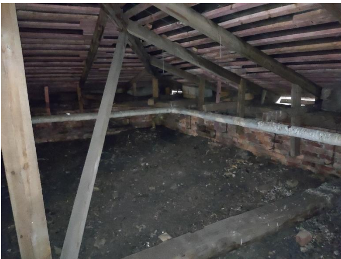
37. «Жилой дом Теслевых», Ленинградская область, Выборгский район, г. Выборг, ул. Прогонная, д.14. Чердак. Фрагмент. Фото 20.08.2022г.
