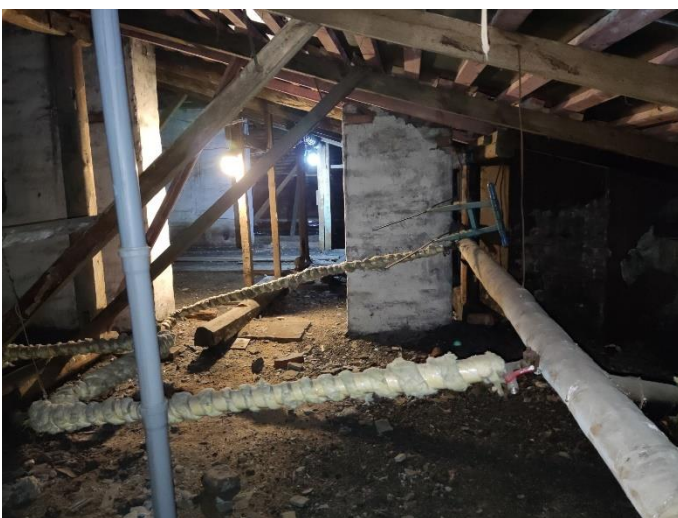
38. «Жилой дом Теслевых», Ленинградская область, Выборгский район, г. Выборг, ул. Прогонная, д.14. Чердак. Фрагмент. Фото 20.08.2022г.
