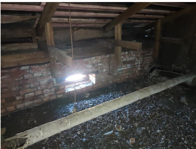
29. «Жилой дом Теслевых», Ленинградская область, Выборгский район, г. Выборг, ул. Прогонная, д.14. Чердак. Фрагмент. Фото 20.08.2022г.
