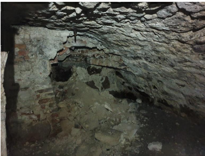
24. «Жилой дом Теслевых», Ленинградская область, Выборгский район, г. Выборг, ул. Прогонная, д.14. Подвал. Фрагмент. Фото 20.08.2022г.
