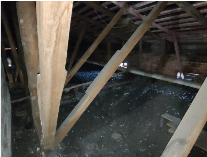
30. «Жилой дом Теслевых», Ленинградская область, Выборгский район, г. Выборг, ул. Прогонная, д.14. Чердак. Фрагмент. Фото 20.08.2022г.
