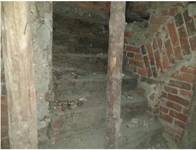
21. «Жилой дом Теслевых», Ленинградская область, Выборгский район, г. Выборг, ул. Прогонная, д.14. Подвал. Фрагмент. Фото 20.08.2022г.
