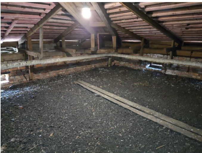
35. «Жилой дом Теслевых», Ленинградская область, Выборгский район, г. Выборг, ул. Прогонная, д.14. Чердак. Фрагмент. Фото 20.08.2022г.
