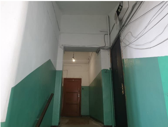
13. «Жилой дом Теслевых», Ленинградская область, Выборгский район, г. Выборг, ул. Прогонная, д.14. Подъезд. Фрагмент. Фото 20.08.2022г.
