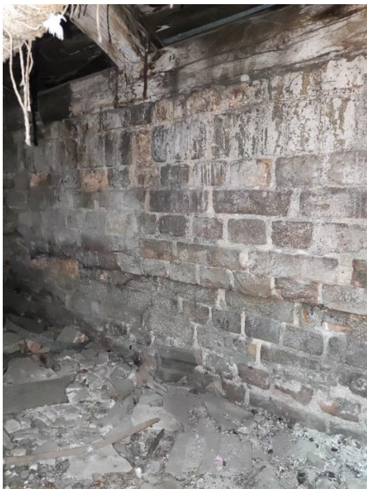
33. «Жилой дом», Ленинградская область, Выборгский район, г. Выборг, ул. Майорова д.2. Чердак. Фрагмент. Фото 20.08.2022г.
