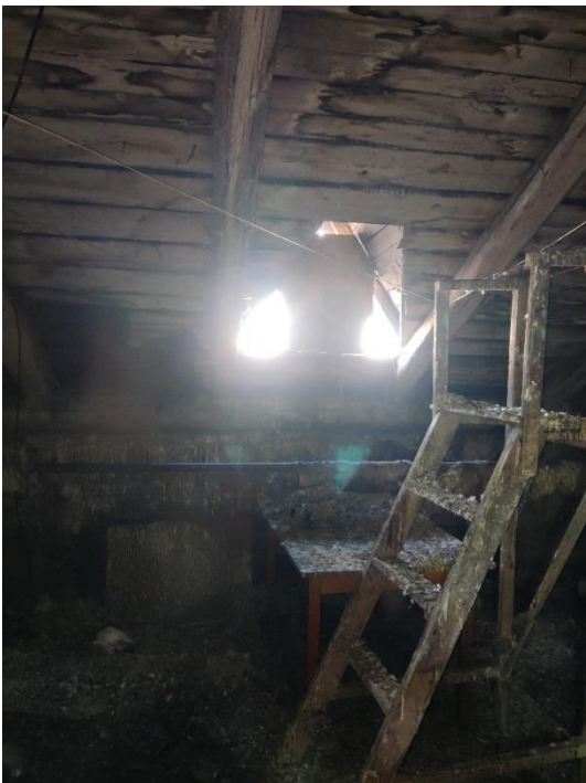
36. «Жилой дом», Ленинградская область, Выборгский район, г. Выборг, ул. Майорова д.2. Чердак. Фрагмент. Фото 20.08.2022г.
