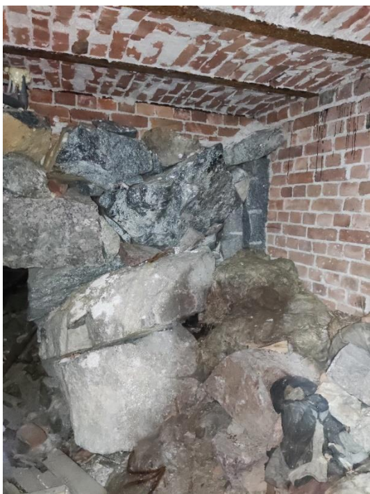
27. «Жилой дом», Ленинградская область, Выборгский район, г. Выборг, ул. Майорова д.2. Подвал. Фрагмент. Фото 20.08.2022г.
