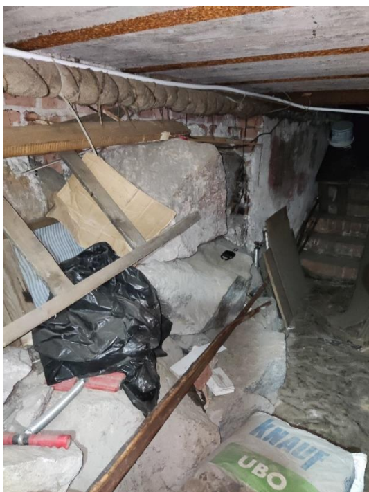
26. «Жилой дом», Ленинградская область, Выборгский район, г. Выборг, ул. Майорова д.2. Подвал. Фрагмент. Фото 20.08.2022г.
