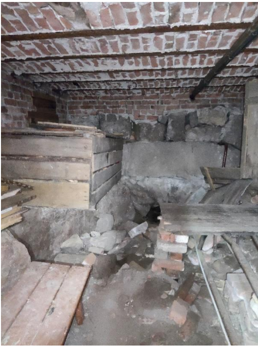
31. «Жилой дом», Ленинградская область, Выборгский район, г. Выборг, ул. Майорова д.2. Подвал. Фрагмент. Фото 20.08.2022г.
