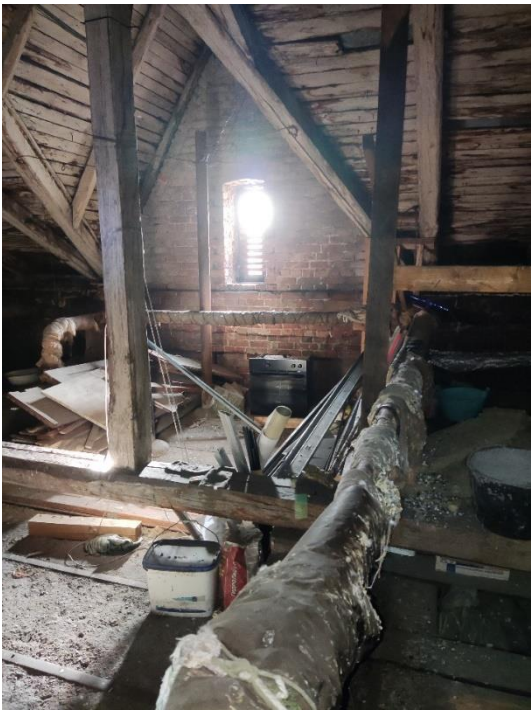
35. «Жилой дом», Ленинградская область, Выборгский район, г. Выборг, ул. Майорова д.2. Чердак. Фрагмент. Фото 20.08.2022г.
