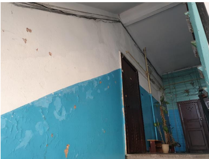
17. «Жилой дом», Ленинградская область, Выборгский район, г. Выборг, ул. Майорова д.2. Подъезд №2. Фрагмент. Фото 20.08.2022г.
