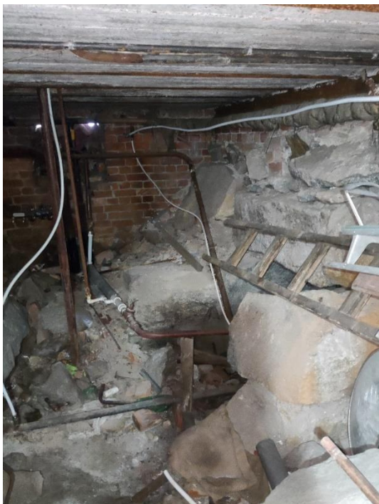
25. «Жилой дом», Ленинградская область, Выборгский район, г. Выборг, ул. Майорова д.2. Подвал. Фрагмент. Фото 20.08.2022г.
