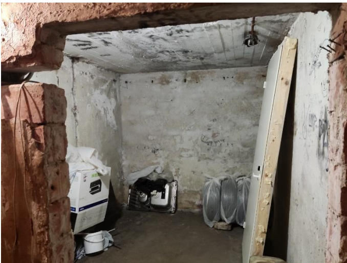
31. «Жилой дом акционерного общества Пампала», Ленинградская область, Выборгский район, г. Выборг, ул. Южный вал, д.18. Подвал. Фрагмент. Фото 20.08.2022г.
