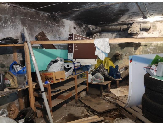
40. «Жилой дом акционерного общества Пампала», Ленинградская область, Выборгский район, г. Выборг, ул. Южный вал, д.18. Подвал. Фрагмент. Фото 20.08.2022г.
