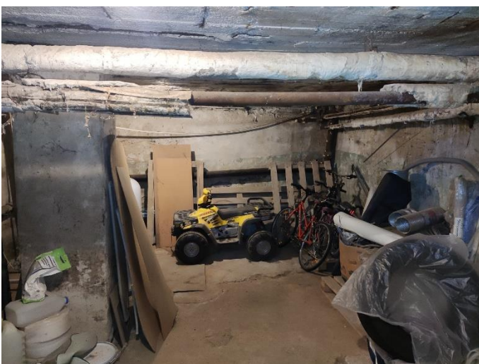
43. «Жилой дом акционерного общества Пампала», Ленинградская область, Выборгский район, г. Выборг, ул. Южный вал, д.18. Подвал. Фрагмент. Фото 20.08.2022г.
