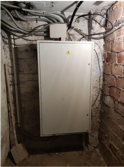
30. «Жилой дом акционерного общества Пампала», Ленинградская область, Выборгский район, г. Выборг, ул. Южный вал, д.18. Подвал. Фрагмент. Фото 20.08.2022г.
