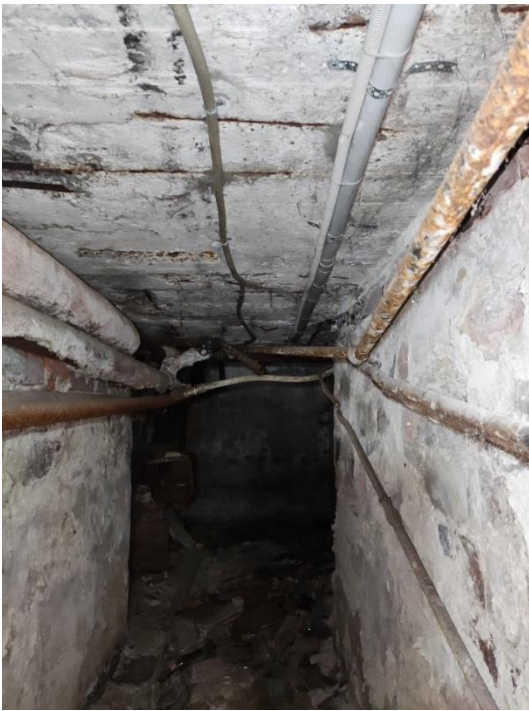
37. «Жилой дом акционерного общества Пампала», Ленинградская область, Выборгский район, г. Выборг, ул. Южный вал, д.18. Подвал. Фрагмент. Фото 20.08.2022г.
