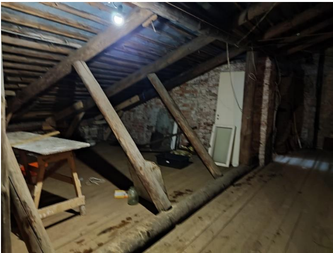
44. «Жилой дом акционерного общества Пампала», Ленинградская область, Выборгский район, г. Выборг, ул. Южный вал, д.18. Чердак. Общий вид. Фото 20.08.2022г.
