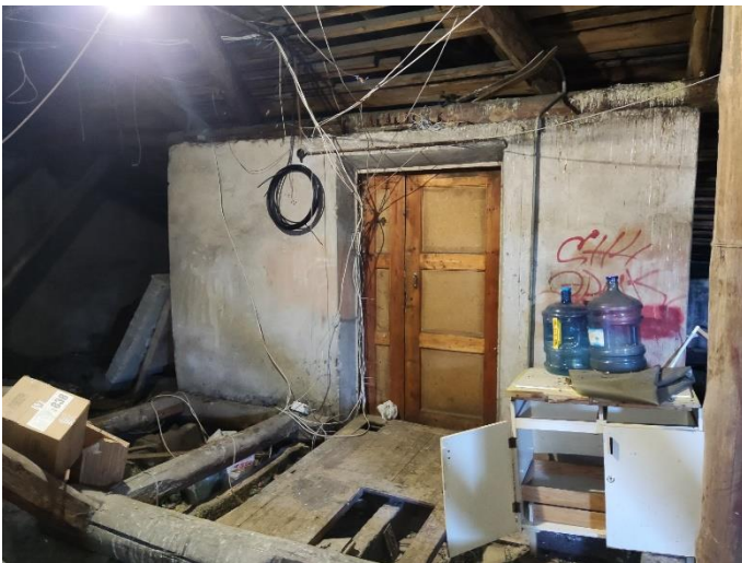
51. «Жилой дом акционерного общества Пампала», Ленинградская область, Выборгский район, г. Выборг, ул. Южный вал, д.18. Чердак. Фрагмент. Фото 20.08.2022г.
