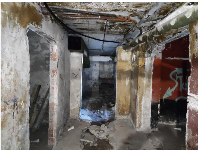
33. «Жилой дом акционерного общества Пампала», Ленинградская область, Выборгский район, г. Выборг, ул. Южный вал, д.18. Подвал. Фрагмент. Фото 20.08.2022г.
