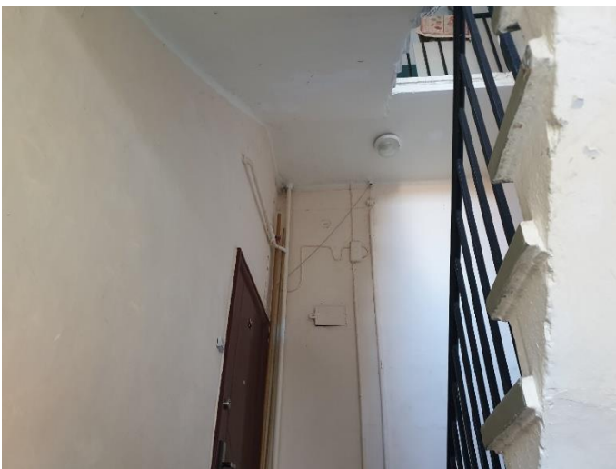
20. «Жилой дом акционерного общества Пампала», Ленинградская область, Выборгский район, г. Выборг, ул. Южный вал, д.18. Подъезд №3. Фрагмент. Фото 20.08.2022г.
