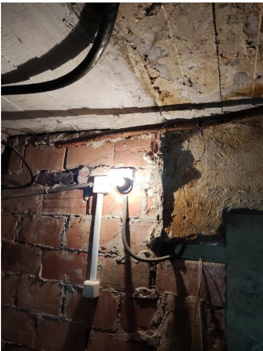
36. «Жилой дом акционерного общества Пампала», Ленинградская область, Выборгский район, г. Выборг, ул. Южный вал, д.18. Подвал. Фрагмент. Фото 20.08.2022г.
