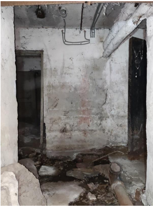
39. «Жилой дом акционерного общества Пампала», Ленинградская область, Выборгский район, г. Выборг, ул. Южный вал, д.18. Подвал. Фрагмент. Фото 20.08.2022г.
