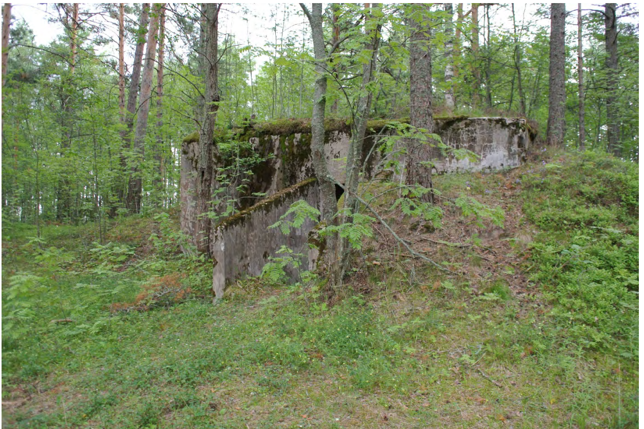
ФОТО 36. Защищенная силовая станция. Вид с юго-западной стороны.
