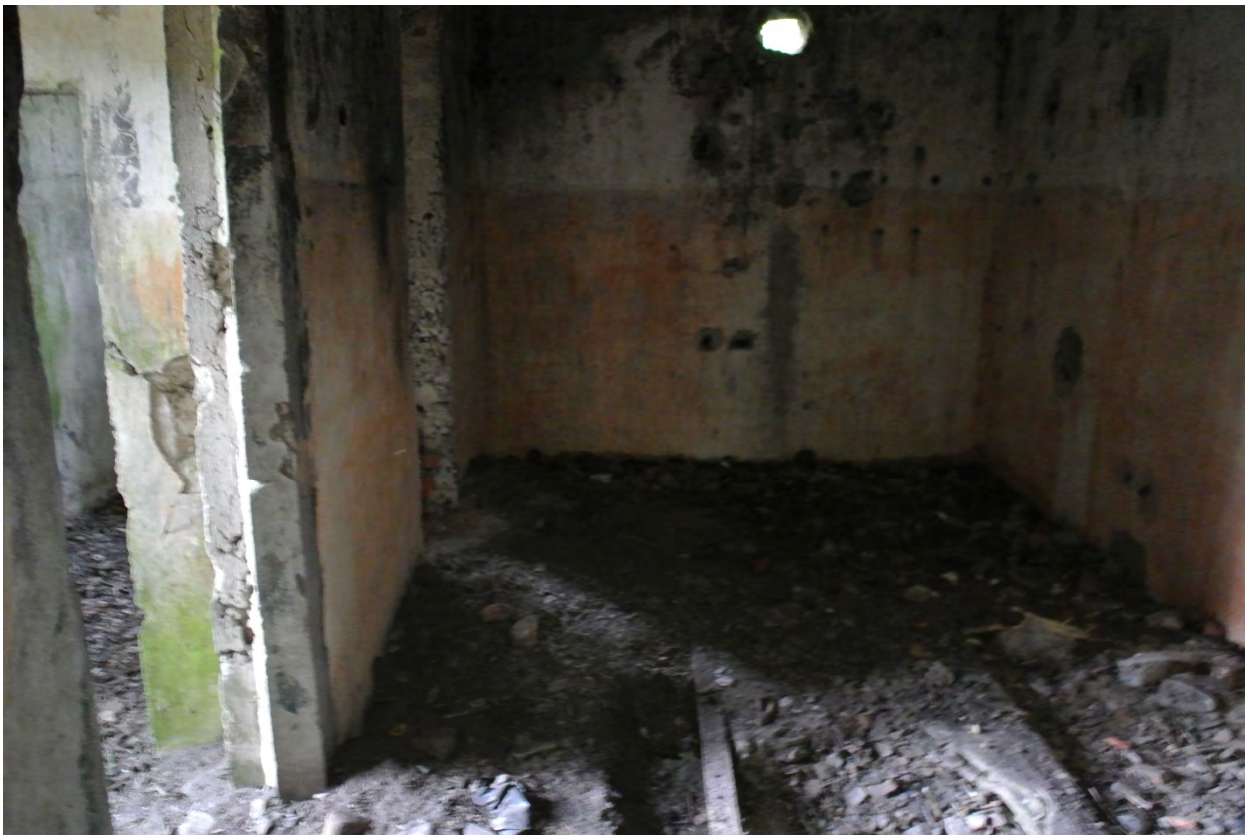
ФОТО 40. Защищенная силовая станция. Интерьер. Вид в северном направлении.
