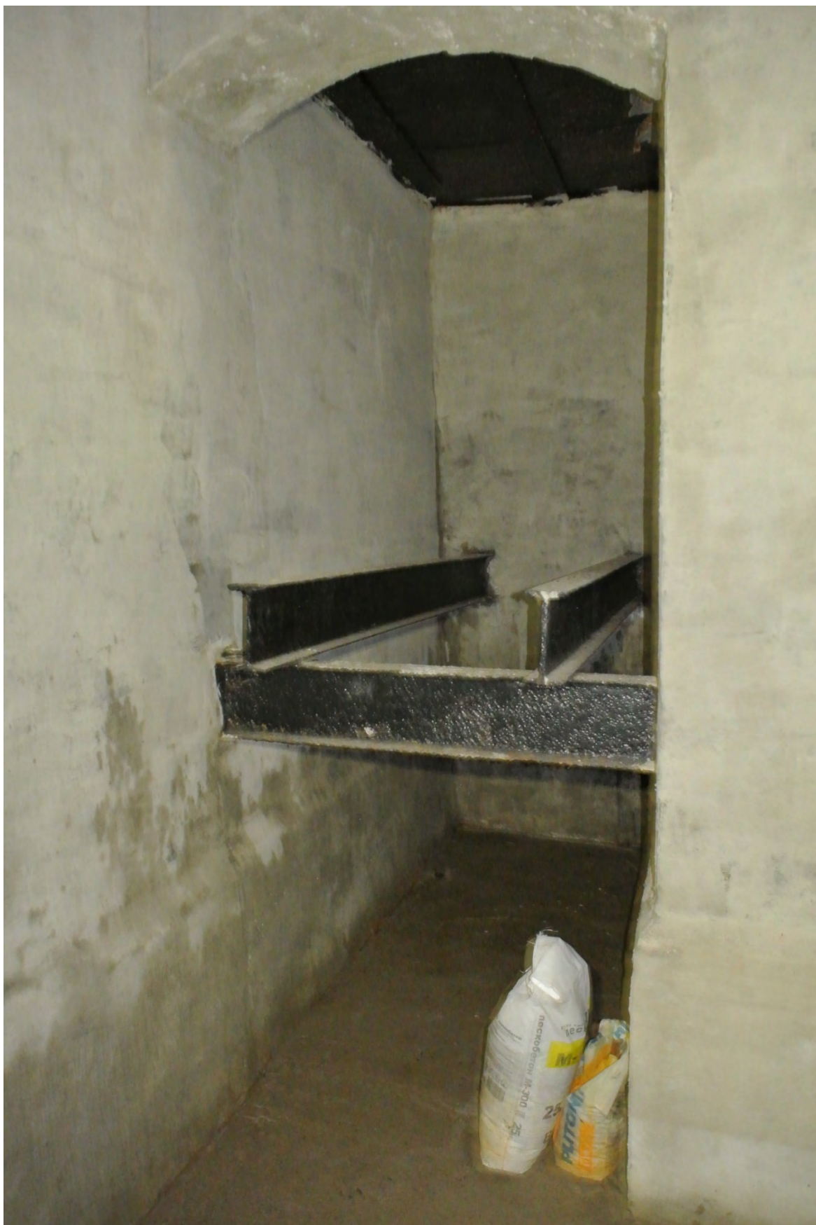
ФОТО 6. Котельная за орудийными позициями. Интерьер. Рама из металлических двутавров в юго-восточном углу помещения.
