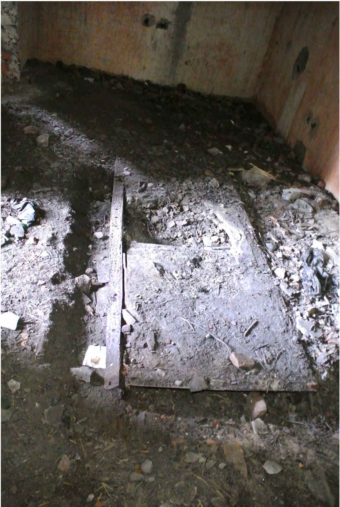
ФОТО 42. Защищенная силовая станция. Интерьер. Металлический фундамент, на котором были установлены динамо-машина и двигатель для обслуживания прожектора.
