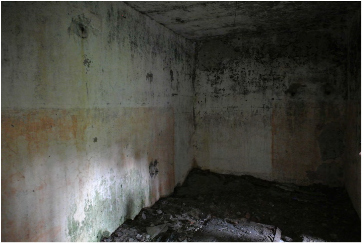
ФОТО 41. Защищенная силовая станция. Интерьер. Вид в южном направлении.
