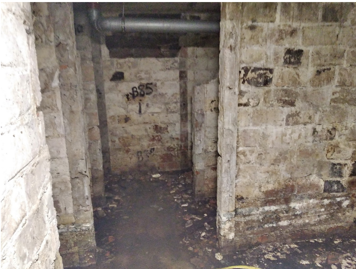
38 ОКН регионального значения “Жилой дом со службами К. Клоуберга” Ленинградская область, Выборгский муниципальный район, г. Выборг, ул. Сторожевой башни, д. 18. Подвал № 3. Помещение 1. Дата съемки: 02.05.2022 г.
