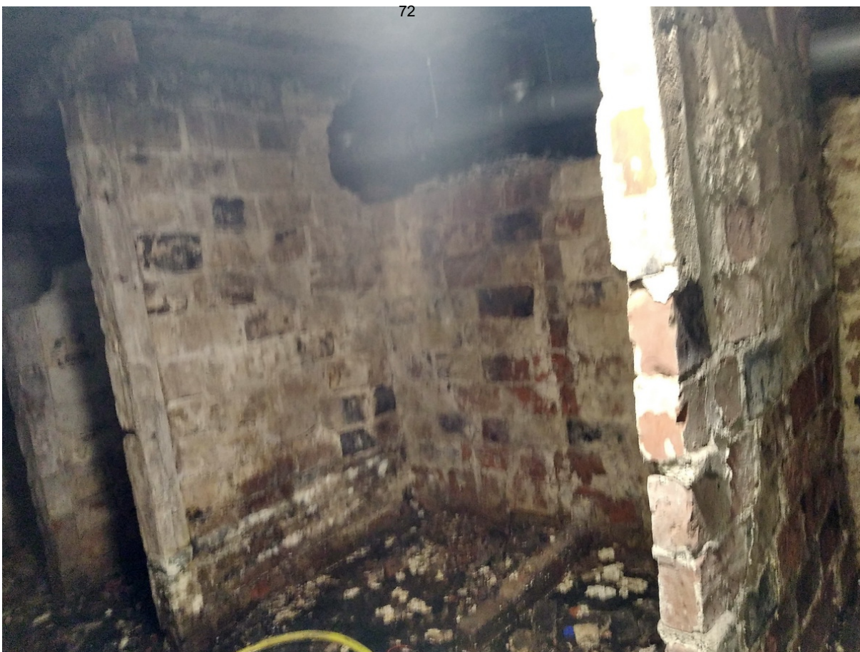
37 ОКН регионального значения “Жилой дом со службами К. Клоуберга” Ленинградская область, Выборгский муниципальный район, г. Выборг, ул. Сторожевой башни, д. 18. Подвал № 3. Вид из помещения 1 на помещение 9. Дата съемки: 01.05.2022 г
