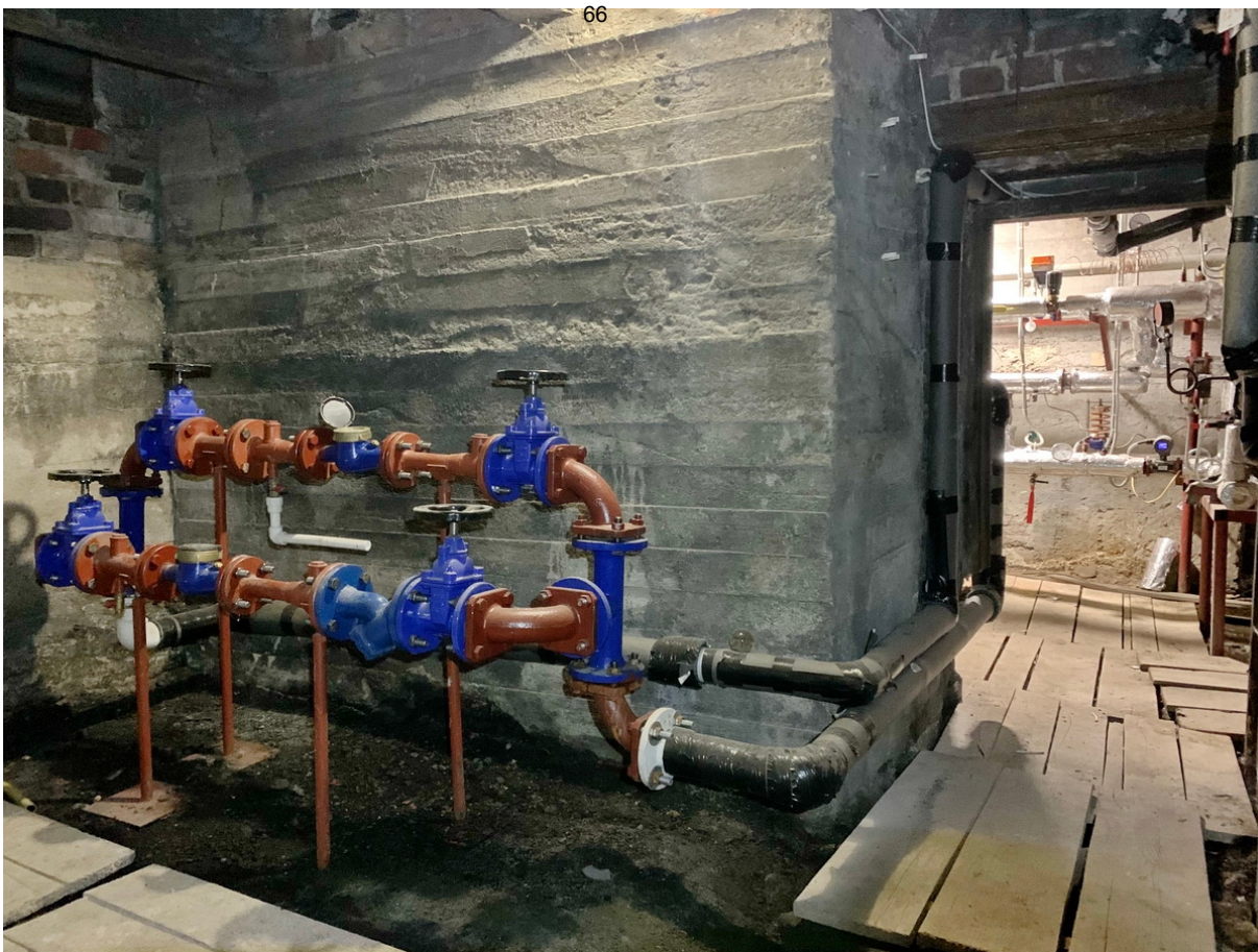
25 ОКН регионального значения “Жилой дом со службами К. Клоуберга” Ленинградская область, Выборгский муниципальный район, г. Выборг, ул. Сторожевой башни, д. 18. Подвал № 1. Помещение 11. Дата съемки: 01.05.2022 г
