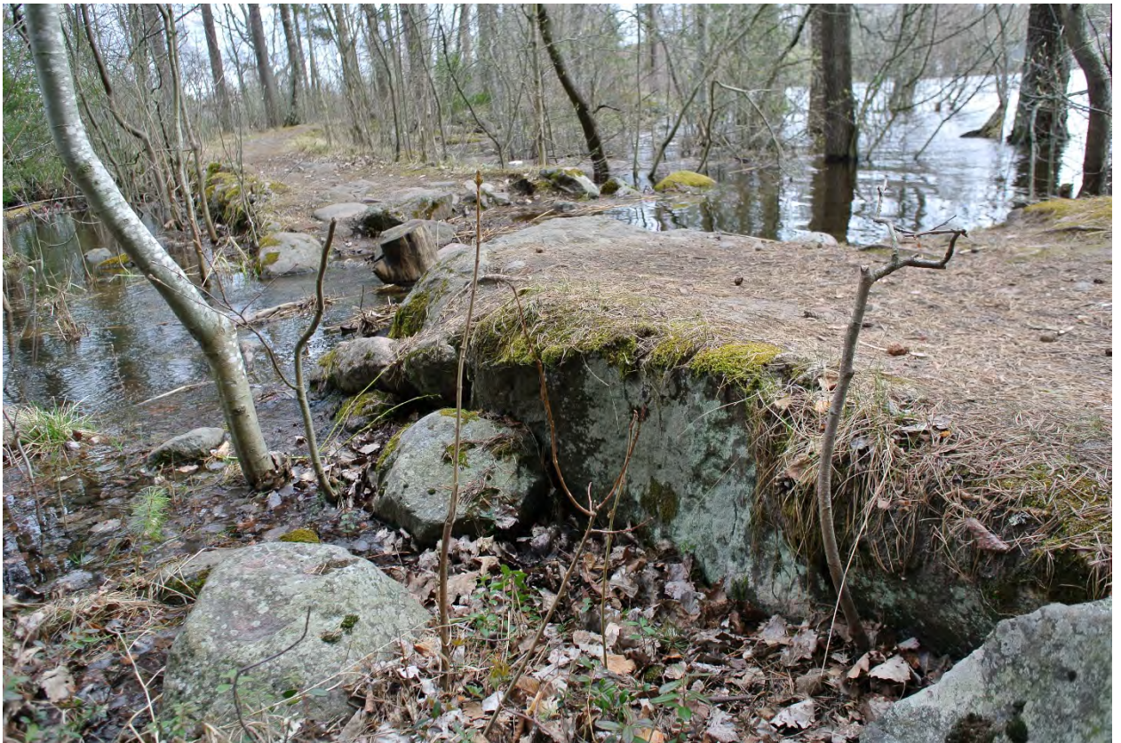
ФОТО 43. Вид в юго-восточном направлении на конструкцию дорожки-дамбы у разрушенного мостика. Дата съемки: 04.05.2022 г.
