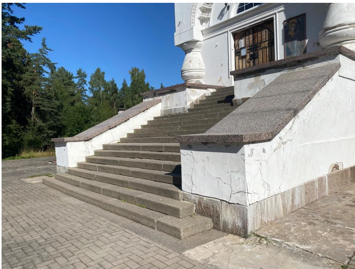
Фото 2. Состояние паперти с крыльцом
