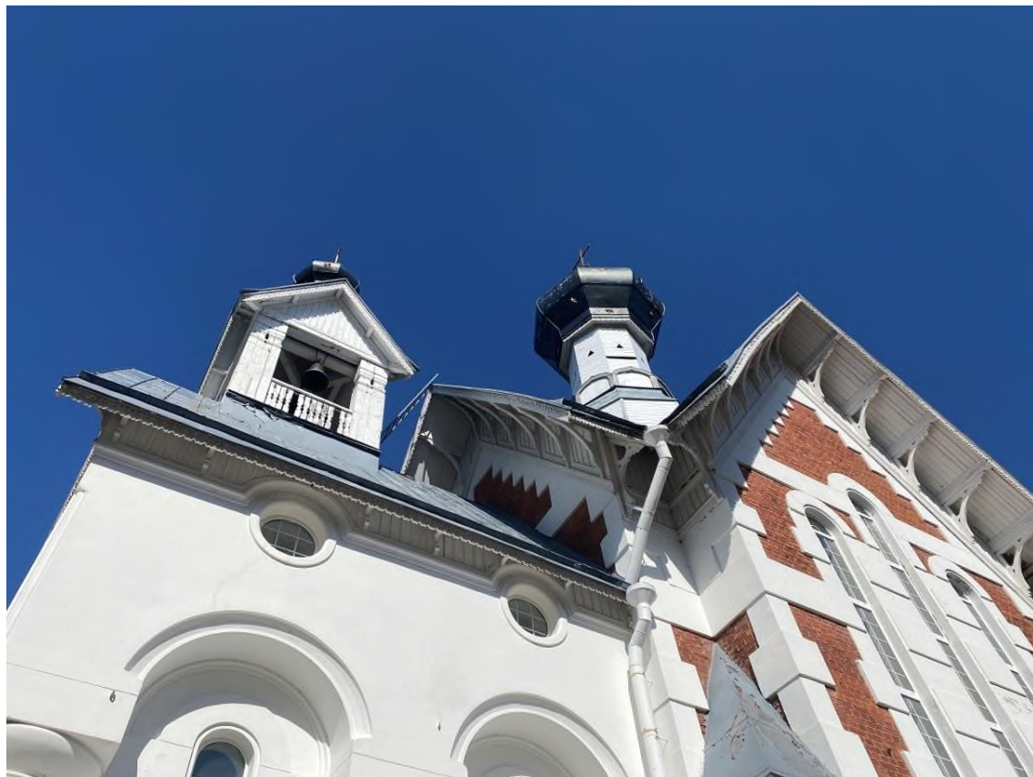
Фото 3. Утраты деревянных элементов здания
