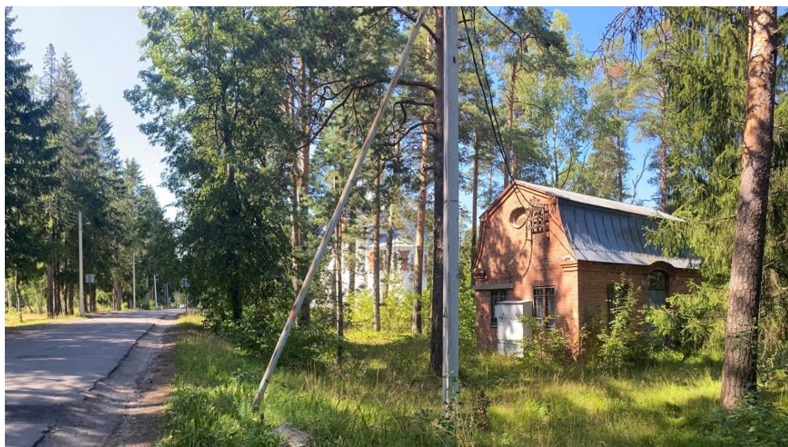
Фото 8. Прозекторская (трансформаторная подстанция), существующая ВЛИ-0,4 кВ от ТП 79 вдоль ул. Александра Невского п. Сосновый Бор
