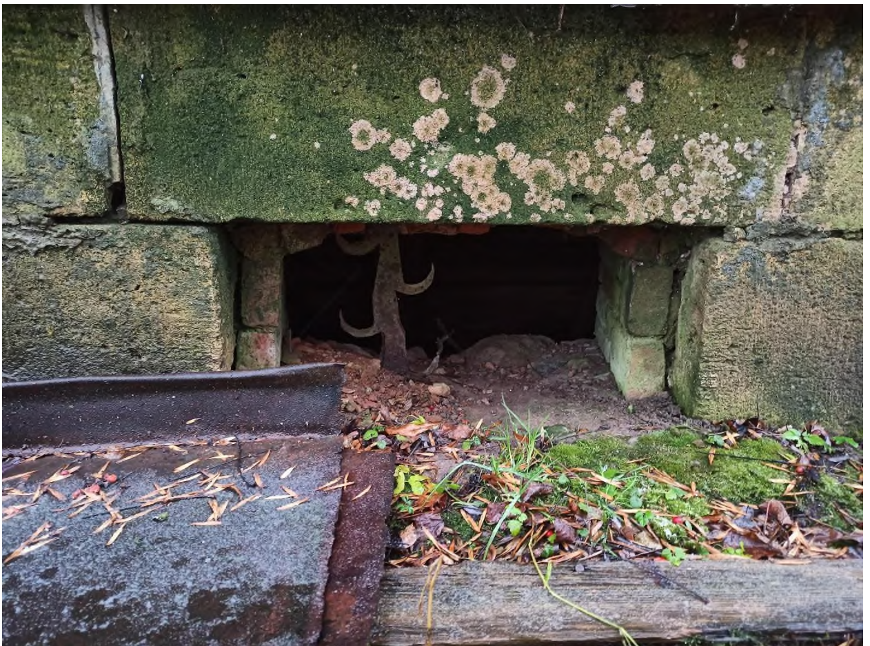
58. Жилой (деревянный) дом. Деталь западного фасада - кованые решетки из металлической полосы в окне полуподвала
