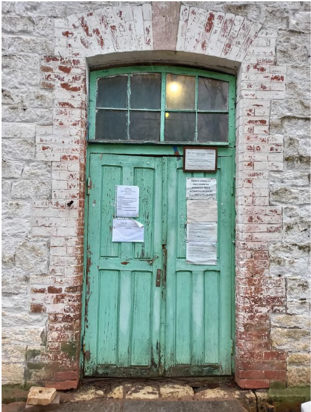
80. Каменная дача (административное здание). Фрагмент западного фасада. Входная дверь с остекленной фрамугой.
