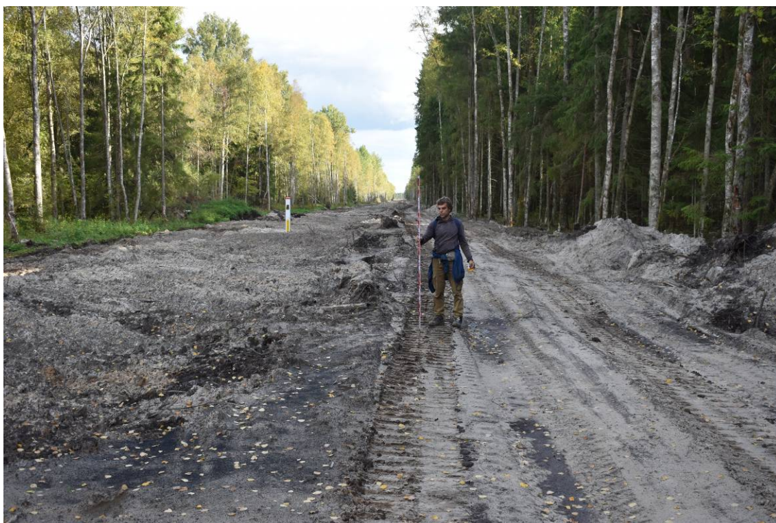
Рис. 132. Участок объекта обследования между д. Извоз и д. Кейкино (ТФ 24). Вид с юго-востока
