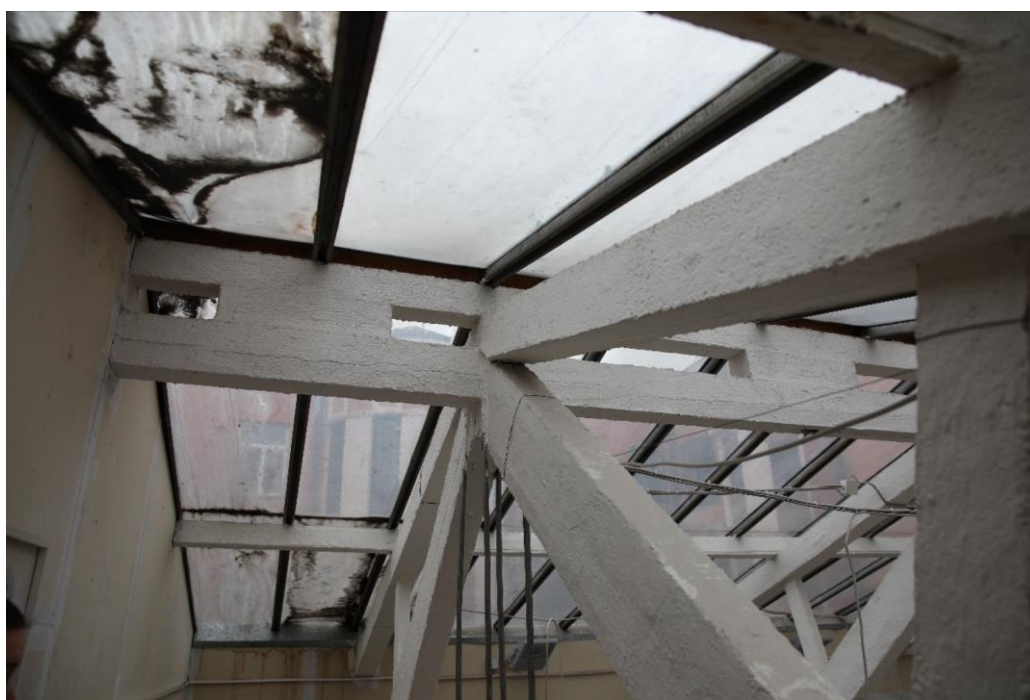
15. Объект культурного наследия регионального значения «Жилой и торговый дом «Карьяла» по адресу: Ленинградская область, Выборгский район, город Выборг, проспект Ленина, д.12/10. Конструкции кровли и светового фонаря над витражом.
