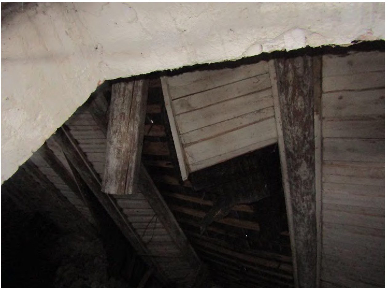
145. Фрагмент конструкции перекрытий скотного двора. Обрушение части перекрытия с левой стороны
