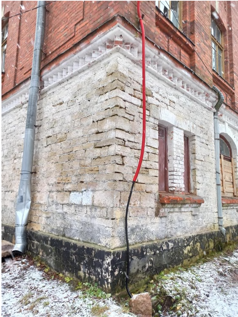
3. Фрагмент фасада здания сельскохозяйственного (земского) училища. Кладка и декоративная отделка фасада на уровне 1-го этажа
