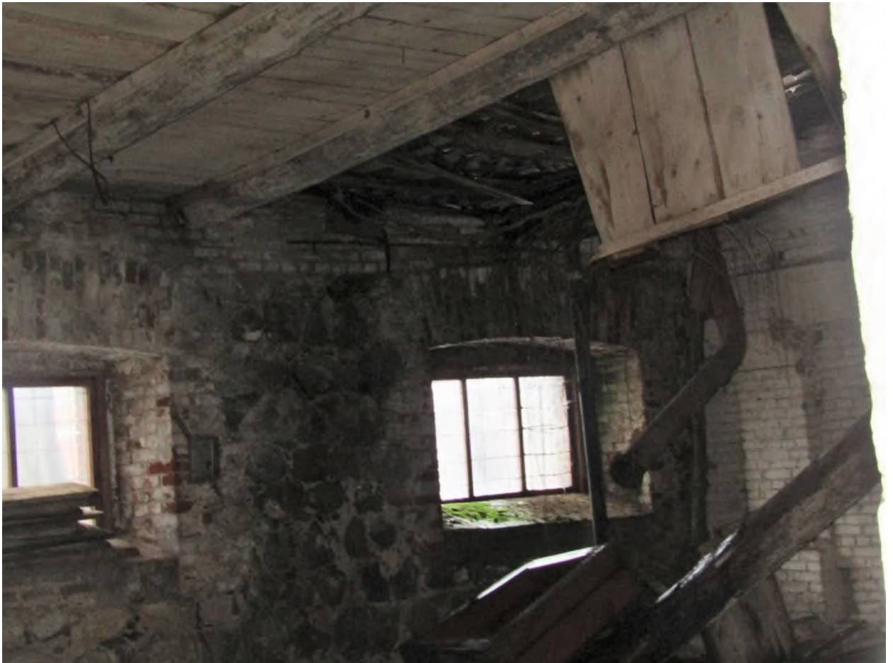
144. Фрагмент стен и конструкции перекрытий скотного двора. Обрушение части перекрытия с правой стороны
