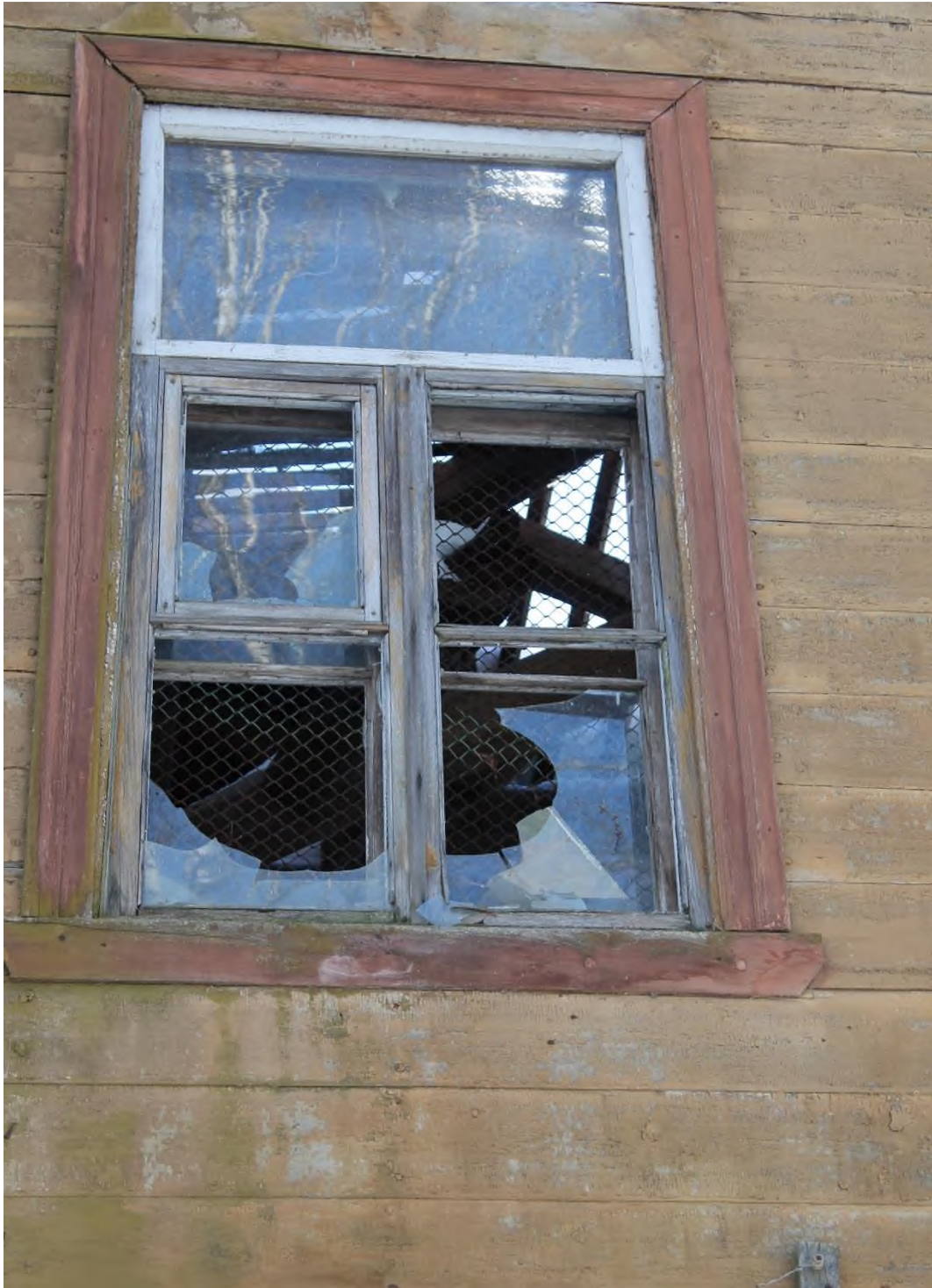
57. Жилой (деревянный) дом. Фрагмент северного фасада. Обрушение несущих конструкций чердачного перекрытия и крыши. Фото выполнено через окно 2-го этажа.
