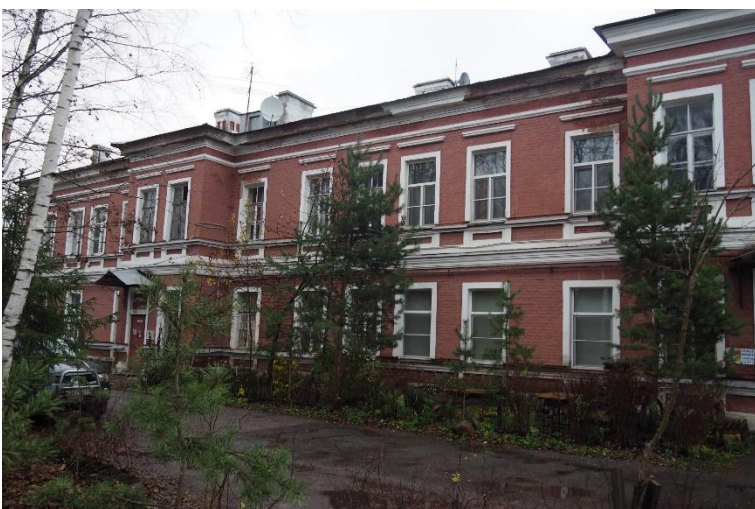
12. «Ансамбль зданий бывших казарм и жилых зданий гвардейского батальона (ранее крепость Ингербург)», Ленинградская обл., Гатчинский р-н, г. Гатчина, ул. Роцинская, д.4. Юго-западный фасад. Фрагмент. Фото 01.11.2022г.
