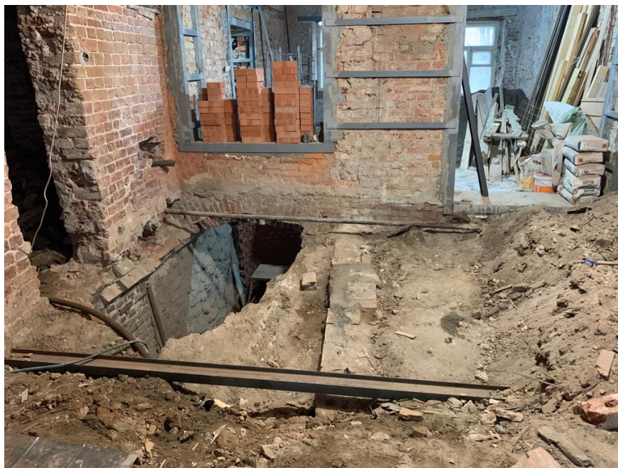
Фото 8. Фрагмент частично разрушенного кирпичного свода помещения прохода к лестнице Л-1. Вид из пом. 1.1. с южной стороны.
