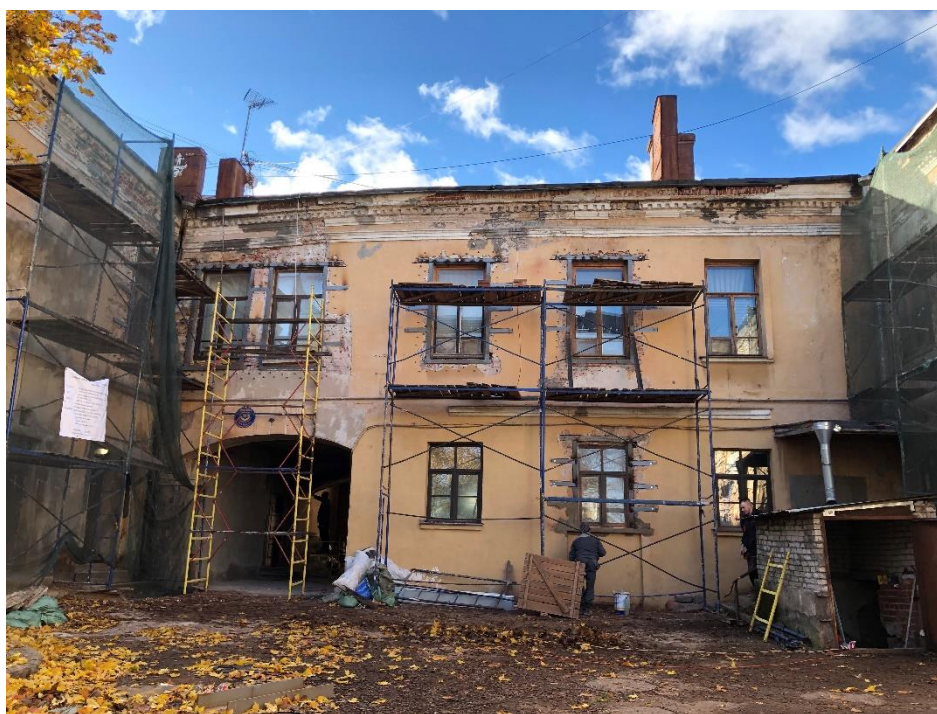
Фото 4. Общий вид С-В дворового фасада здания (октябрь 2022 г. в процессе выполнения противоаварийных мероприятий по фасадам здания)
