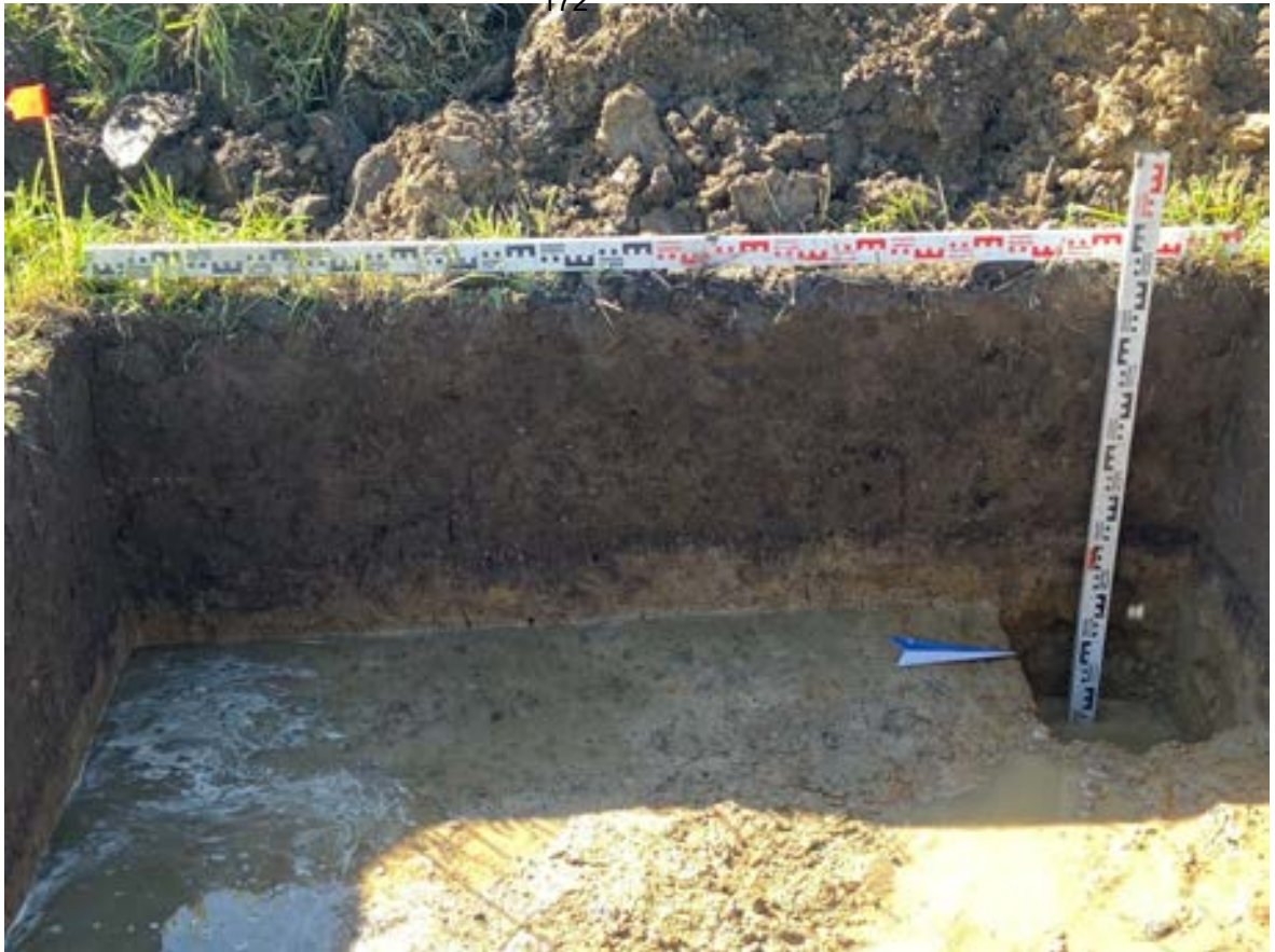
Рис. 146. ЛО-2022, Всеволожский муниципальный район, Свердловское сельское поселение, дер. Новосаратовка, земельный участок с кадастровым номером 47:07:0605001:455. Шурф 15. Контрольный прокоп. Вид с востока
