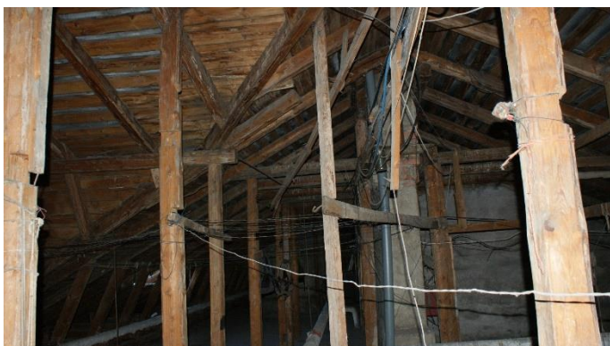
28. «Жилой дом с магазинами акционерного общества «Понтус», Ленинградская обл., Выборгский р-н, г. Выборг, пр. Суворова, д.1. Чердак. Фрагмент. Фото 05.10.2022г.
