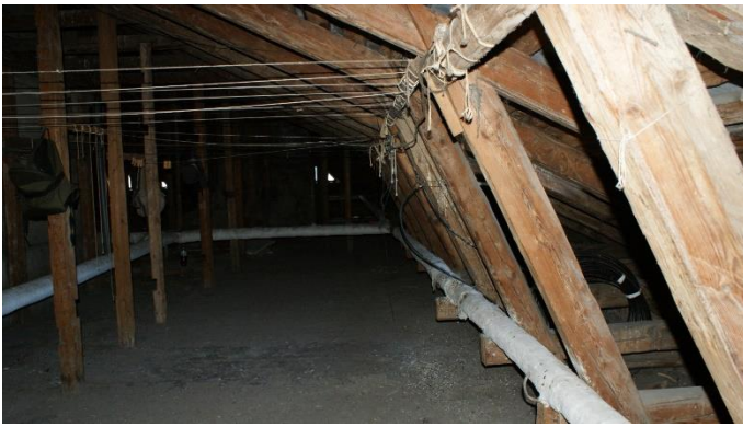
10. «Жилой дом с магазинами акционерного общества «Понтус», Ленинградская обл., Выборгский р-н, г. Выборг, пр. Суворова, д.1. Чердак. Общий вид. Фото 05.10.2022г.
