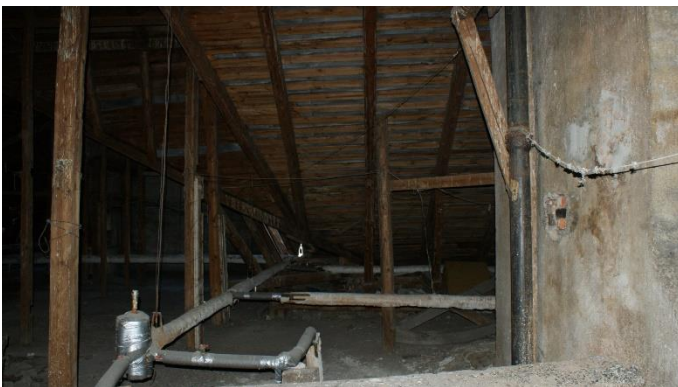
23. «Жилой дом с магазинами акционерного общества «Понтус», Ленинградская обл., Выборгский р-н, г. Выборг, пр. Суворова, д.1. Чердак. Фрагмент. Фото 05.10.2022г.
