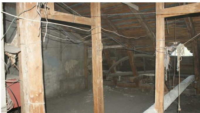
14. «Жилой дом с магазинами акционерного общества «Понтус», Ленинградская обл., Выборгский р-н, г. Выборг, пр. Суворова, д.1. Чердак. Фрагмент. Фото 05.10.2022г.
