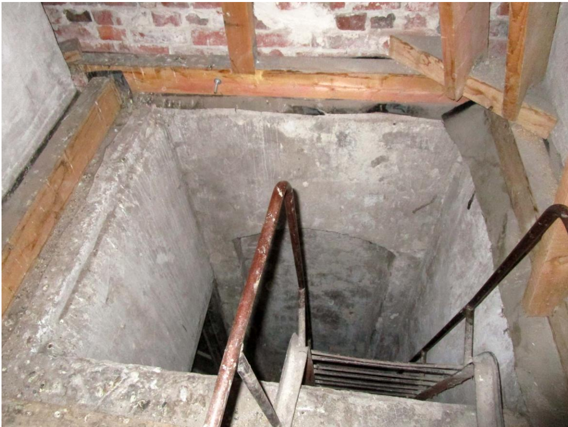
Фото 17. Проем спуска в предмашинное (чердачное) помещение лифта. Автор съемки: Куваева Ю.П. Дата съемки: 27.09.2022 г.
