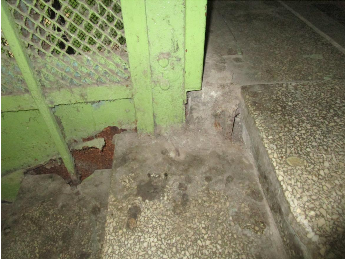
Фото 11. Лифтовая шахта в северной части уличного объема здания. Коррозия металлических элементов каркаса шахты. 3-ий этаж. Автор съемки: Куваева Ю.П. Дата съемки: 27.09.2022 г.
