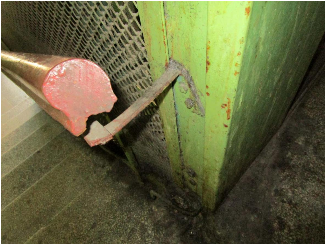
Фото 9. Лифтовая шахта в северной части уличного объема здания. Коррозия металлических элементов каркаса шахты. Автор съемки: Куваева Ю.П. Дата съемки: 27.09.2022 г.
