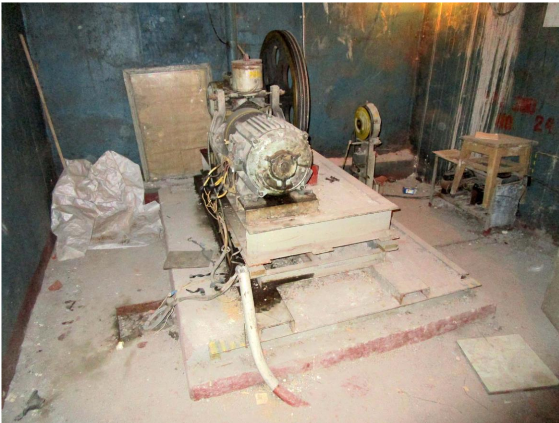
Фото 19. Лифтовая лебедка в машинном отделении лифта. Автор съемки: Куваева Ю.П. Дата съемки: 27.09.2022 г.
