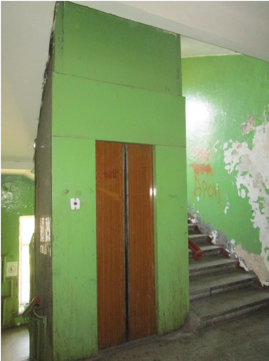
Фото 8. Лифтовая шахта в северной части уличного объема здания. 2-ой этаж. Автор съемки: Куваева Ю.П. Дата съемки: 27.09.2022 г.
