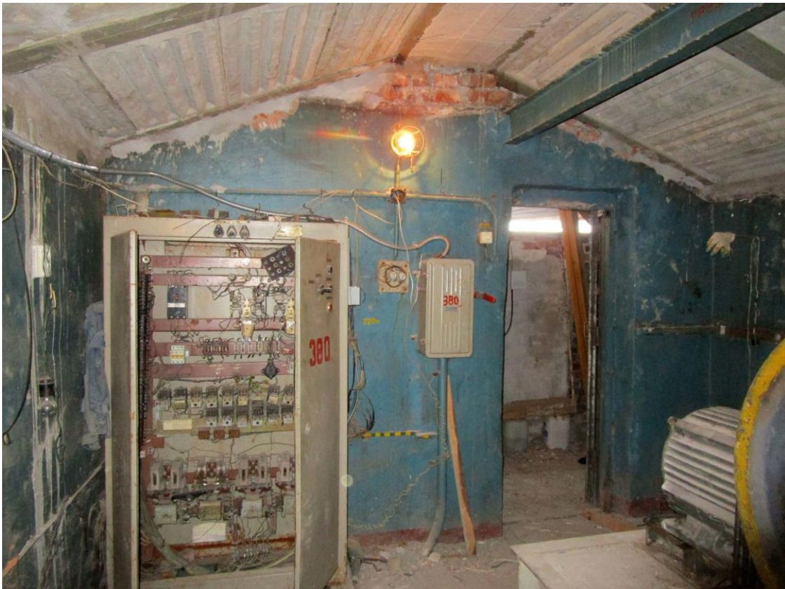
Фото 18. Машинное помещение лифта. Автор съемки: Куваева Ю.П. Дата съемки: 27.09.2022 г.
