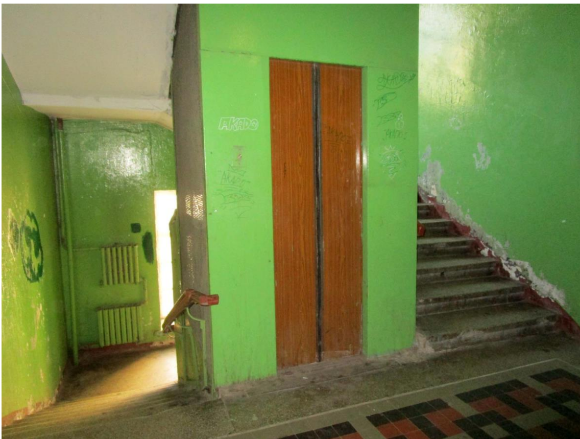
Фото 10. Лифтовая шахта в северной части уличного объема здания. 3-ий этаж. Автор съемки: Куваева Ю.П. Дата съемки: 27.09.2022 г.
