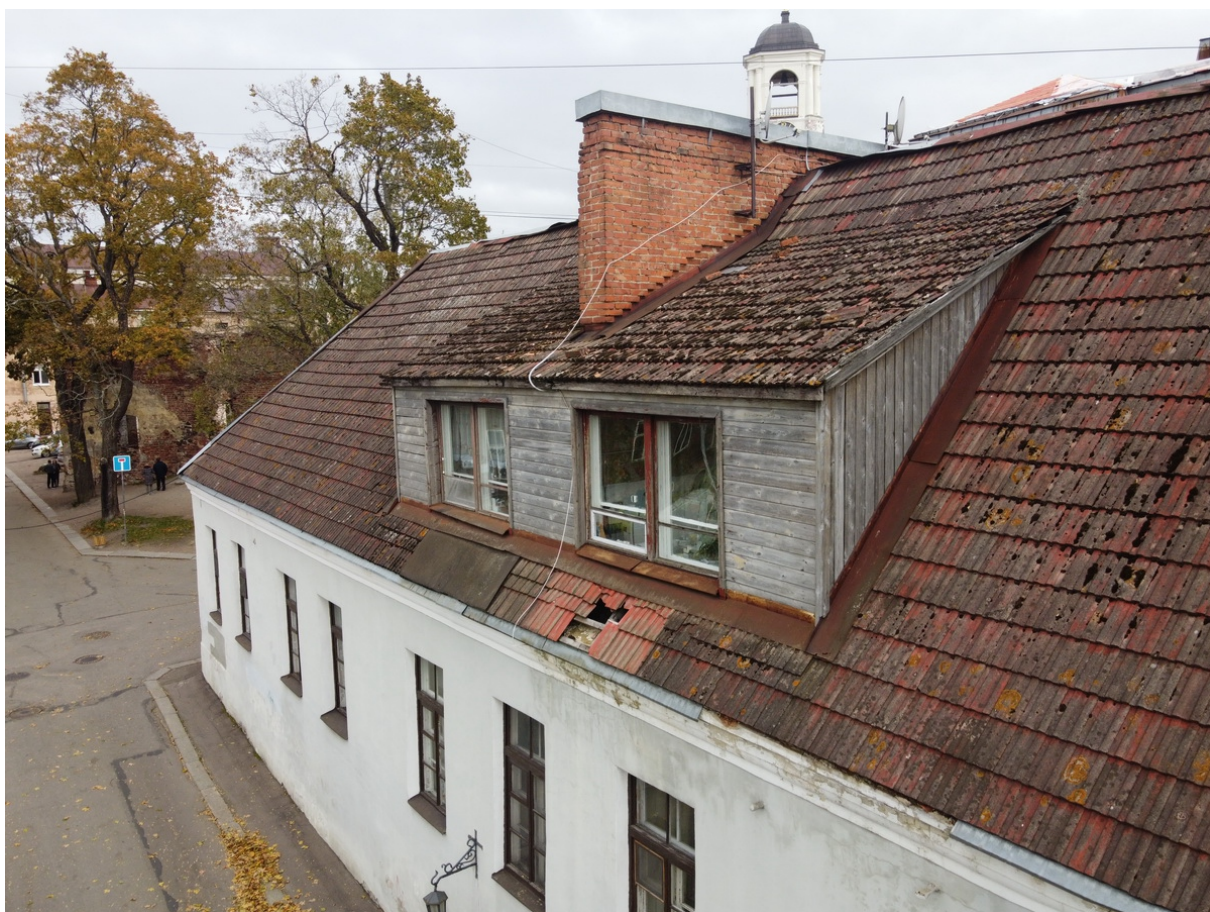
12 ОКН регионального значения “Купеческий дом” ул. Сторожевой башни, д. 3. Вид на северо-восток с квадрокоптера с Подгорной ул. Дата съемки: 13.10.2021 г.
