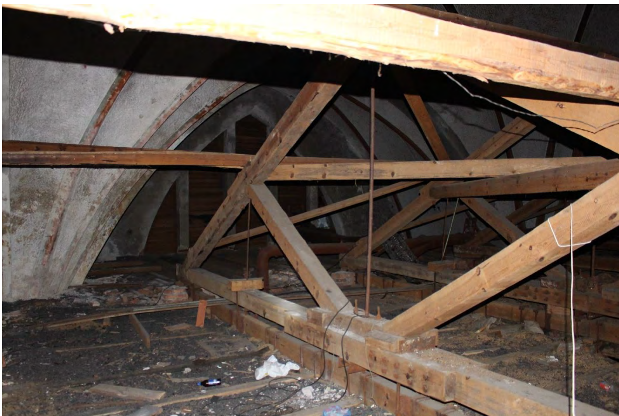
Фото 65. Внутренние помещения объекта культурного наследия регионального значения «Кирха». Технический этаж над зрительным залом.
