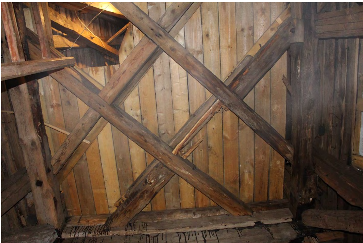
Фото 55. Вид на деревянные конструкции подъема шпиля башни в северо-западной части здания кирхи.
