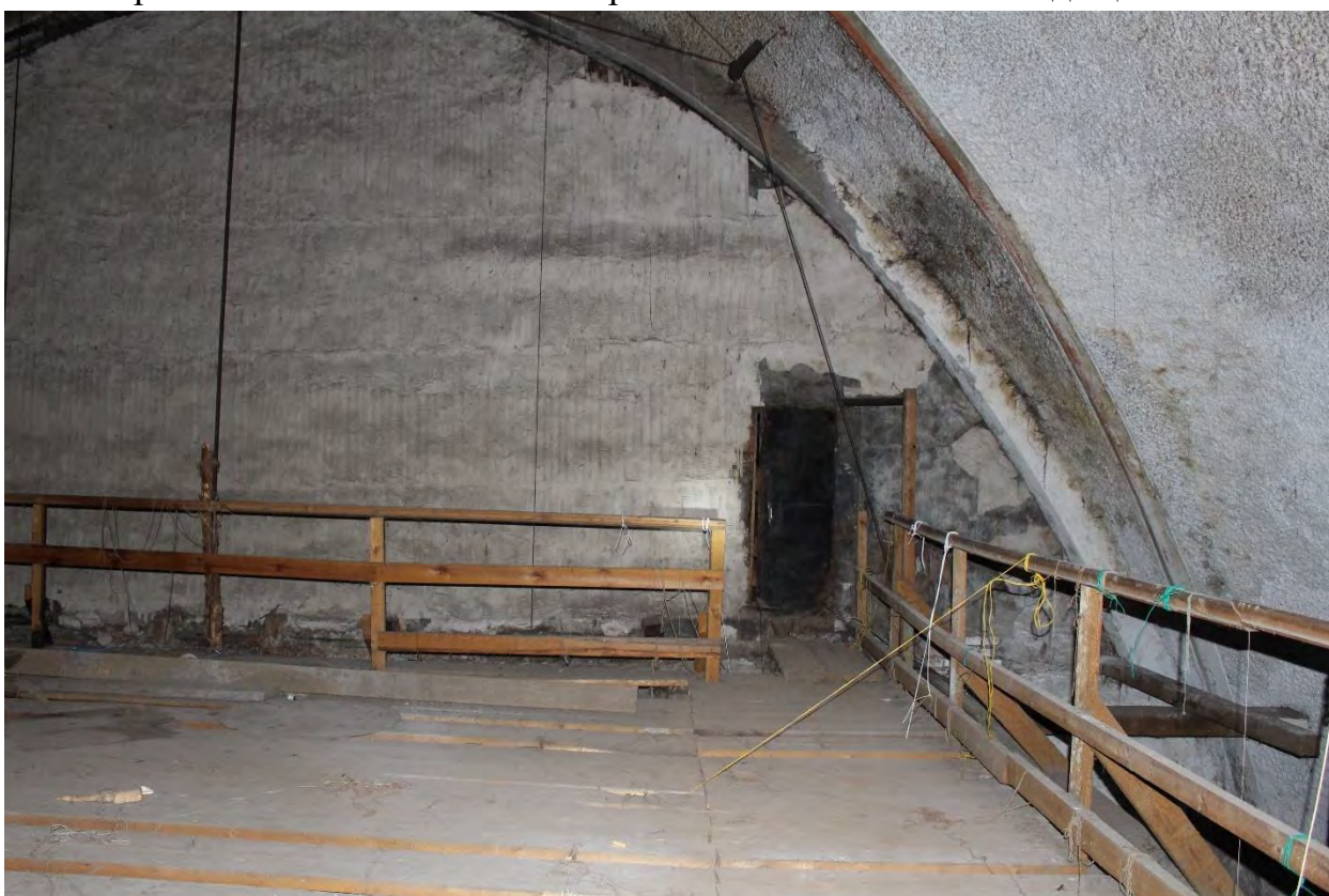
Фото 64. Внутренние помещения объекта культурного наследия регионального значения «Кирха». Технический этаж над сценой.
