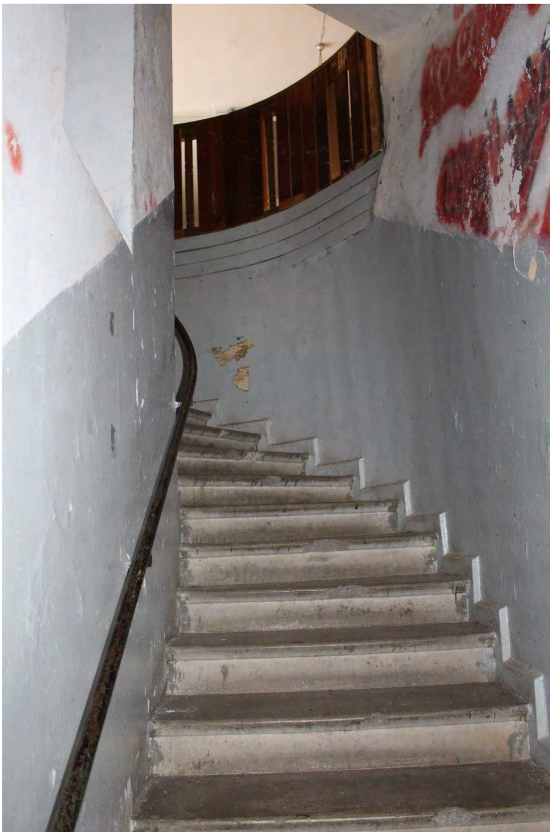
Фото 74. Внутренние помещения объекта культурного наследия регионального значения «Кирха». 1-й этаж, помещение № 1, вид на лестницу, ведущую на 2-й этаж.
