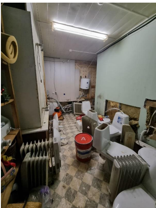
28. «Флигель для гостей», входящий в состав объекта культурного наследия федерального значения «Комплекс усадебных домов и парковых сооружений (бывший парк «Монрепо»», Ленинградская обл., Выборгский р-н, г. Выборг, парк Монрепо. 37Помещение №23. Помещение №8. Бойлерная. Общий вид. Фото 01.02.2023г.
