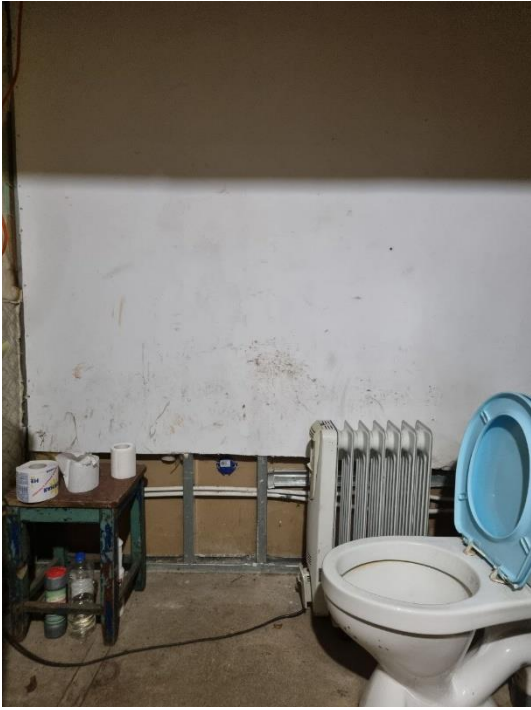
21. «Флигель для гостей», входящий в состав объекта культурного наследия федерального значения «Комплекс усадебных домов и парковых сооружений (бывший парк «Монрепо»», Ленинградская обл., Выборгский р-н, г. Выборг, парк Монрепо. 30 Помещение №10. Совмещенный санузел. Общий вид. Фото 01.02.2023г.
