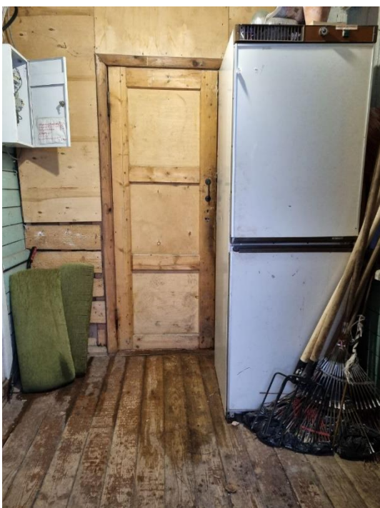
20. «Флигель для гостей», входящий в состав объекта культурного наследия федерального значения «Комплекс усадебных домов и парковых сооружений (бывший парк «Монрепо»», Ленинградская обл., Выборгский р-н, г. Выборг, парк Монрепо. 29 Помещение №11. Общий вид. Фото 01.02.2023г.
