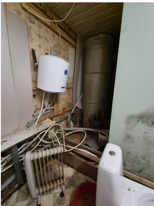
29. «Флигель для гостей», входящий в состав объекта культурного наследия федерального значения «Комплекс усадебных домов и парковых сооружений (бывший парк «Монрепо»», Ленинградская обл., Выборгский р-н, г. Выборг, парк Монрепо. 38 Помещение №23. Помещение №8. Вид на печь. Фото 01.02.2023г.
