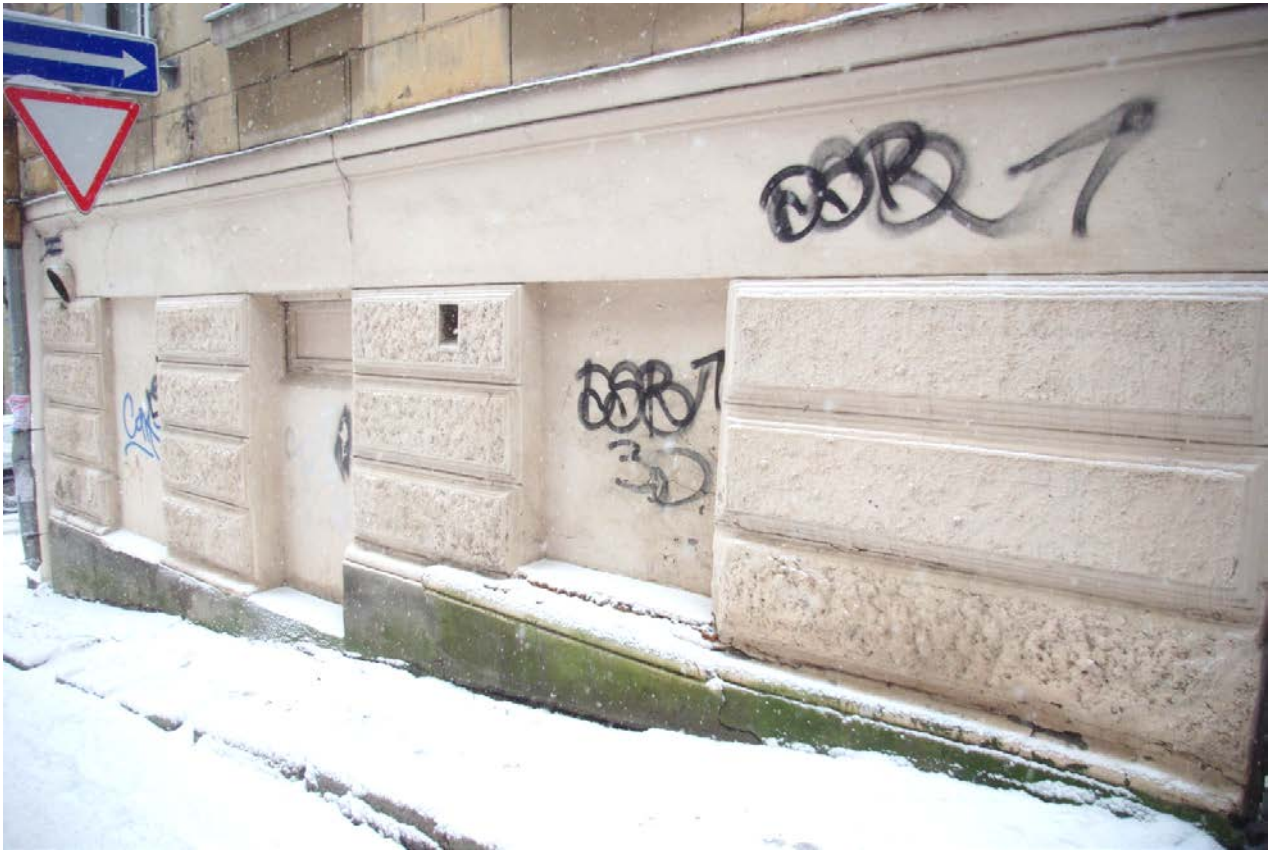
49. 1Ул. Крепостная, 17. Цокольный этаж северо-западного фасада. Фото 2016 г. Акт по результатам государственной историко-культурной экспертизы выявленного объекта культурного наследия «Жилой дом Г. Тата», расположенного по адресу: Ленинградская область, город Выборг, Крепостная улица, дом 17, с целью обоснования включения объекта в Единый государственный реестр объектов культурного наследия (памятников истории и культуры) народов Российской Федерации.
