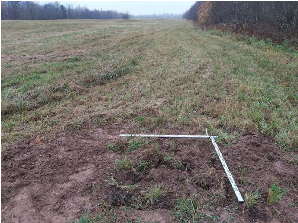
Рис. 47. Межпоселковый газопровод от ГРС Овино – д. Овино – д. Чемихино – д. Сугорово – д. Свирь с отводом на д. Устье и д. Новая Ленинградская область. Шурф 4. Засыпка. Вид с СВ.
