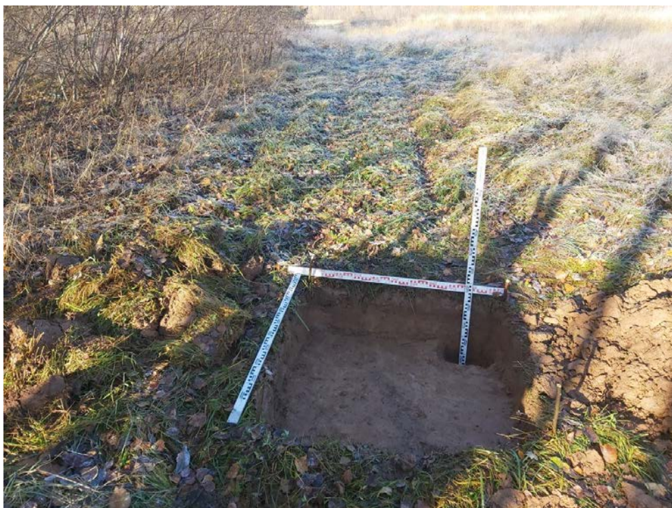
Рис. 89. Межпоселковый газопровод от ГРС Овино – д. Овино – д. Чемихино – д. Сугорова – д. Свирь с отводом на д. Устье и д. Новая Ленинградская область. Шурф 9. Зачистка по материку. Вид с ВЮВ.
