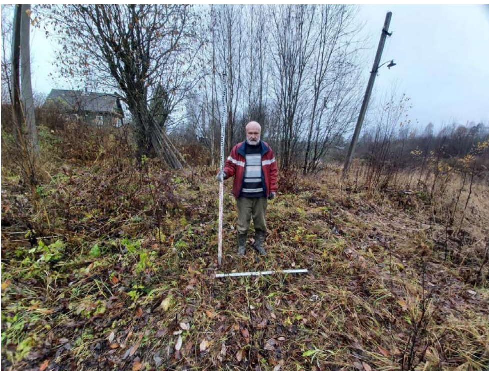
Рис. 116. Межпоселковый газопровод от ГРС Овино – д. Овино – д. Чемихино – д. Сугорово – д. Свирь с отводом на д. Устье и д. Новая Ленинградская область. Шурф 11. Местоположение. Вид с В.
