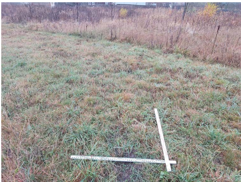
Рис. 16. Межпоселковый газопровод от ГРС Овино – д. Овино – д. Чемихино – д. Сугорово – д. Свирь с отводом на д. Устье и д. Новая Ленинградская область. Шурф 1. До начала работ. Вид с В.
