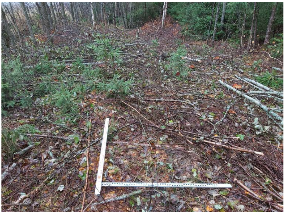
Рис. 52. Межпоселковый газопровод от ГРС Овино – д. Овино – д. Чемихино – д. Сугорово – д. Свирь с отводом на д. Устье и д. Новая Ленинградская область. Шурф 5. До начала работ. Вид с ЮВ.
