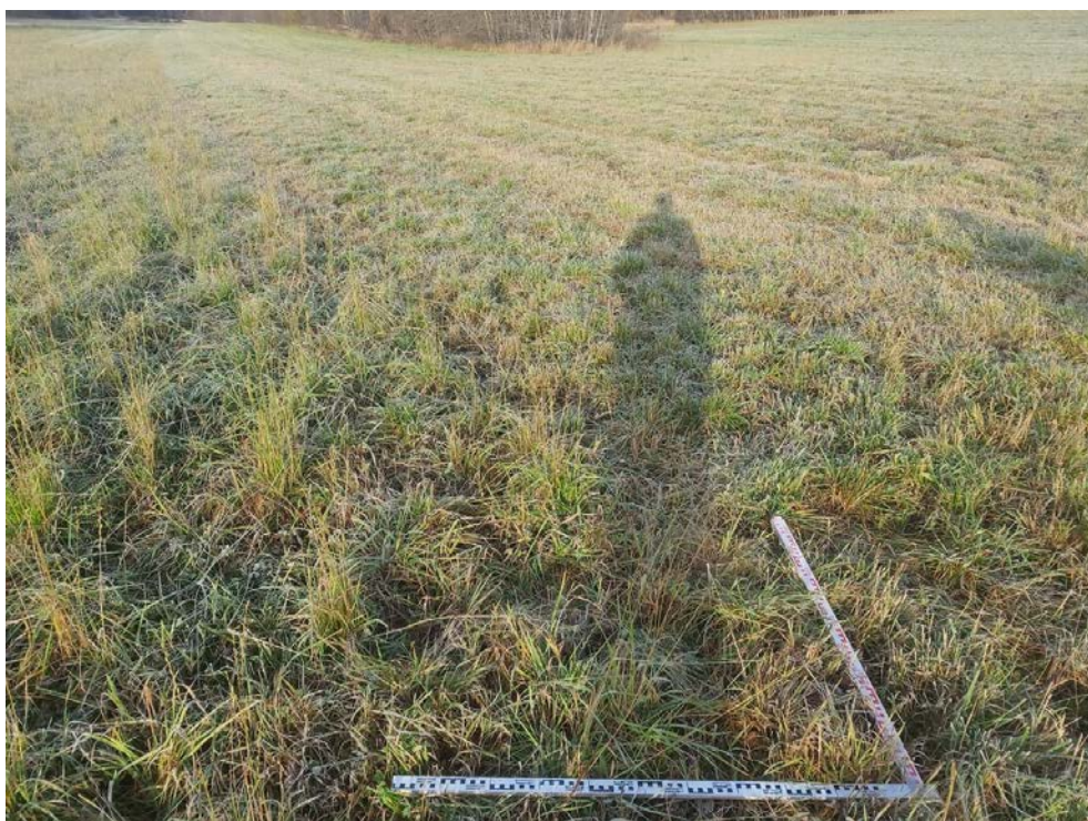
Рис. 78. Межпоселковый газопровод от ГРС Овино – д. Овино – д. Чемихино – д. Сугорово – д. Свирь с отводом на д. Устье и д. Новая Ленинградская область. Шурф 8. До начала работ. Вид с ЮВ.
