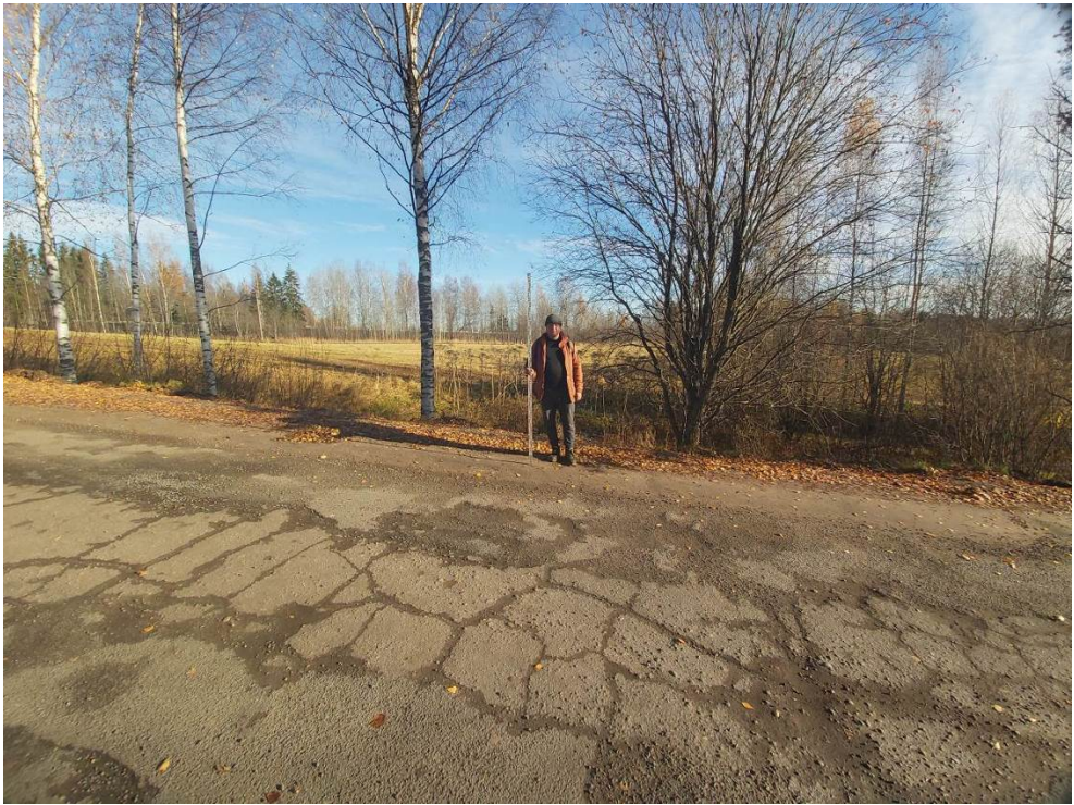
Рис. 101. Межпоселковый газопровод от ГРС Овино – д. Овино – д. Чемихино – д. Сугорово – д. Свирь с отводом на д. Устье и д. Новая Ленинградская область. Общий вид участка обследования. Точка съемки 26. Вид с З.
