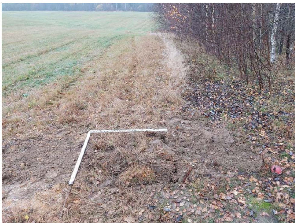
Рис. 34. Межпоселковый газопровод от ГРС Овино – д. Овино – д. Чемихино – д. Сугорово – д. Свирь с отводом на д. Устье и д. Новая Ленинградская область. Шурф 2. Засыпка. Вид с ЮВ.
