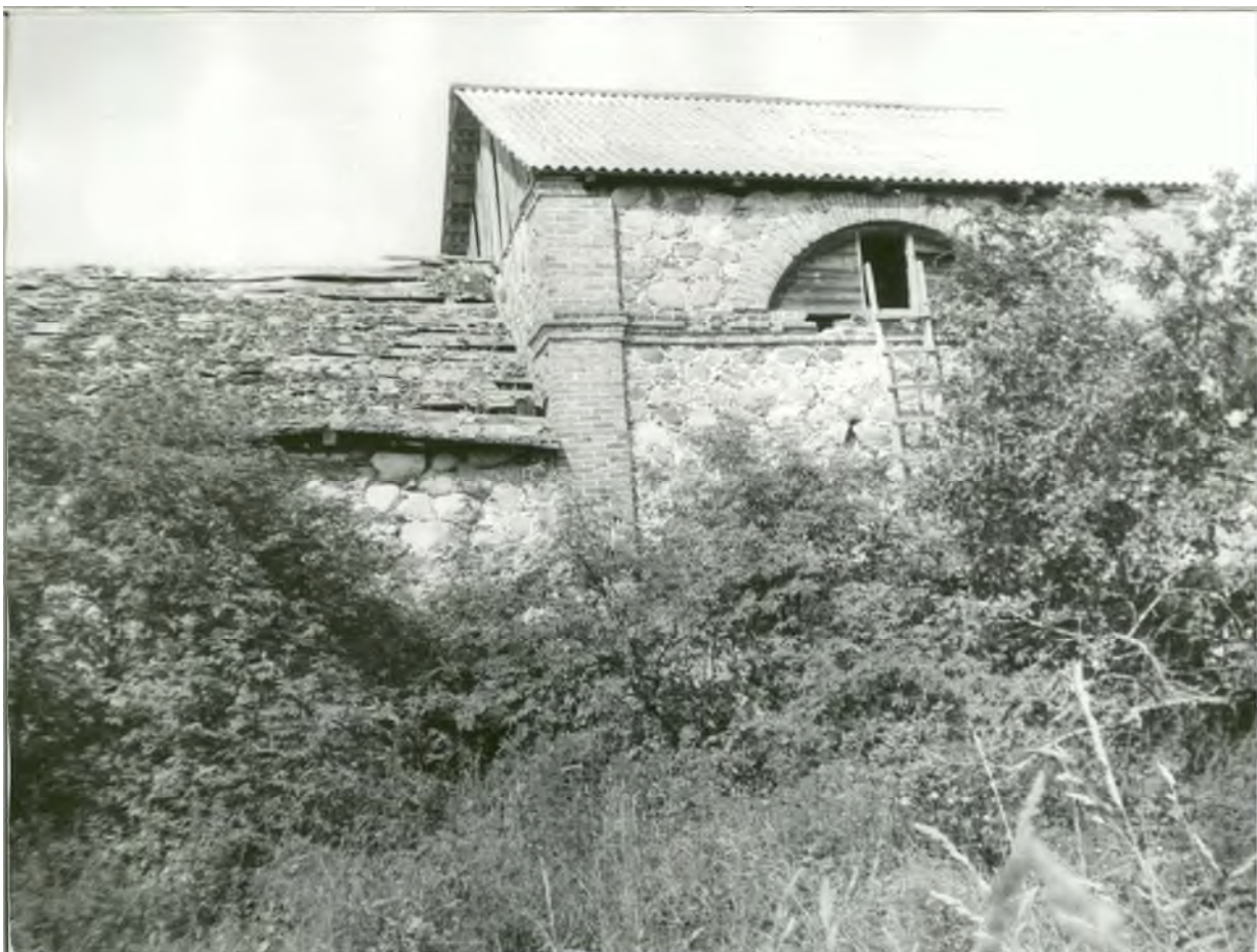
Илл. 62. Здание конюшни. Фотография 1992 г.
