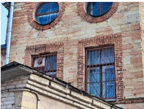
6. «Екатеринвердерская башня», 1797г.» в составе объекта культурного наследия федерального значения «Ансамбль Гатчинского дворца и парка», Ленинградская область, Гатчинский муниципальный район, Гатчинское городское поселение, г. Гатчина, проспект Красноармейский, дом 1, строение 18. Западный фасад. Фрагмент. Фото 23.03.2023г.
