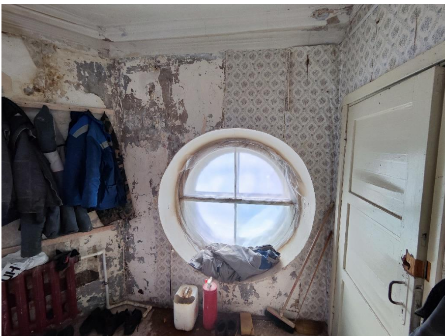
29. «Екатеринвердерская башня», 1797г.» в составе объекта культурного наследия федерального значения «Ансамбль Гатчинского дворца и парка», Ленинградская область, Гатчинский муниципальный район, Гатчинское городское поселение, г. Гатчина, проспект Красноармейский, дом 1, строение 18. Третий этаж. Помещение №4 (по Техническому паспорту). Общий вид. Фото 23.03.2023г.
