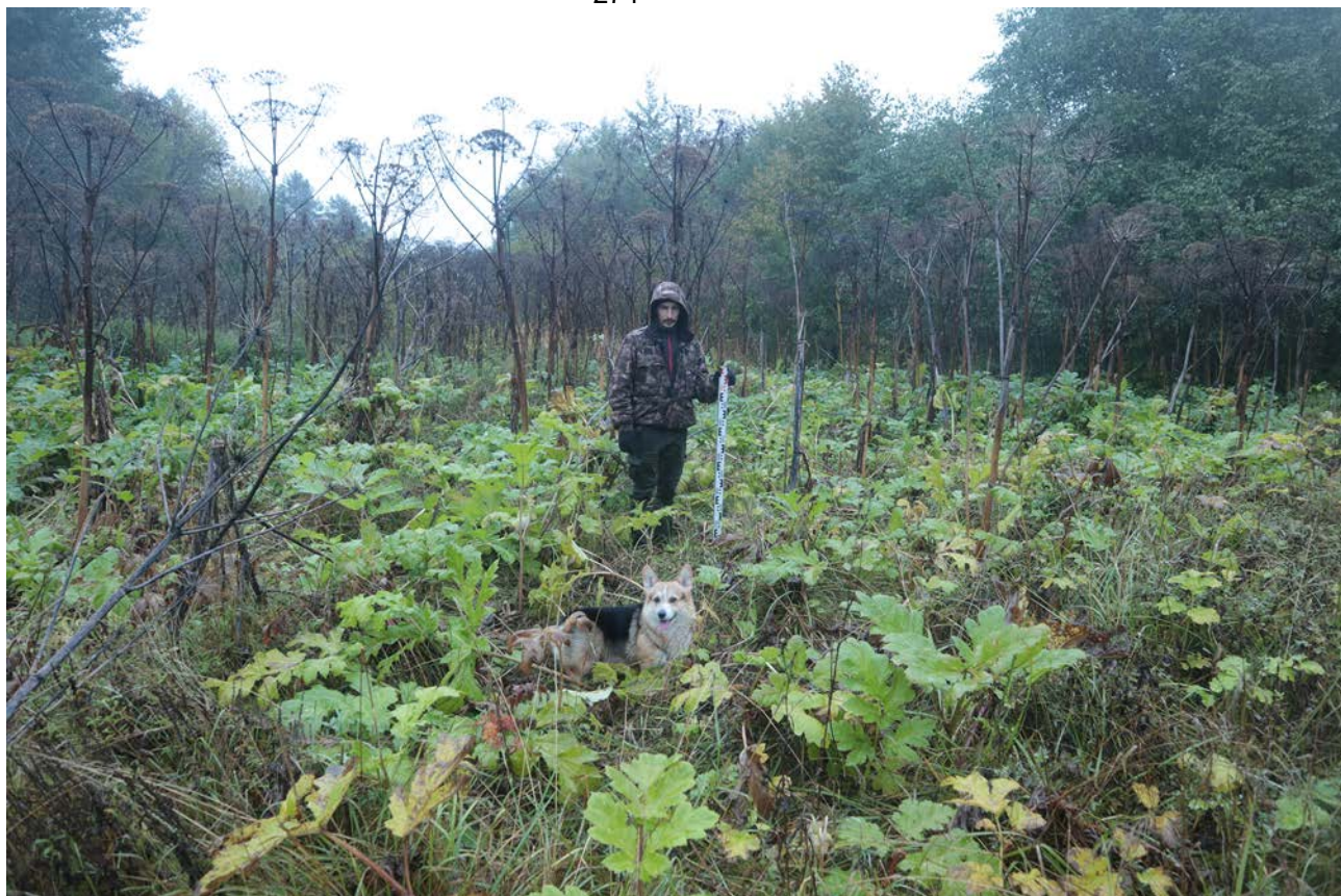
Рис. 167. Ленинградская область, Лужский район. Межпоселковый газопровод до п. Оредеж – д. Борщово – д. Ям-Тесово – п. Приозерный. Шурф 40. Общий вид до начала работ. Вид с юга
