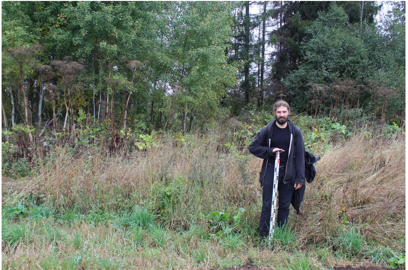
Рис. 181. Ленинградская область, Лужский район. Межпоселковый газопровод до п. Оредеж – д. Борщово – д. Ям-Тесово – п. Приозерный. Шурф 43. Общий вид до начала работ. Вид с юга
