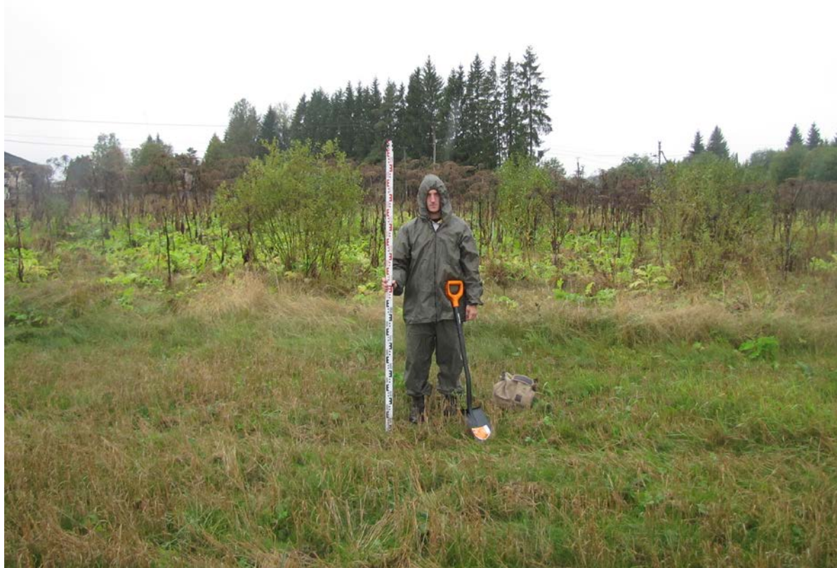
Рис. 11. Ленинградская область, Лужский район. Межпоселковый газопровод до п. Оредеж – д. Борщово – д. Ям-Тесово – п. Приозерный. Шурф 1. Общий вид до начала работ. Вид с юга
