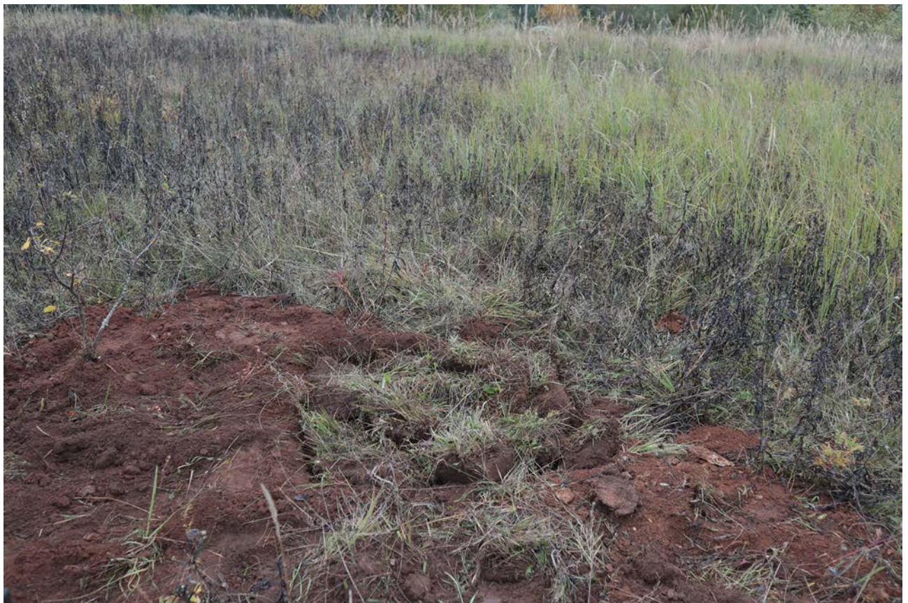
Рис. 345. Ленинградская область, Лужский район. Межпоселковый газопровод до п. Оредеж – д. Борщово – д. Ям-Тесово – п. Приозерный. Шурф 80. Рекультивация. Вид с юга
