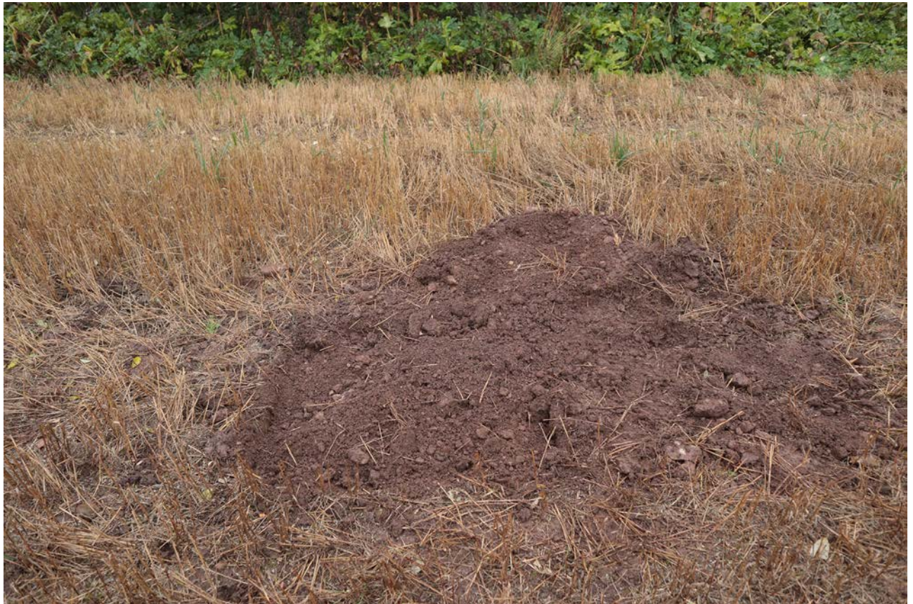
Рис. 74. Ленинградская область, Лужский район. Межпоселковый газопровод до п. Оредеж – д. Борщово – д. Ям-Тесово – п. Приозерный. Шурф 16. Рекультивация. Вид с юга
