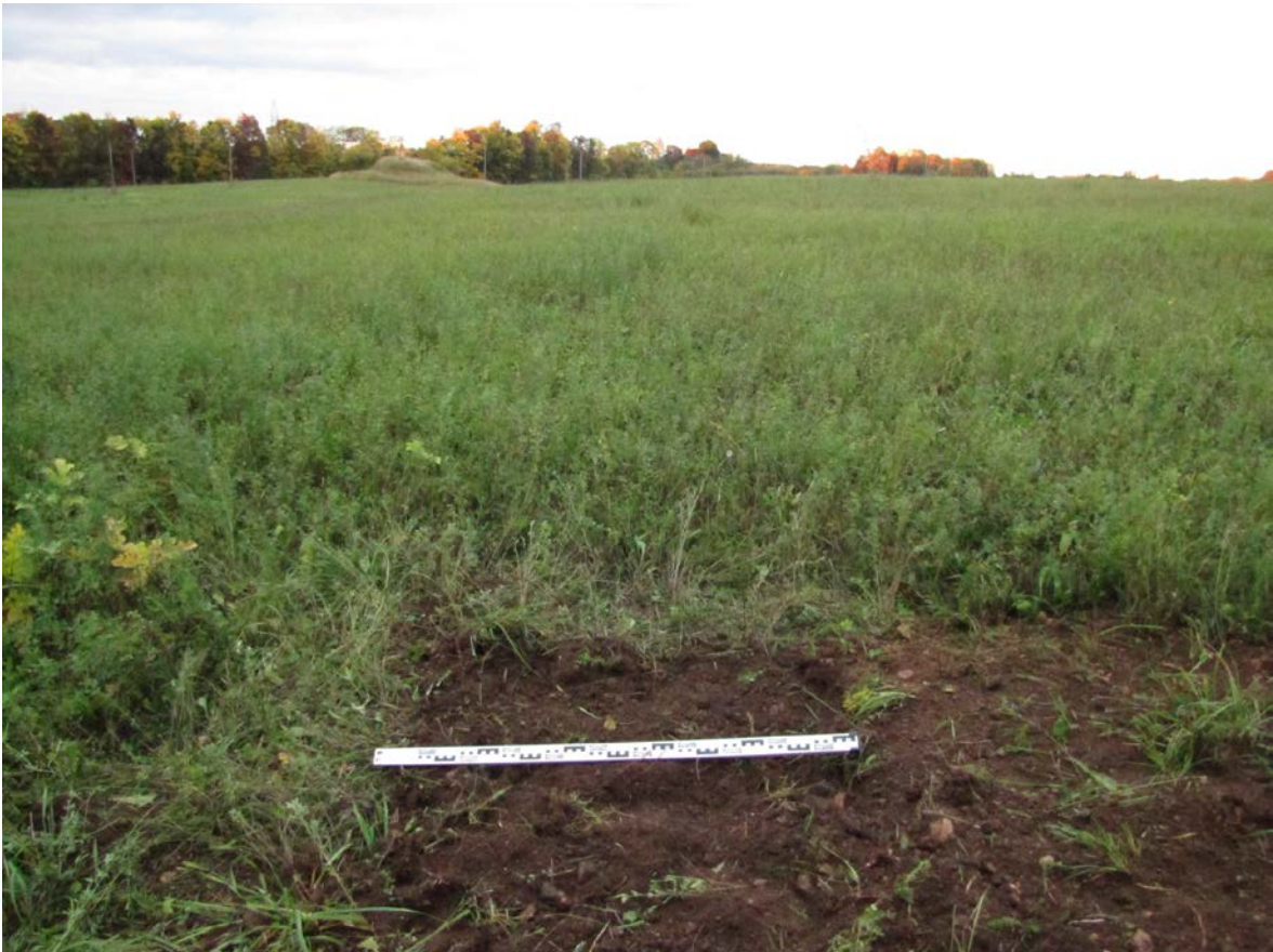
Рис. 319. Ленинградская область, Лужский район. Межпоселковый газопровод до п. Оредеж – д. Борщово – д. Ям-Тесово – п. Приозерный. Шурф 74. Рекультивация. Вид с юга
