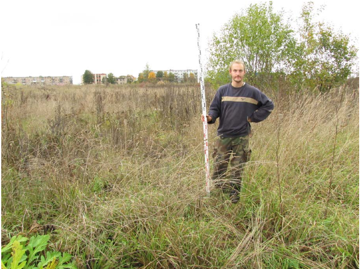
Рис. 294. Ленинградская область, Лужский район. Межпоселковый газопровод до п. Оредеж – д. Борщово – д. Ям-Тесово – п. Приозерный. Шурф 69. Общий вид до начала работ. Вид с юга
