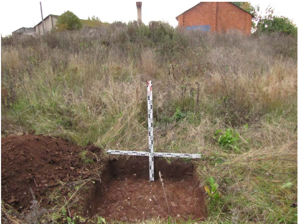
Рис. 383. Ленинградская область, Лужский район. Межпоселковый газопровод до п. Оредеж – д. Борщово – д. Ям-Тесово – п. Приозерный. Шурф 90. Общий вид зачистки по матеруку. Вид с юга
