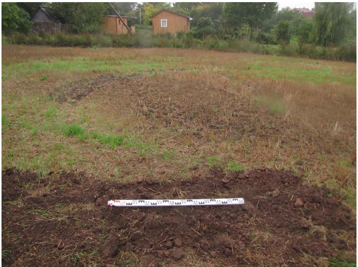
Рис. 118. Ленинградская область, Лужский район. Межпоселковый газопровод до п. Оредеж – д. Борщово – д. Ям-Тесово – п. Приозерный. Шурф 27. Рекультивация. Вид с юга
