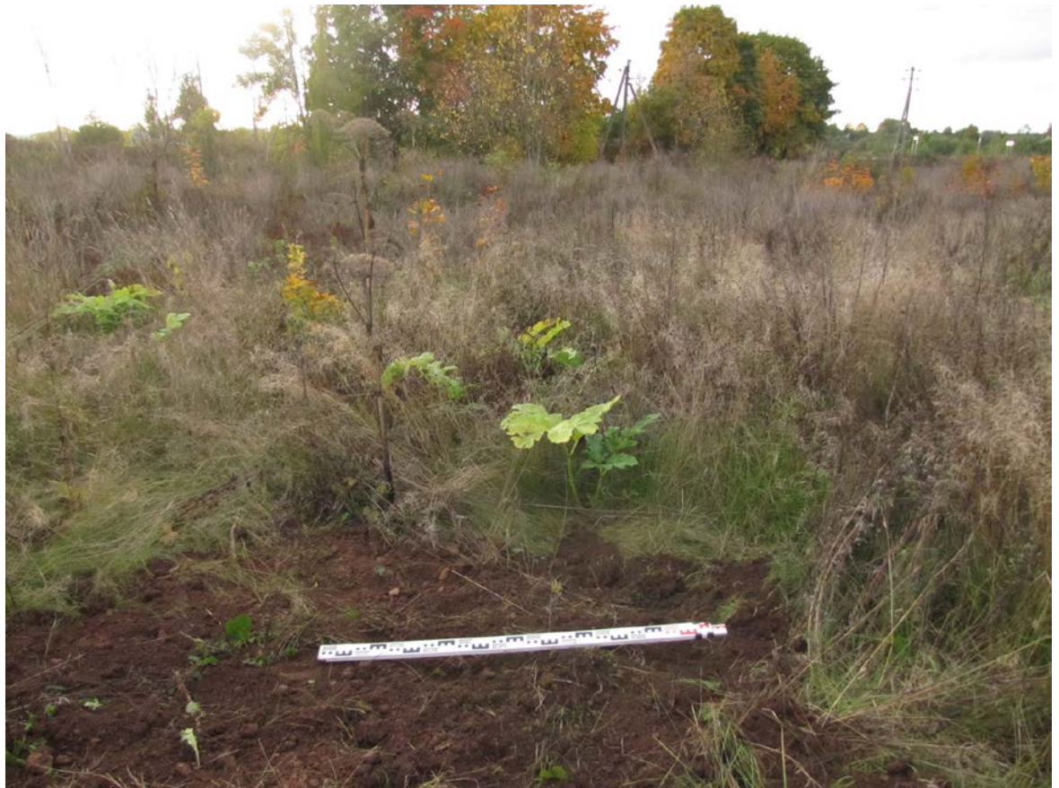
Рис. 393. Ленинградская область, Лужский район. Межпоселковый газопровод до п. Оредеж – д. Борщово – д. Ям-Тесово – п. Приозерный. Шурф 92. Рекультивация. Вид с юга
