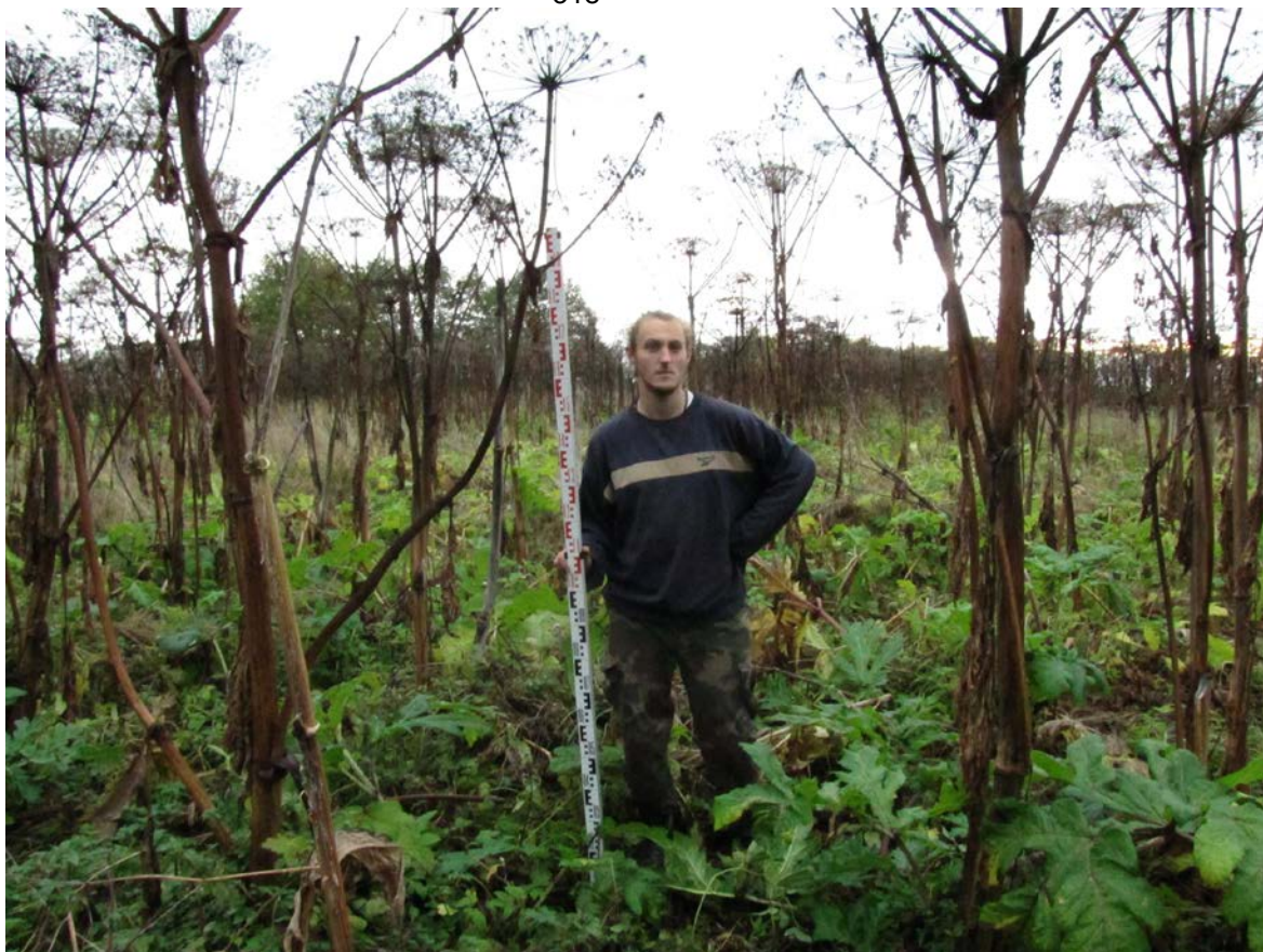
Рис. 254. Ленинградская область, Лужский район. Межпоселковый газопровод до п. Оредеж – д. Борщово – д. Ям-Тесово – п. Приозерный. Шурф 59. Общий вид до начала работ. Вид с юга
