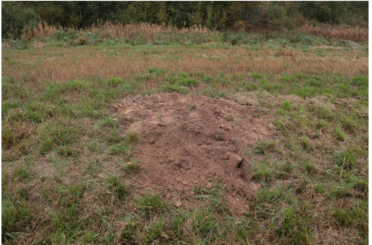
Рис. 46. Ленинградская область, Лужский район. Межпоселковый газопровод до п. Оредеж – д. Борцово – д. Ям-Тесово – п. Приозерный. Шурф 9. Рекультивация. Вид с юга
