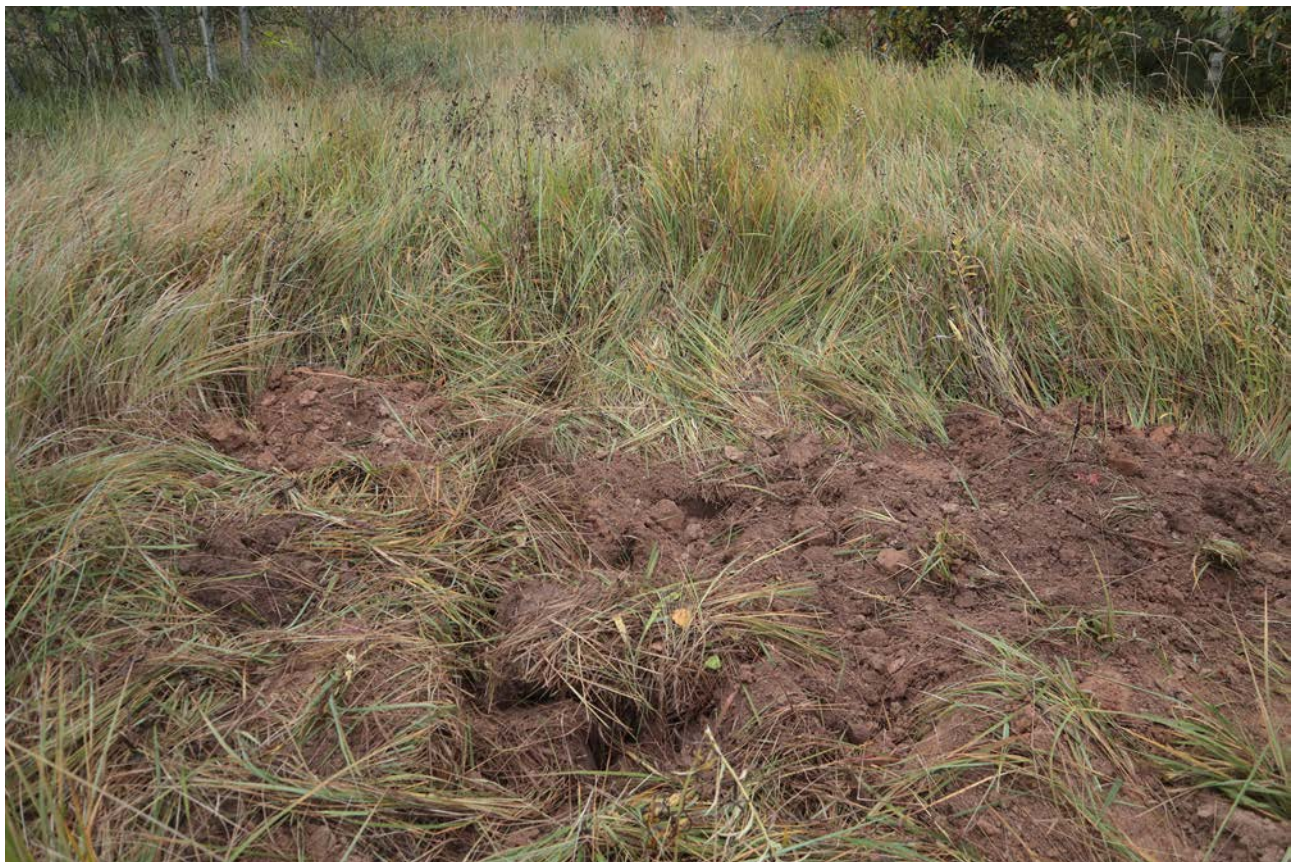
Рис. 377. Ленинградская область, Лужский район. Межпоселковый газопровод до п. Оредеж – д. Борщово – д. Ям-Тесово – п. Приозерный. Шурф 88. Рекультивация. Вид с юга
