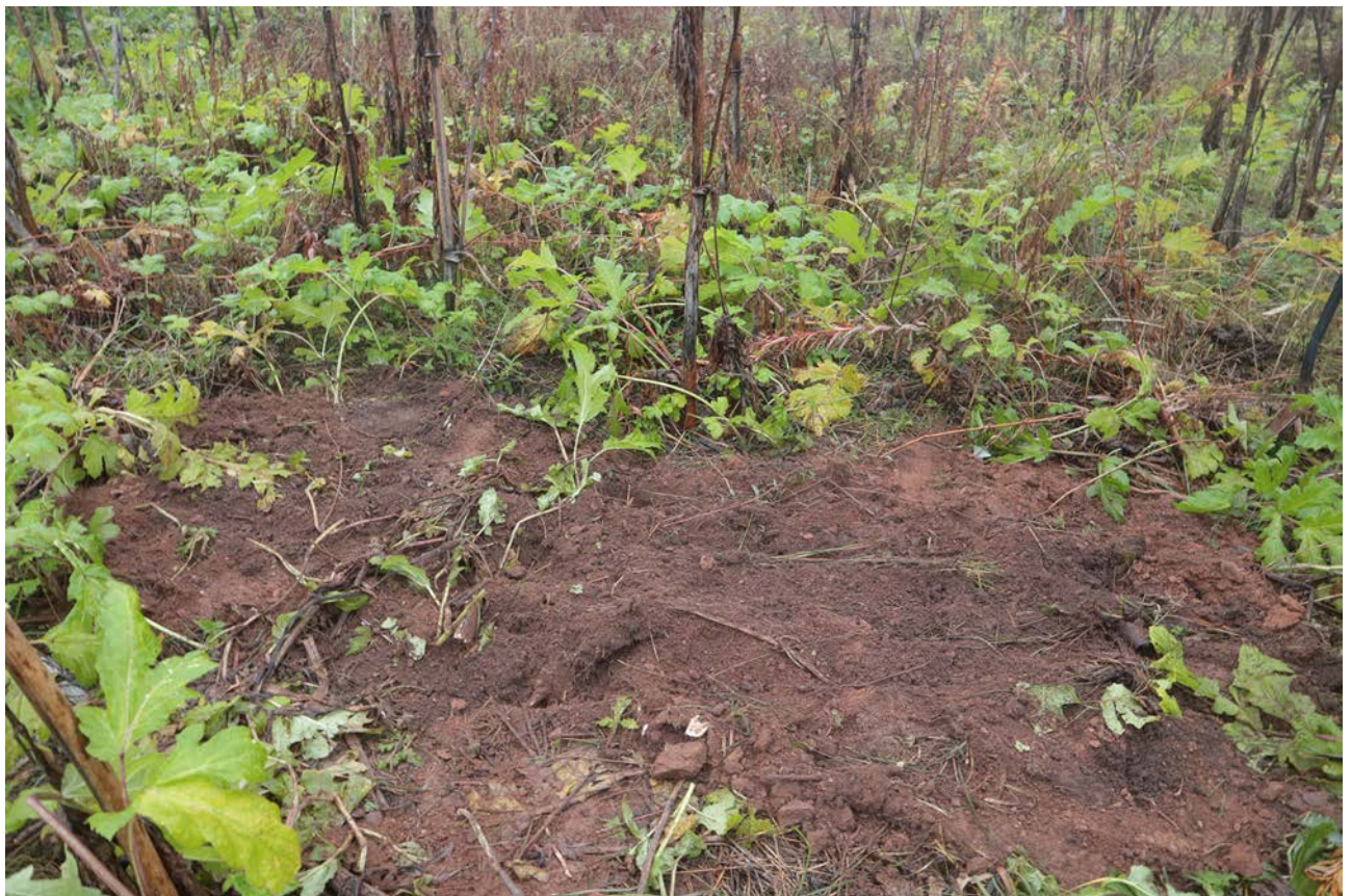
Рис. 162. Ленинградская область, Лужский район. Межпоселковый газопровод до п. Оредеж – д. Борщово – д. Ям-Тесово – п. Приозерный. Шурф 38. Рекультивация. Вид с юга
