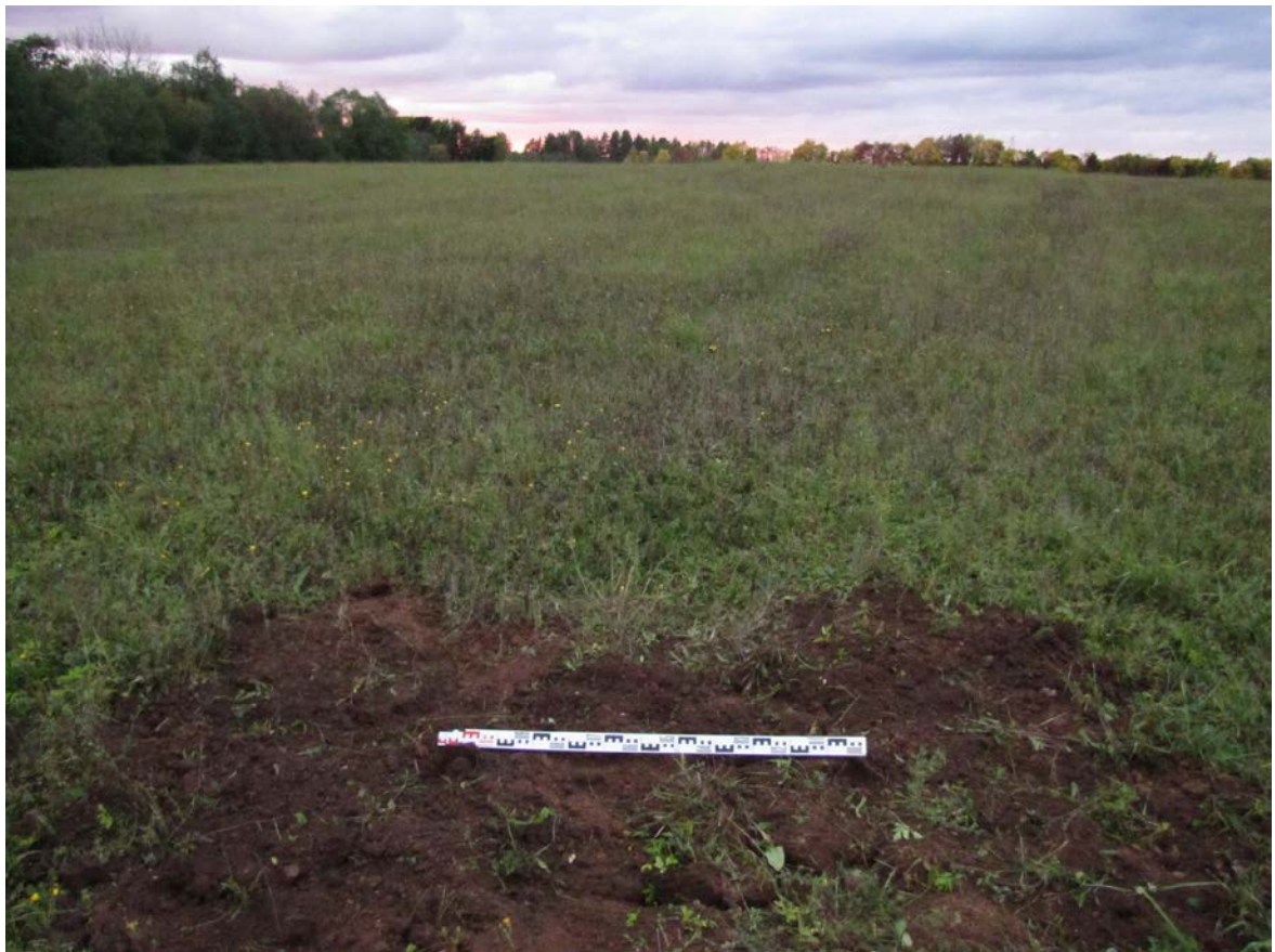
Рис. 323. Ленинградская область, Лужский район. Межпоселковый газопровод до п. Оредеж – д. Борщово – д. Ям-Тесово – п. Приозерный. Шурф 75. Рекультивация. Вид с юга
