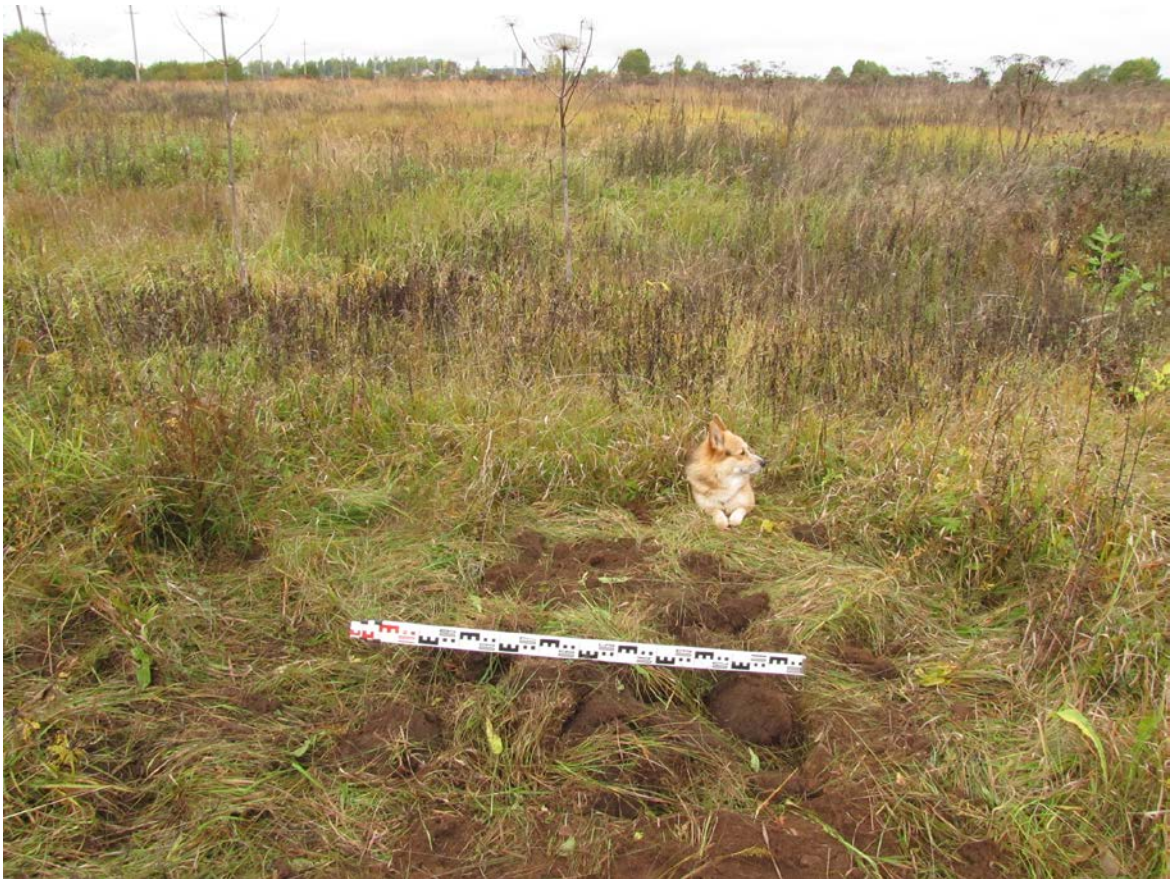
Рис. 357. Ленинградская область, Лужский район. Межпоселковый газопровод до п. Оредеж – д. Борщово – д. Ям-Тесово – п. Приозерный. Шурф 83. Рекультивация. Вид с юга
