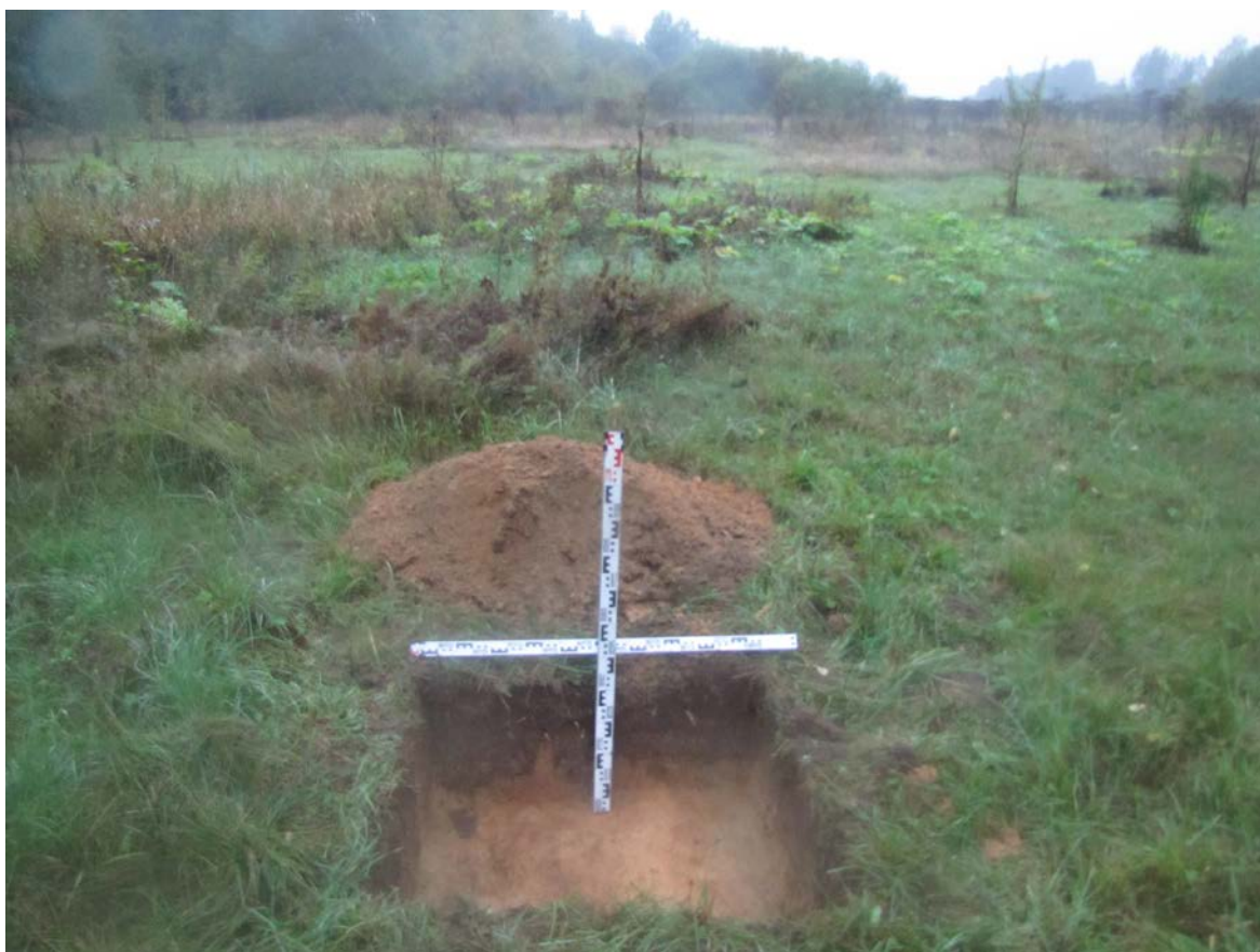
Рис. 156. Ленинградская область, Лужский район. Межпоселковый газопровод до п. Оредеж – д. Борщово – д. Ям-Тесово – п. Приозерный. Шурф 37. Общий вид зачистки по матерiku. Вид с юга
