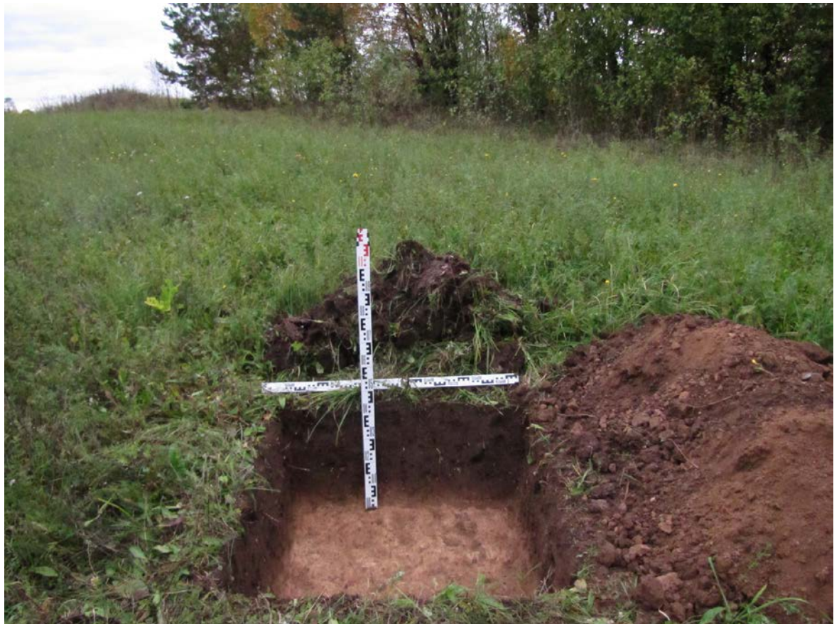
Рис. 325. Ленинградская область, Лужский район. Межпоселковый газопровод до п. Оредеж – д. Борщово – д. Ям-Тесово – п. Приозерный. Шурф 76. Общий вид зачистки по матерiku. Вид с юга
