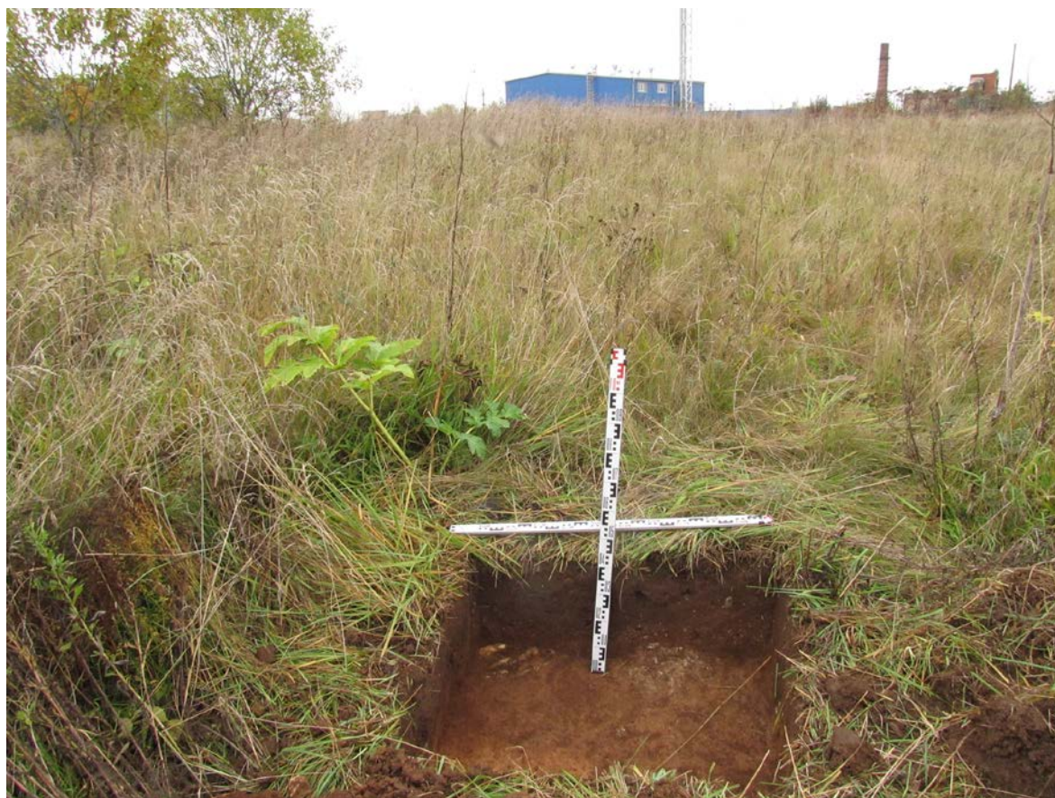
Рис. 287. Ленинградская область, Лужский район. Межпоселковый газопровод до п. Оредеж – д. Борщово – д. Ям-Тесово – п. Приозерный. Шурф 67. Общий вид зачистки по материке. Вид с юга
