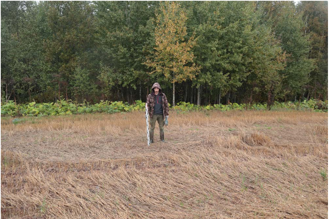
Рис. 47. Ленинградская область, Лужский район. Межпоселковый газопровод до п. Оредеж – д. Борщово – д. Ям-Тесово – п. Приозерный. Шурф 10. Общий вид до начала работ. Вид с юга
