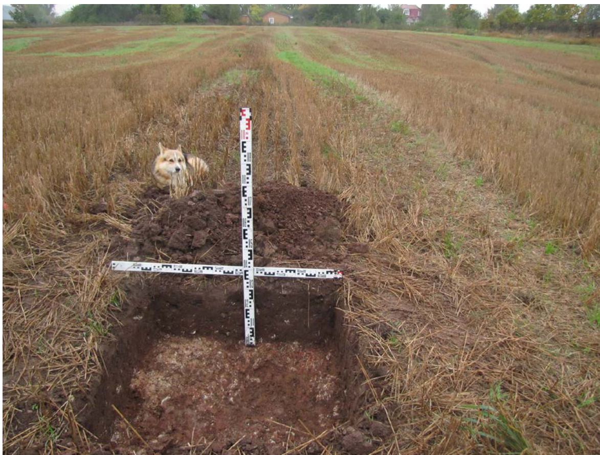
Рис. 120. Ленинградская область, Лужский район. Межпоселковый газопровод до п. Оредеж – д. Борщово – д. Ям-Тесово – п. Приозерный. Шурф 28. Общий вид зачистки по материке. Вид с юга
