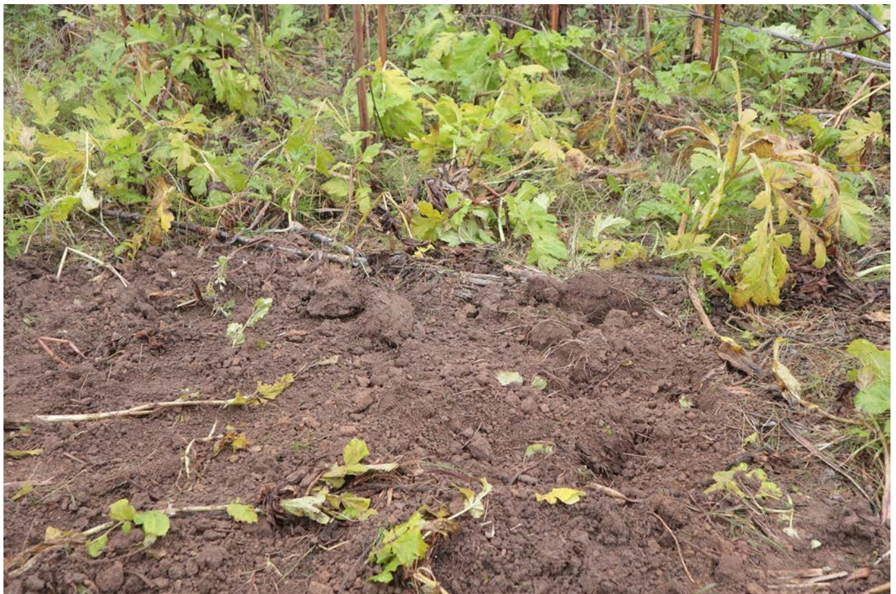
Рис. 381. Ленинградская область, Лужский район. Межпоселковый газопровод до п. Оредеж – д. Борщово – д. Ям-Тесово – п. Приозерный. Шурф 89. Рекультивация. Вид с юга
