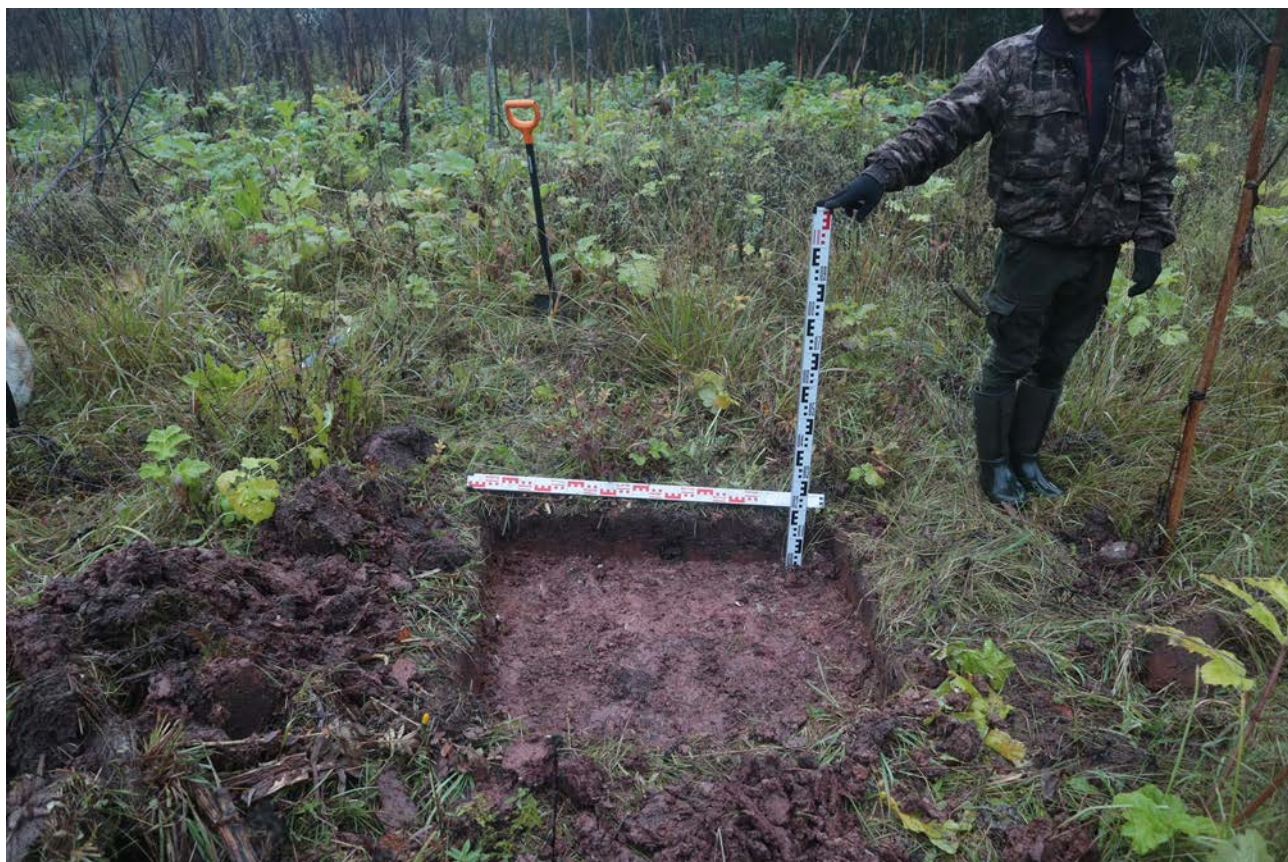
Рис. 168. Ленинградская область, Лужский район. Межпоселковый газопровод до п. Оредеж – д. Борщово – д. Ям-Тесово – п. Приозерный. Шурф 40. Общий вид зачистки по матерiku. Вид с юга
