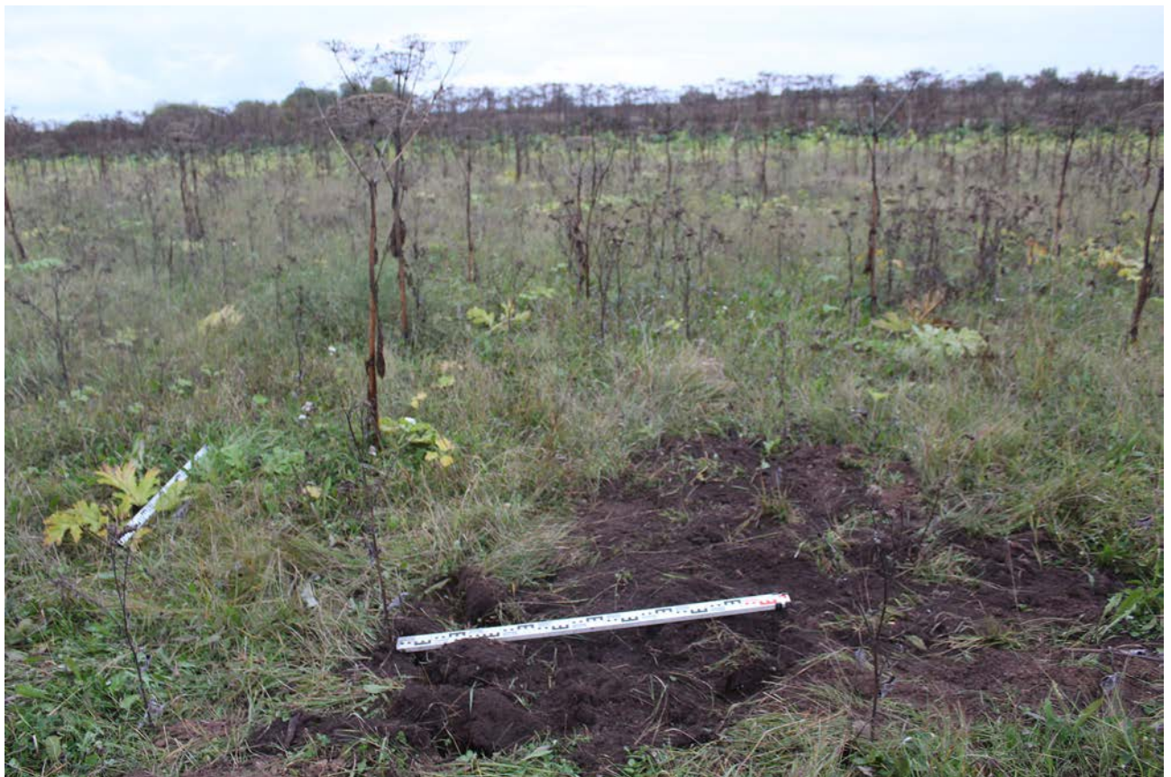
Рис. 277. Ленинградская область, Лужский район. Межпоселковый газопровод до п. Оредеж – д. Борщово – д. Ям-Тесово – п. Приозерный. Шурф 64. Рекультивация. Вид с юга
