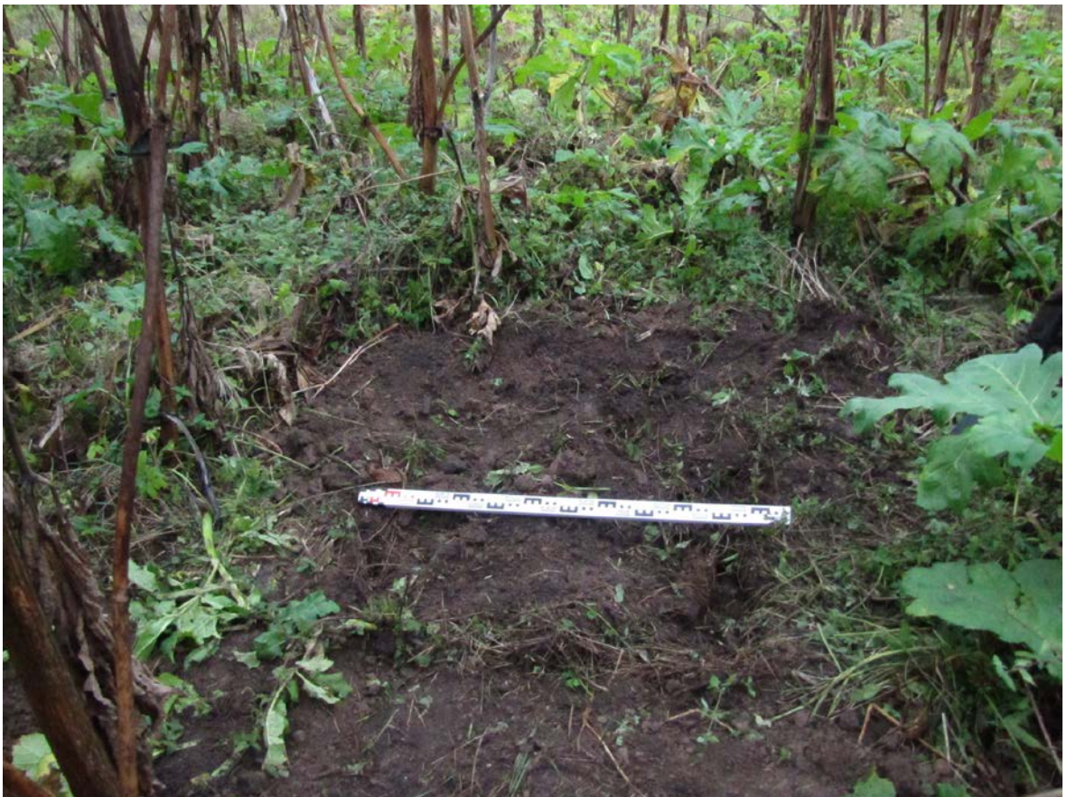
Рис. 257. Ленинградская область, Лужский район. Межпоселковый газопровод до п. Оредеж – д. Борщово – д. Ям-Тесово – п. Приозерный. Шурф 59. Рекультивация. Вид с юга
