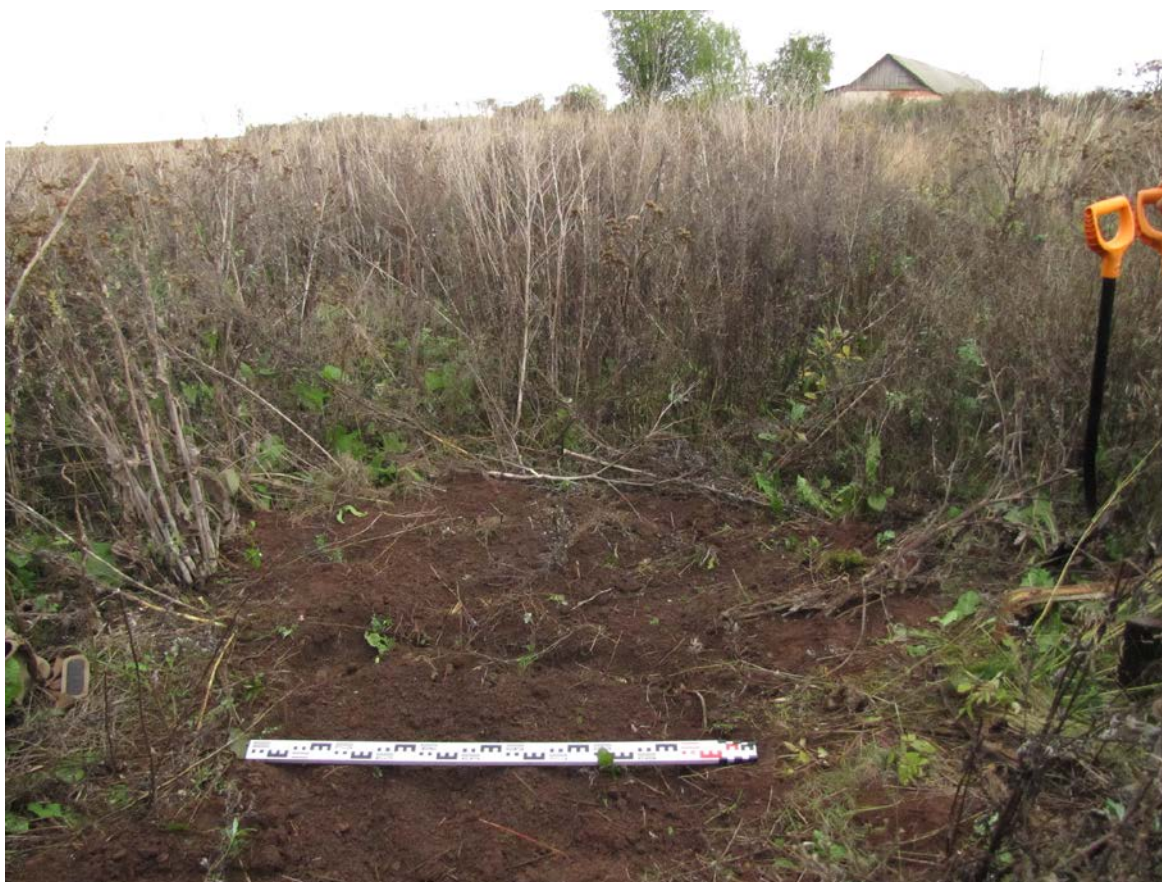
Рис. 389. Ленинградская область, Лужский район. Межпоселковый газопровод до п. Оредеж – д. Борщово – д. Ям-Тесово – п. Приозерный. Шурф 91. Рекультивация. Вид с юга
