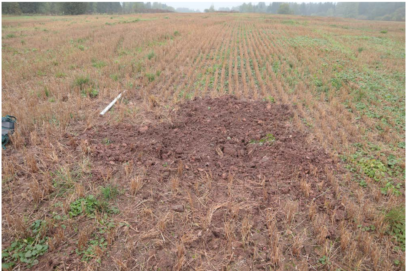
Рис. 130. Ленинградская область, Лужский район. Межпоселковый газопровод до п. Оредеж – д. Борщово – д. Ям-Тесово – п. Приозерный. Шурф 30. Рекультивация. Вид с юга
