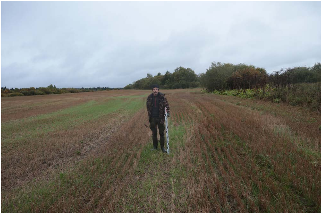
Рис. 103. Ленинградская область, Лужский район. Межпоселковый газопровод до п. Оредеж – д. Борщово – д. Ям-Тесово – п. Приозерный. Шурф 24. Общий вид до начала работ. Вид с юга
