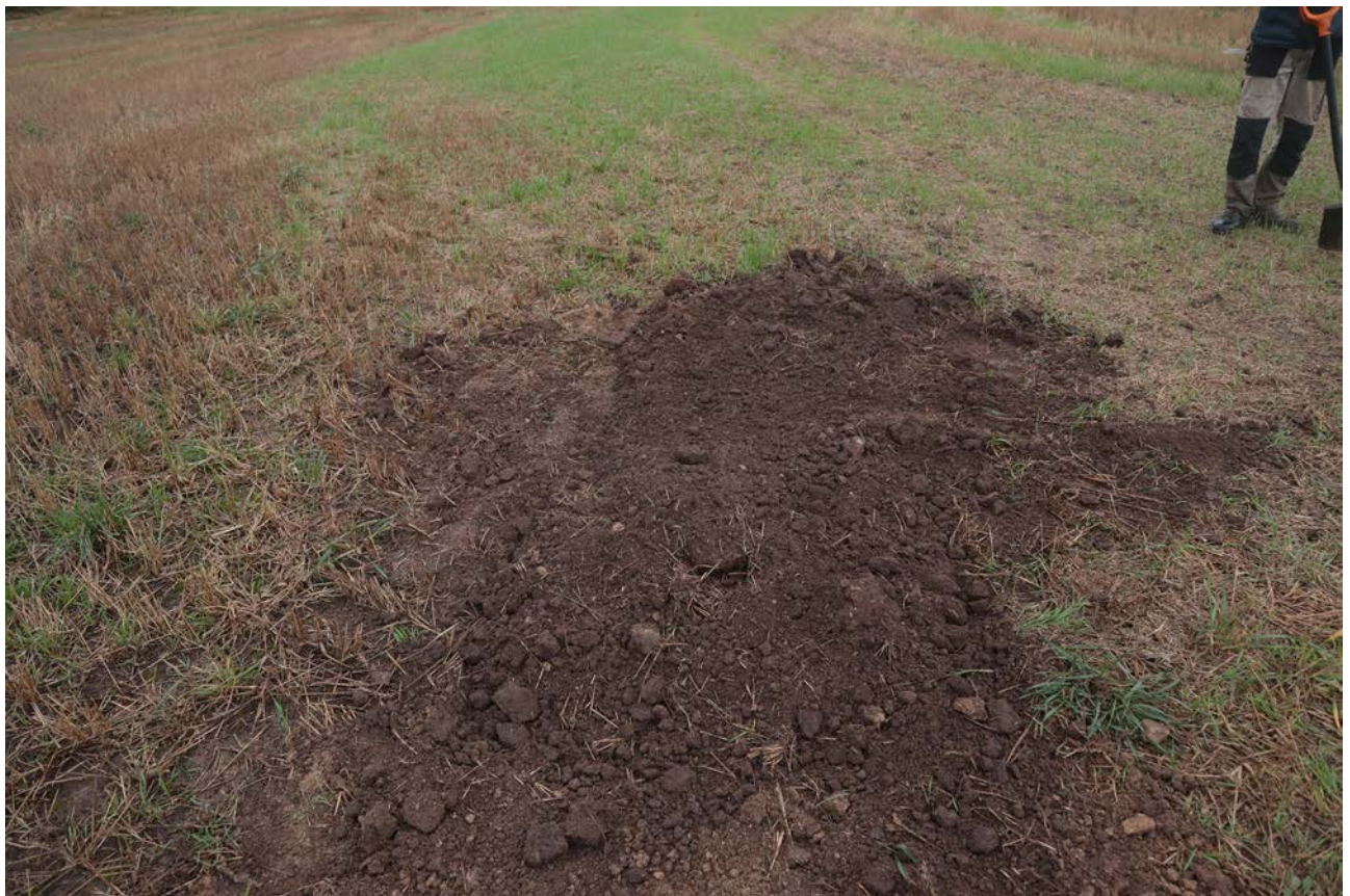
Рис. 110. Ленинградская область, Лужский район. Межпоселковый газопровод до п. Оредеж – д. Борщово – д. Ям-Тесово – п. Приозерный. Шурф 25. Рекультивация. Вид с юга
