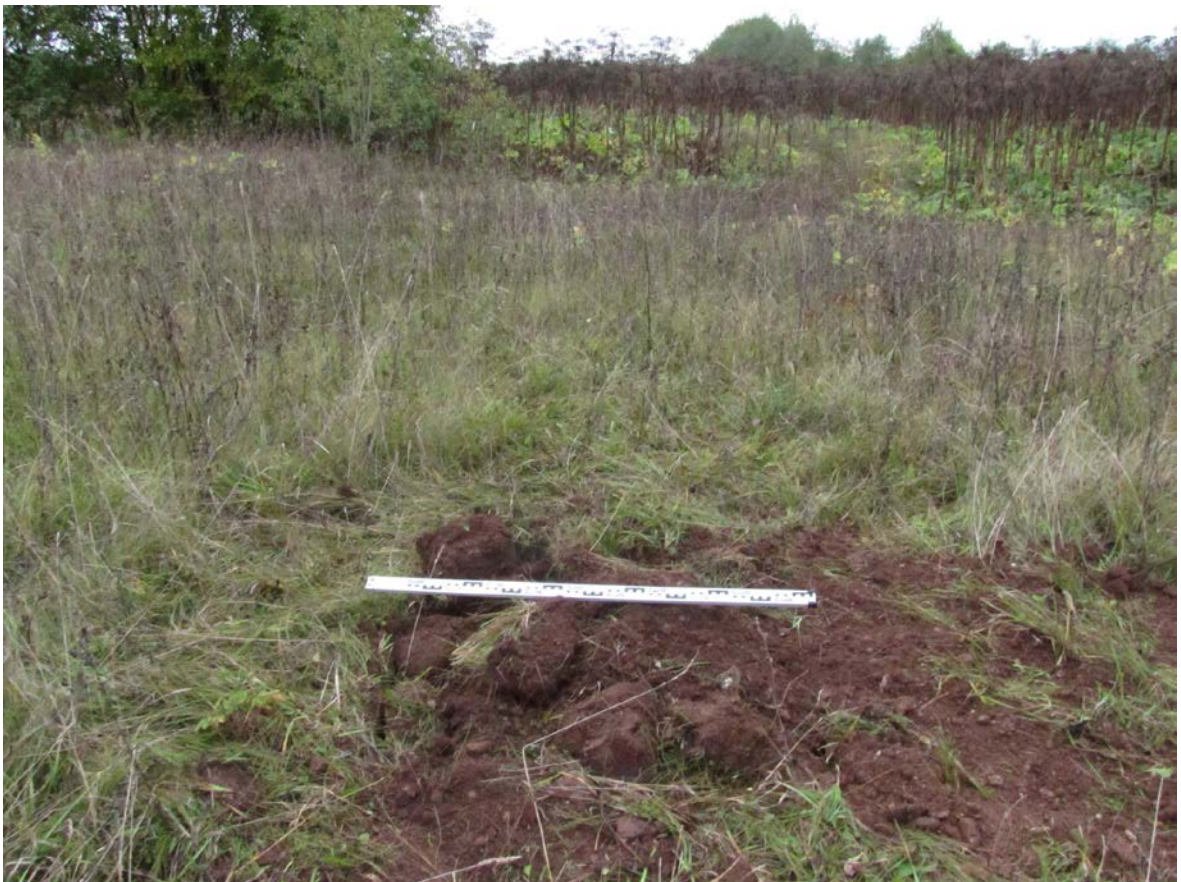
Рис. 253. Ленинградская область, Лужский район. Межпоселковый газопровод до п. Оредеж – д. Борщово – д. Ям-Тесово – п. Приозерный. Шурф 58. Рекультивация. Вид с юга
