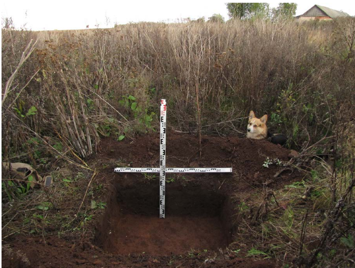
Рис. 387. Ленинградская область, Лужский район. Межпоселковый газопровод до п. Оредеж – д. Борщово – д. Ям-Тесово – п. Приозерный. Шурф 91. Общий вид зачистки по матерiku. Вид с юга
