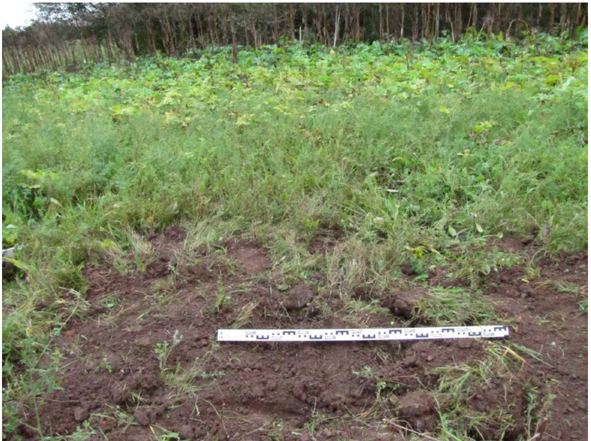
Рис. 315. Ленинградская область, Лужский район. Межпоселковый газопровод до п. Оредеж – д. Борщово – д. Ям-Тесово – п. Приозерный. Шурф 73. Рекультивация. Вид с юга
