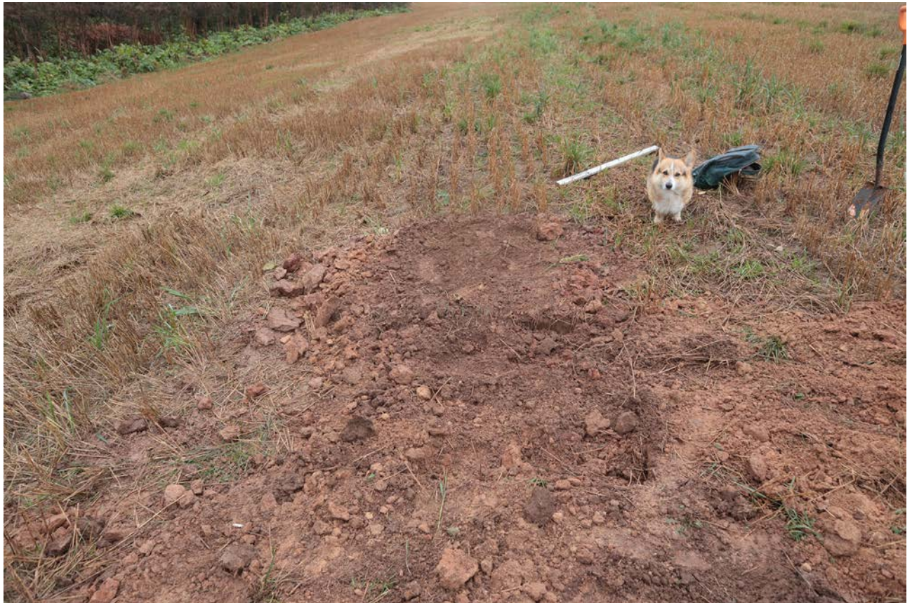
Рис. 34. Ленинградская область, Лужский район. Межпоселковый газопровод до п. Оредеж – д. Борцово – д. Ям-Тесово – п. Приозерный. Шурф 6. Рекультивация. Вид с юга
