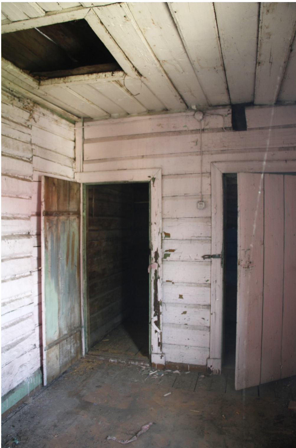
17. «Жилой дом». Ленинградская область, г. Луга, пр. Кирова, д. 34. Фрагмент интерьера помещения 2-го этажа.
