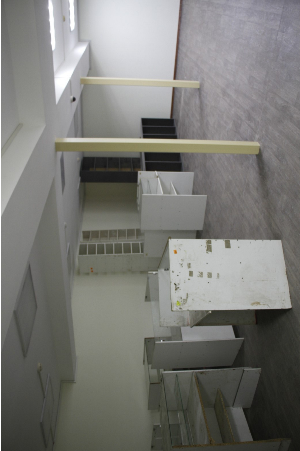
5. «Жилой дом». Ленинградская область, г. Луга, пр. Кирова, д. 34. Фрагмент интерьера подвального помещения.
