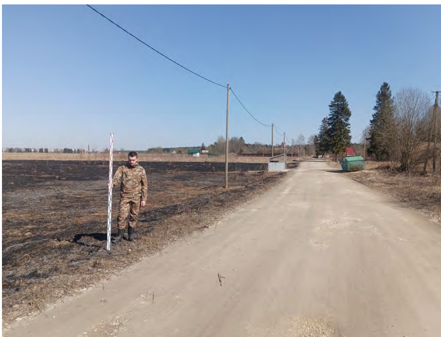
Рис. 183. Ленинградская область, Гатчинский район, «Межпоселковый газопровод до д. Холоповицы - д. Алексеевка - д. Раболово с отводами на д. Яскелево, д. Березнево, д. Ознаково, д. Колодези Гатчинского района Ленинградской области». 2023 г. Общий вид участка обследования. Точка фиксации 36. Вид с З
