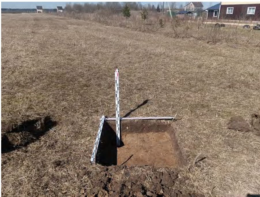
Рис. 178. Ленинградская область, Гатчинский район, «Межпоселковый газопровод до д. Холоповицы - д. Алексеевка - д. Раболово с отводами на д. Яскелево, д. Березнево, д. Ознаково, д. Колодези Гатчинского района Ленинградской области». 2023 г. Шурф 13. Зачистка по материке. Вид с Ю
