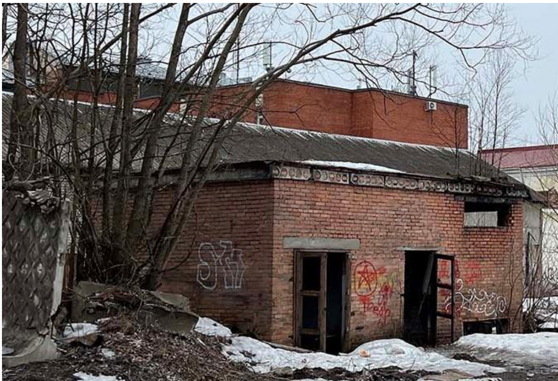
Фото 15. Современное разрушенное здание в северной части исторического участка № 38. Фото с северо-запада. Дата съемки: 23.01.2023 г. Автор: эксперт Куваева Ю.П.
