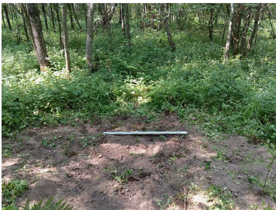
Рис. 47. Ленинградская область, Гатчинский район, «Межпоселковый газопровод до д. Тихковицы с отводами на д. Старое Колено, д. Новое Поддубье, д. Старое Поддубье, д. Новое Колено Гатчинского района Ленинградской области». 2023 г. Шурф 2. Рекультивация. Общий вид с Ю
