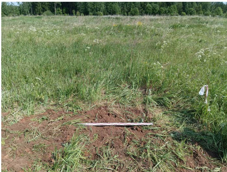
Рис. 180. Ленинградская область, Гатчинский район, «Межпоселковый газопровод до д. Тиховицы с отводами на д. Старое Колено, д. Новое Поддубье, д. Старое Поддубье, д. Новое Колено Гатчинского района Ленинградской области». 2023 г. Шурф 11. Рекультивация. Общий вид с Ю
