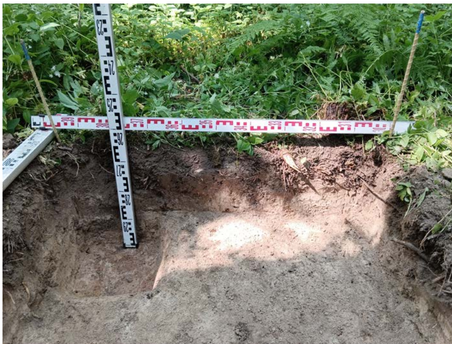
Рис. 46. Ленинградская область, Гатчинский район, «Межпоселковый газопровод до д. Тихковицы с отводами на д. Старое Колено, д. Новое Поддубье, д. Старое Поддубье, д. Новое Колено Гатчинского района Ленинградской области». 2023 г. Шурф 2. Северная стенка и контрольный прокоп. Вид с Ю
