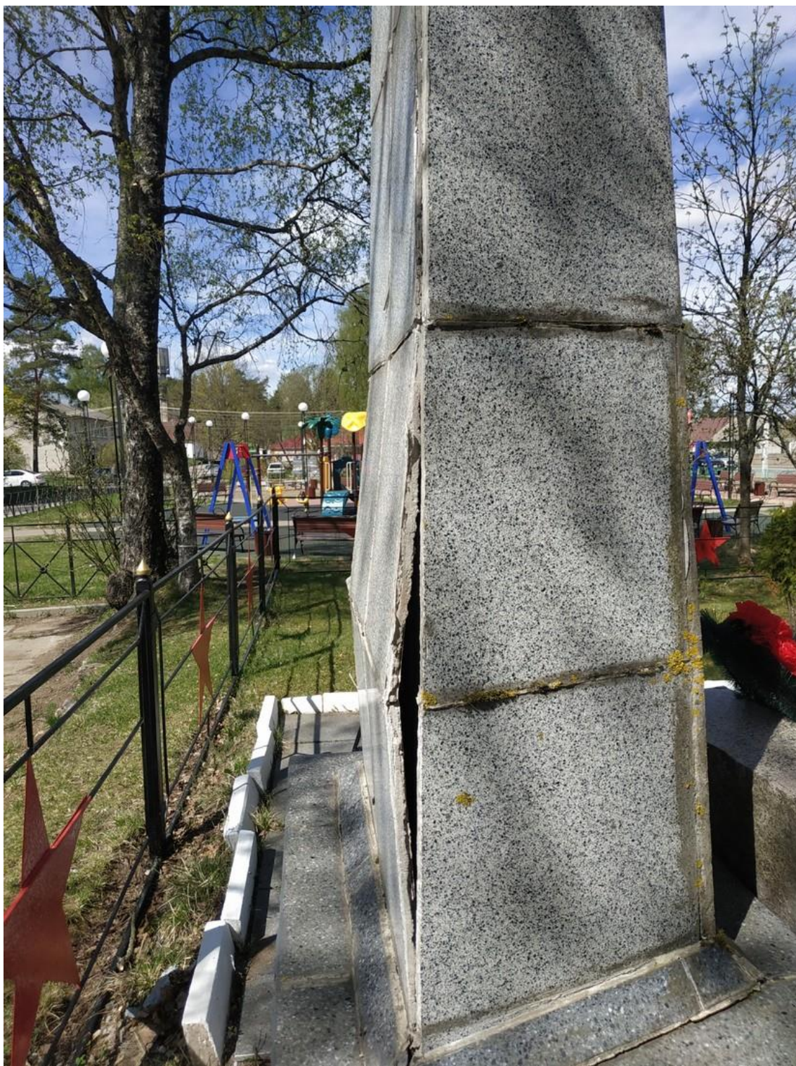
11. Отслоение поздней гранитной облицовки обелиска, разрушение бордюра (вид с юга).
