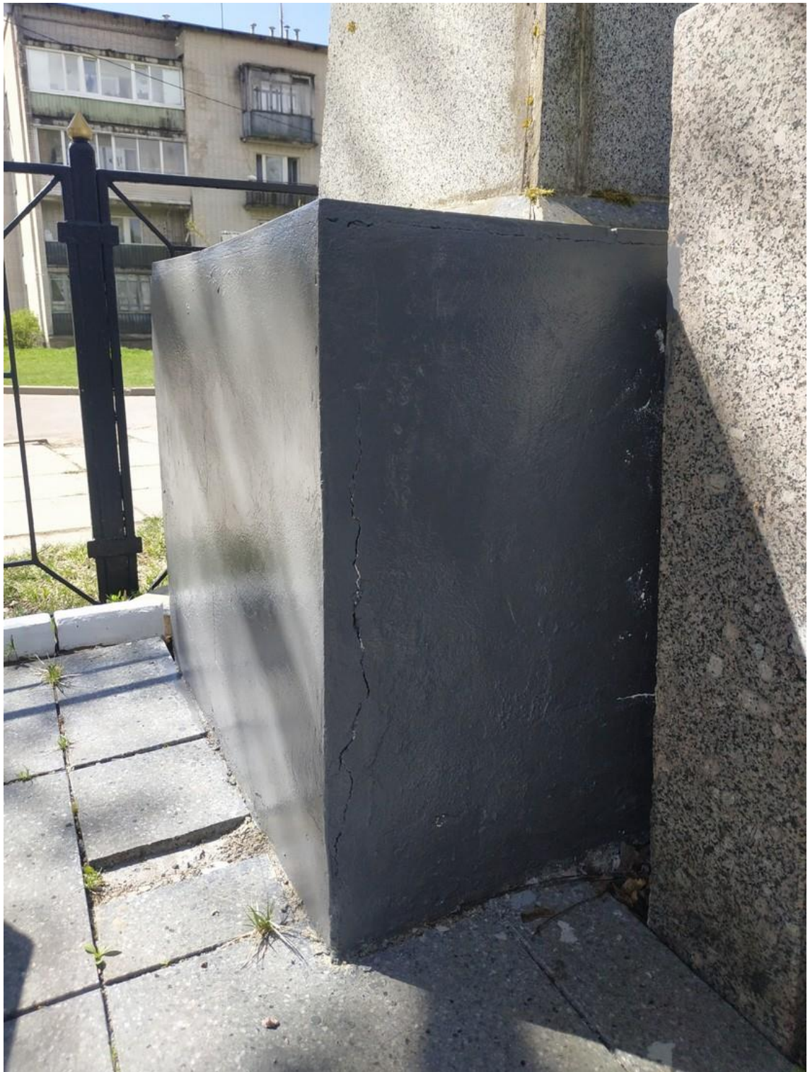
10. Трещины на цоколе обелиска.
