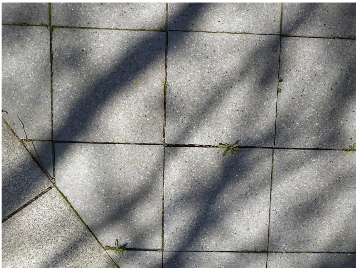
13. Верхняя площадка, замощённая плитами. Мощение находится в неудовлетворительном состоянии.
