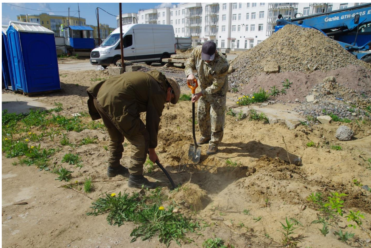
Рис. 18. Ленинградская область, Всеволожский муниципальный район, Сертоловское городское поселение, г. Сертолово, мкрн Сертолово-2, ул. Мира, земельный участок с кадастровым номером 47:08:0103002:2344. Шурф 1. Рабочий момент, общий вид площадки с северо-востока.
