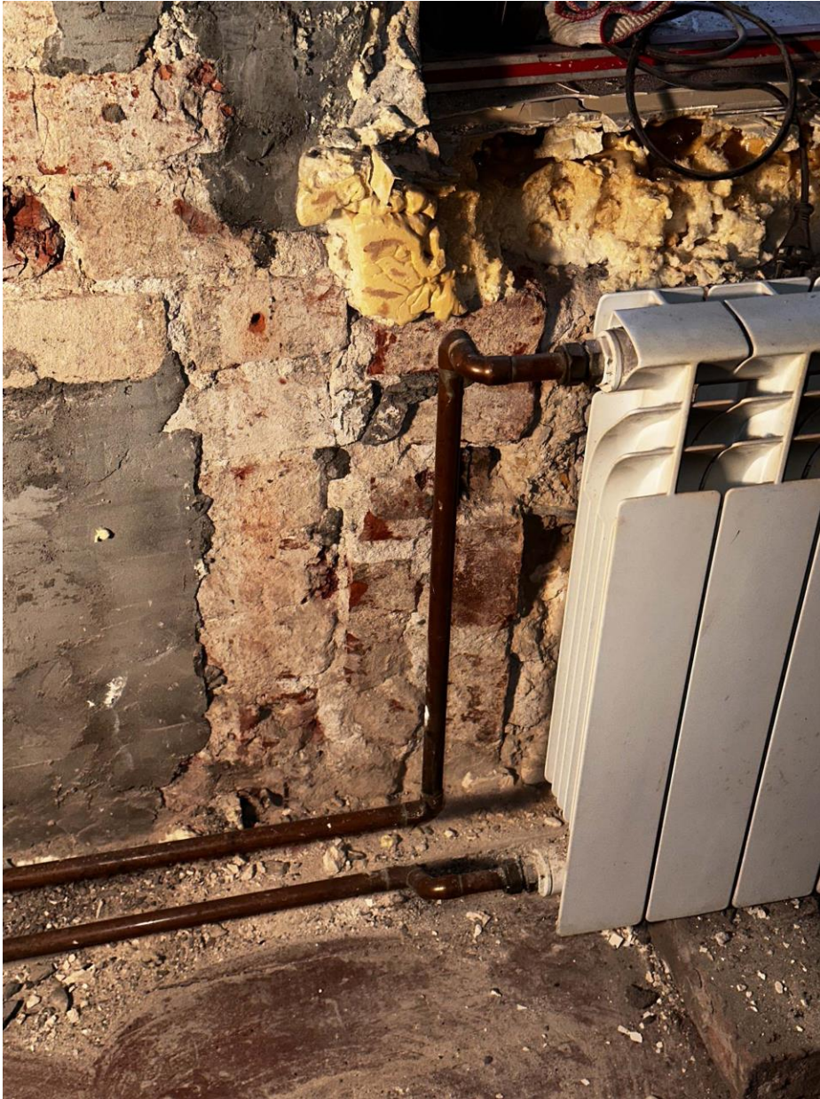
Фото 15. Закладка в левой части исторического витринного проема в наружной уличной стене. Дата съемки 14.06.2023 г. Автор съемки: Глинская Н.Б.
