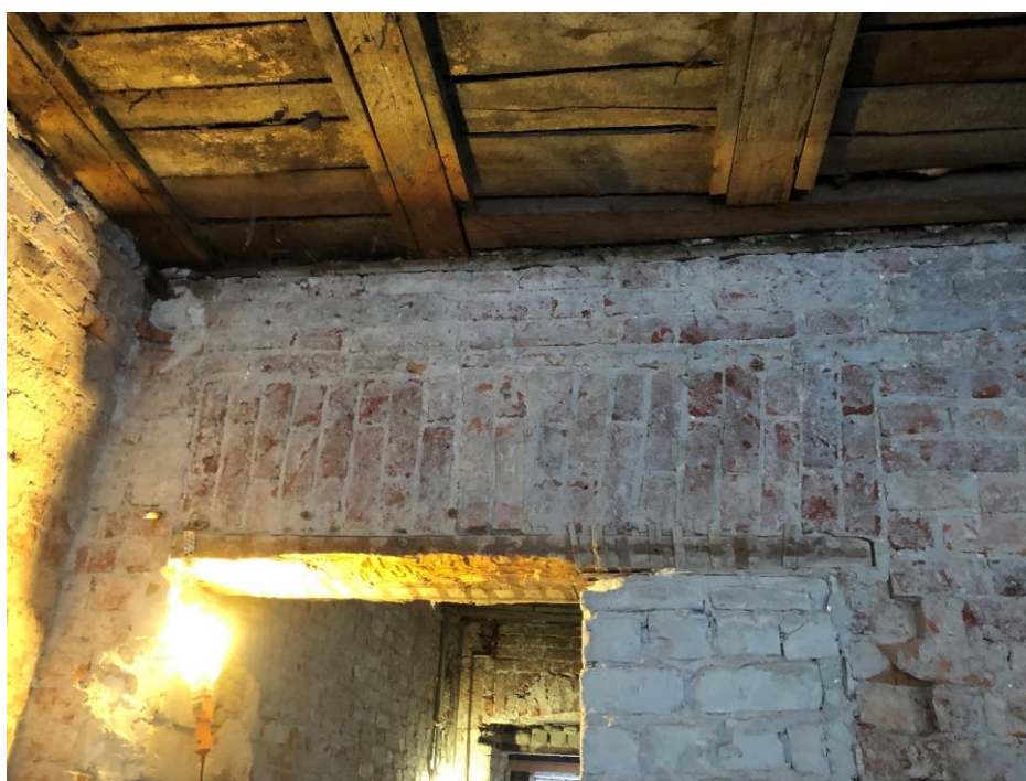
Фото 17. Помещение 1.1. Вид на перемычку дверного проема в стене по оси Б. Зондаж 4.
