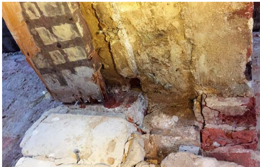
Фото 9. Вид снизу на перемычку. Низ кладки клинчатой перемычки на разных отметках, нет перевязки по кирпичу, нет единого тела перемычки.
