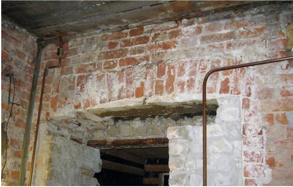
Фото 10. Поздняя частичная закладка дверного проема – уменьшена высота и ширина проема.
