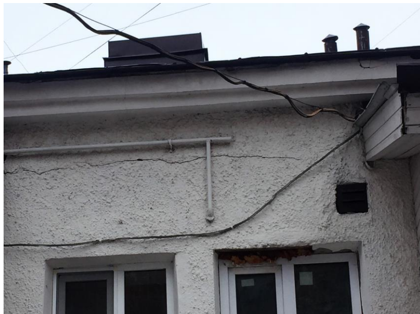
Фото 29. На дворовом фасаде трещина над оконными проемами.
