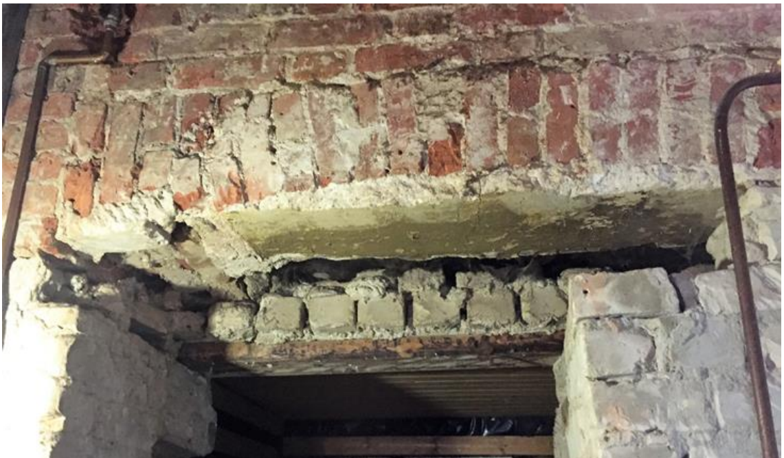
Фото 11. Трещины в кладке стены и в лучковой перемычке. Ремонт цементным раствором. Усиление перемычки металлом и дополнительной кладкой.
