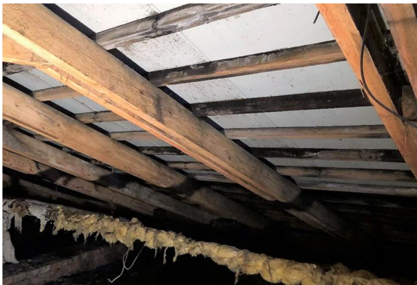
Фото 23. Скопление конденсата на кровельном железе, гниение обрешетки.
