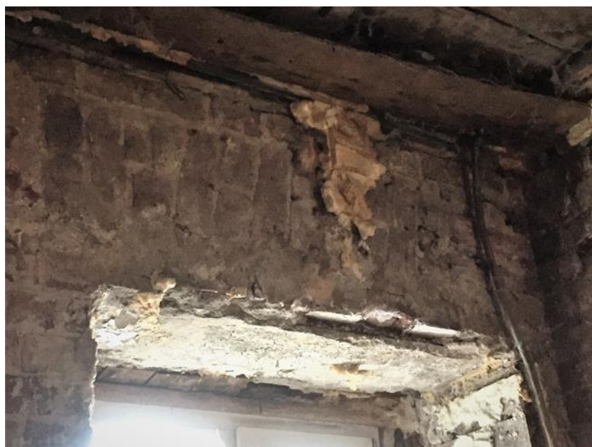
Фото 7. Проем пробит за пределы опорной части клинчатой перемычки, трещина в перемычке заполнена монтажной пеной.
