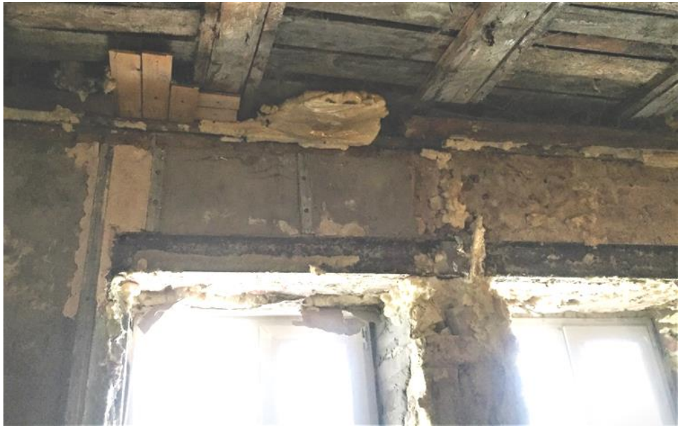
Фото 4. Бывший витринный проем расширен для устройства 2-х оконных проемов, опирание металлической перемычки на цементный откос 40 мм.
