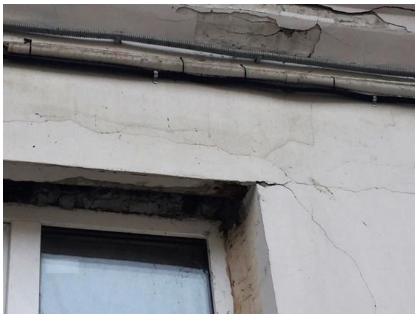
Фото 25. Трещины над оконным проемом.
