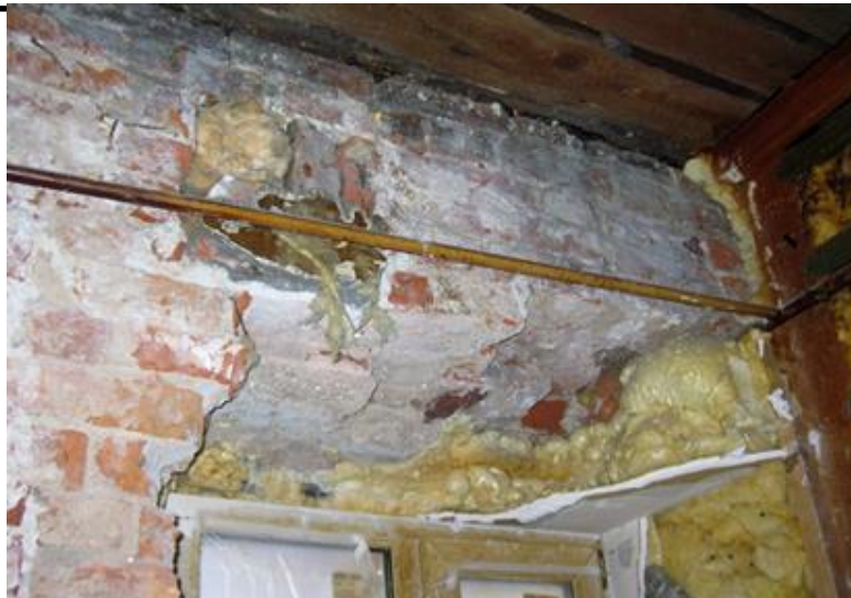
Фото 12. Пробит оконный проем в несущей стене без устройства перемычки.
