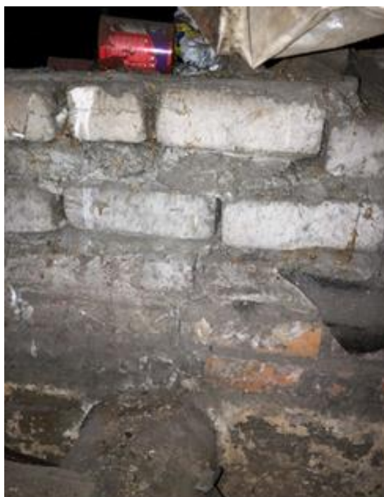
Фото 24. Трещина в поперечной стене (арочный проезд) в месте опирания балки перекрытия арочного проезда, разрушение поздней кладки из силикатного кирпича.
