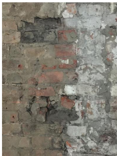
Фото 15. Поздние закладки битым кирпичом и заделки цементным раствором участков дымохода.
