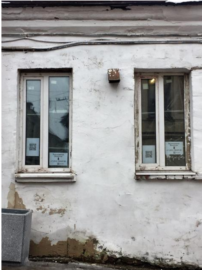
Фото 27. Отслоение, намокание и разрушение штукатурки в цокольной части, грубая обмазка шпаклевочной смесью участков с разрушенной штукатуркой на главном фасаде.
