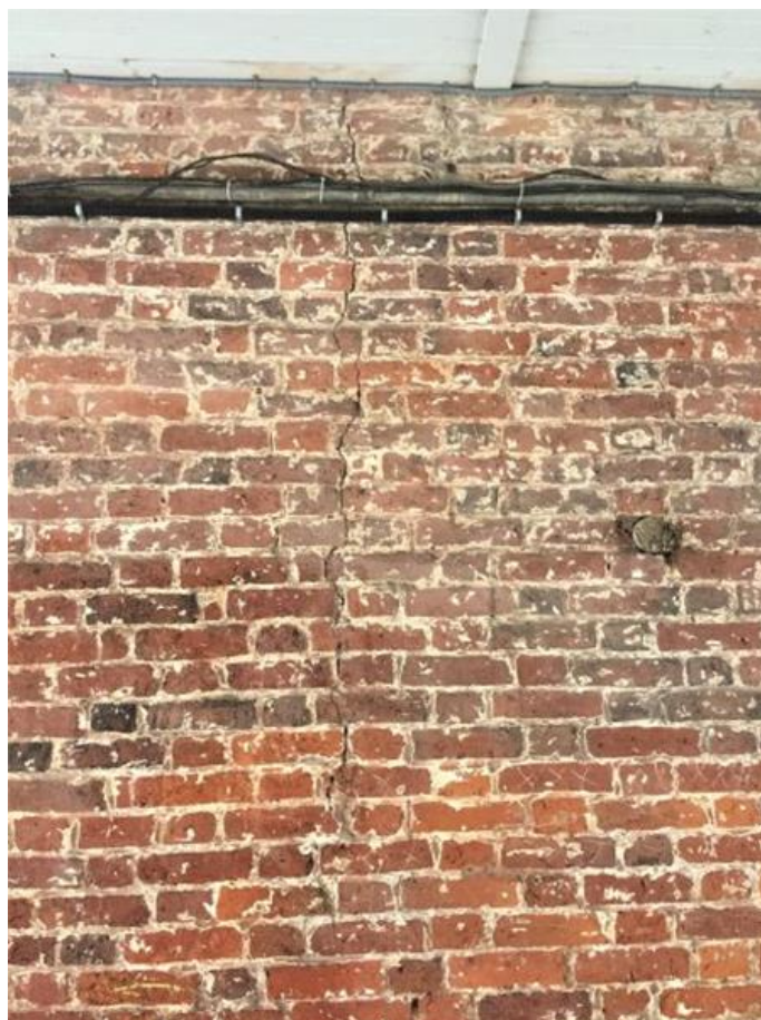
Фото 30. Вертикальная трещина в стене арочного проезда
