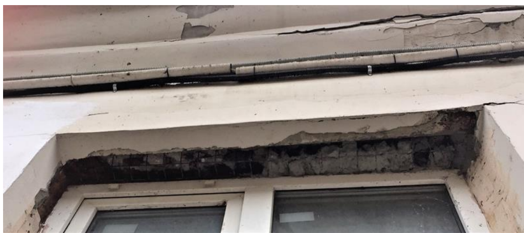
Фото 26. Разрушение кладки клинчатой перемычки, усиление металлическим уголком, коррозия металла.
