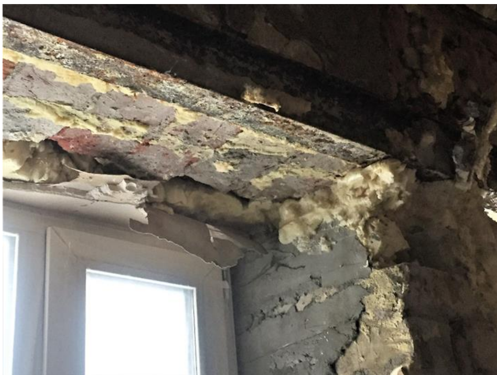
Фото 6. Разрушение кладки над проемом, оконных откосов, заполнение монтажной пеной. Коррозия металлической перемычки
