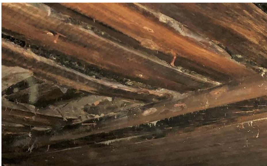
Фото 20. Растрескивание и побурение древесины, гниль, деформация перекрытия.
