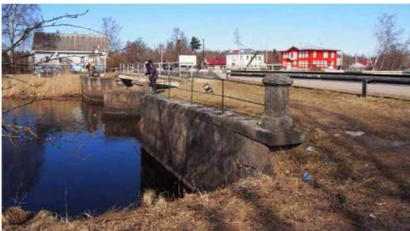
28. Деревня Кобона. Улица Новоладожский канал. Выявленный объект культурного наследия «Мост гранитный щитовой северный водоспуск».
