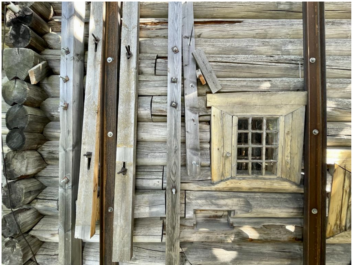
21. Церковь Рождества Богородицы (деревянная). Церковь. Противоаварийные сжимы. Штиглиц М.С. 19.07.2023.
