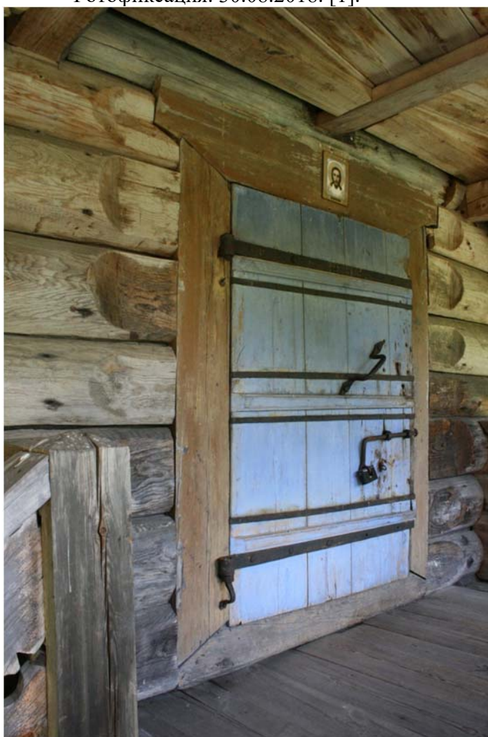
Илл. 41. Церковь Рождества Богородицы (деревянная). Наружная входная дверь на верхнем рундуке крыльца. Фотофиксация. 30.08.2018. [1].
