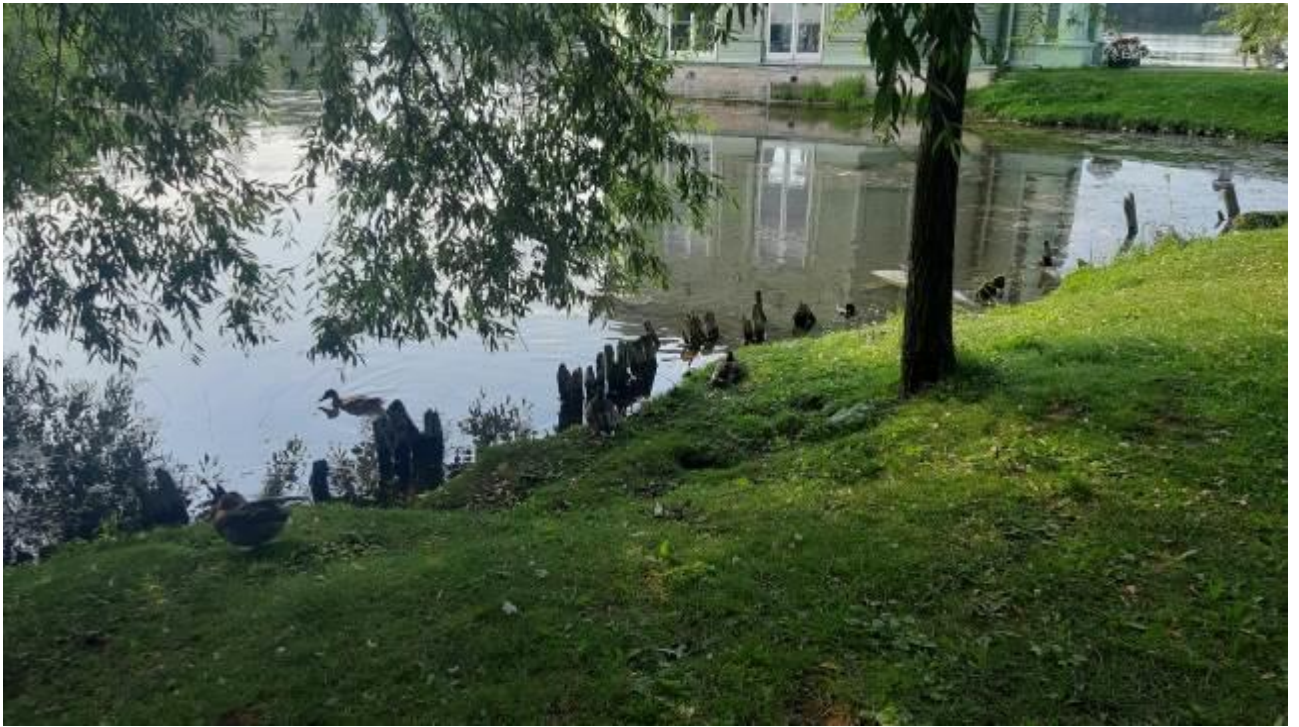
78. Дворцовый парк. Восточный берег Белого озера с южной стороны о. Любви. Разрушенные деревянные конструкции берегоукрепления. Штиглиц М.С. 12.08.2023.
