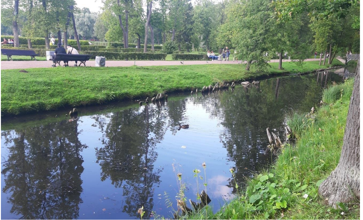
80. Дворцовый парк. Северный берег канала вокруг о. Любви. Разрушенные деревянные конструкции берегоукрепления. Штиглиц М.С. 12.08.2023.
