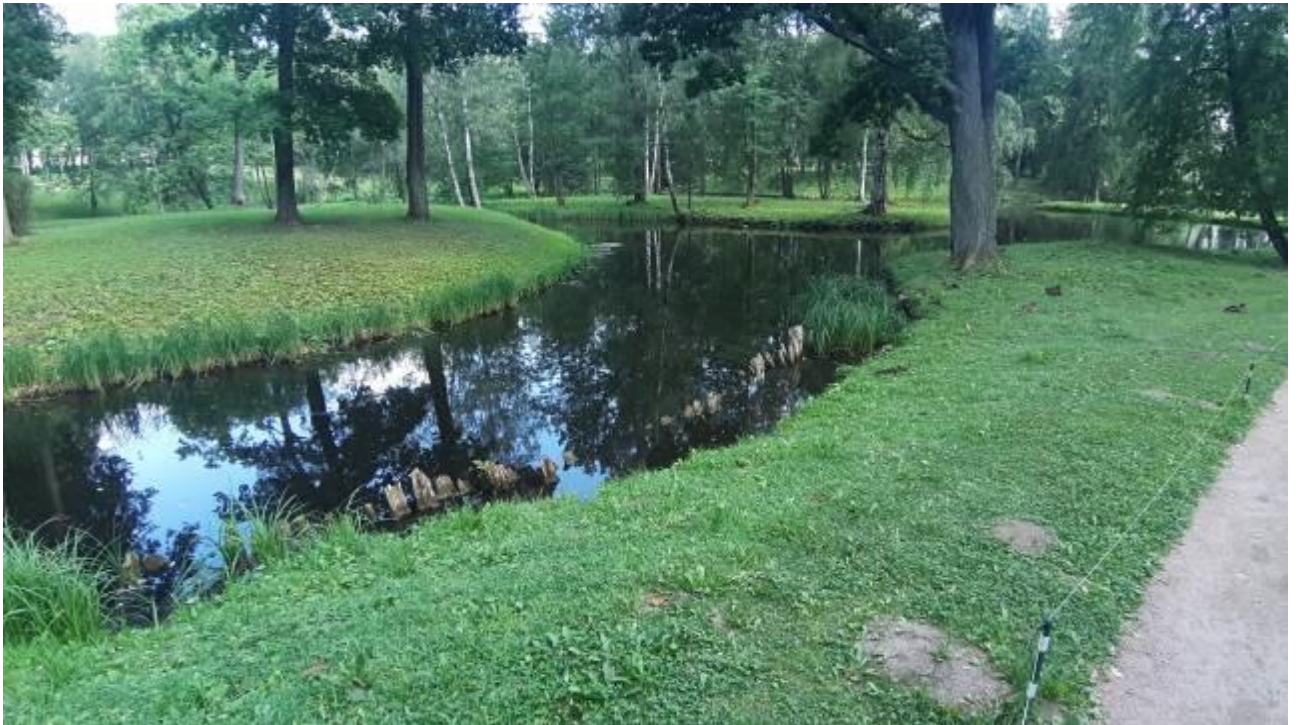
74. Дворцовый парк. Водный лабиринт. Разрушенные деревянные конструкции берегоукрепления. Штиглиц М.С. 12.08.2023.
