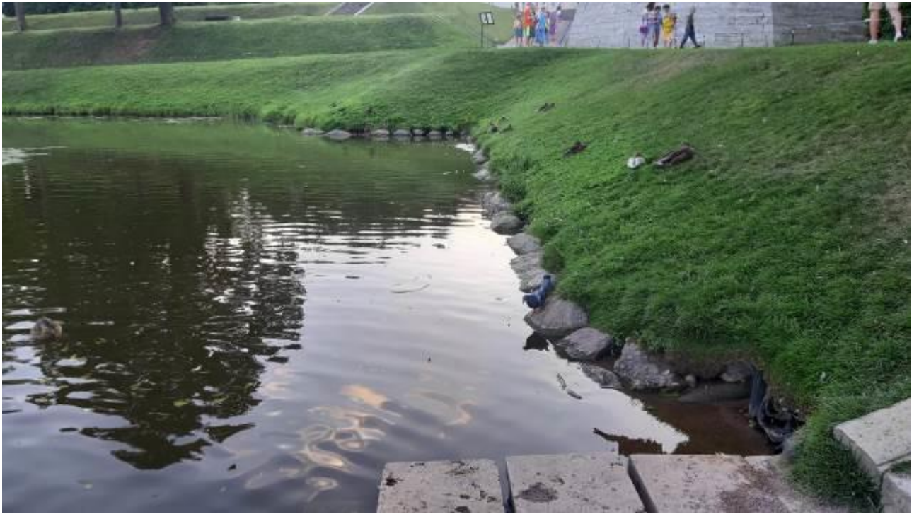
65. Дворцовый парк. Карпин пруд. Северный берег у гранитного спуска. Крепление камнем. Штиглиц М.С. 12.08.2023.
