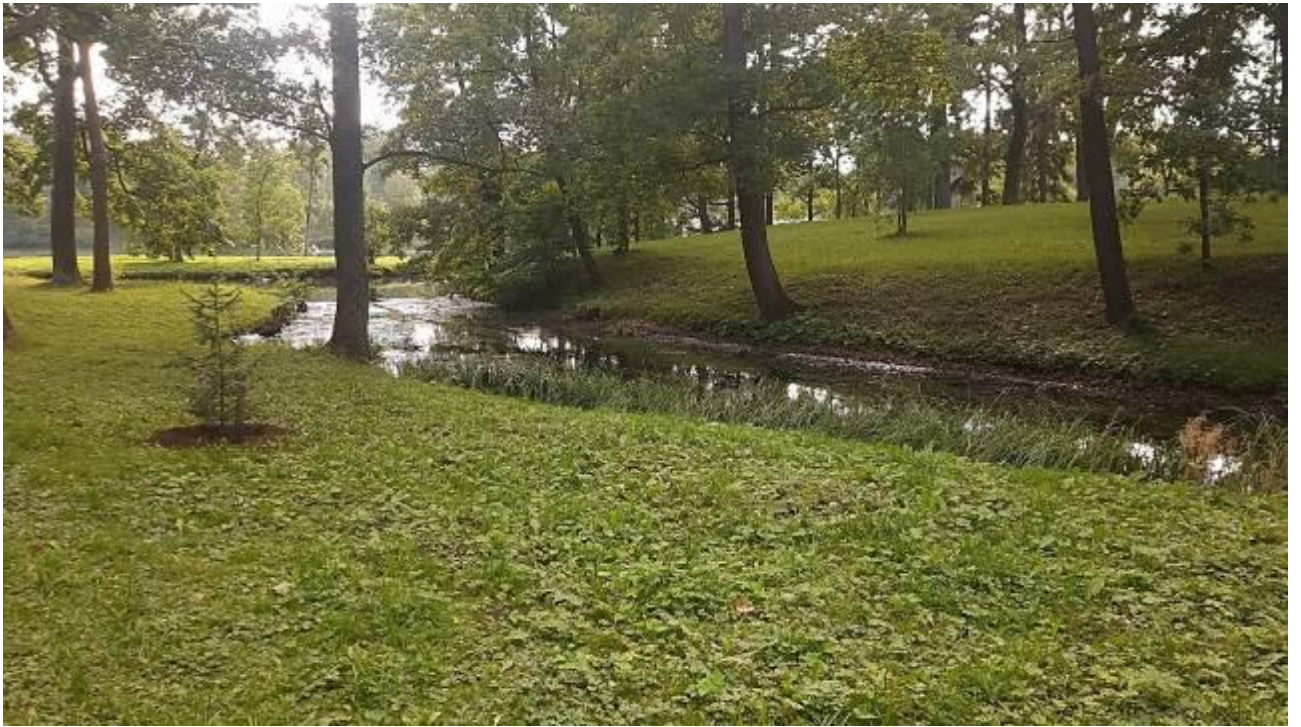
76. Дворцовый парк. Водный лабиринт. Разрушенные деревянные конструкции берегоукрепления. Штиглиц М.С. 12.08.2023.
