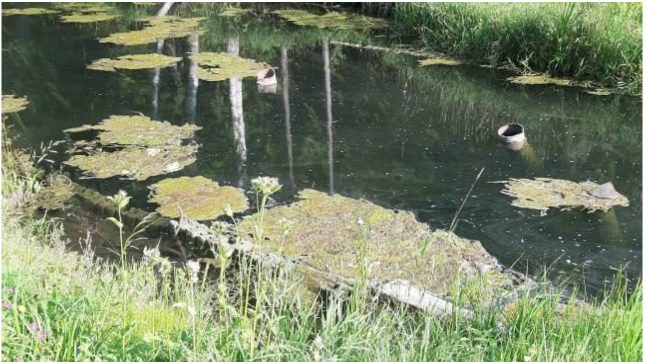
47. Дворцовый парк. Западная часть Павловского канала. Свайные конструкции. Разрушенный деревянный шпунт по обеим сторонам канала. Штиглиц М.С. 12.08.2023.
