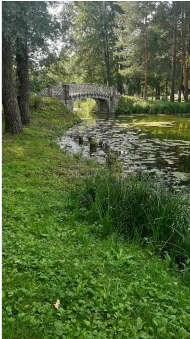
25. Дворцовый парк. Вид на мост с острова Захаров в центральной его части. Разрушенный деревянный шпунт. Штиглиц М.С. 12.08.2023.
