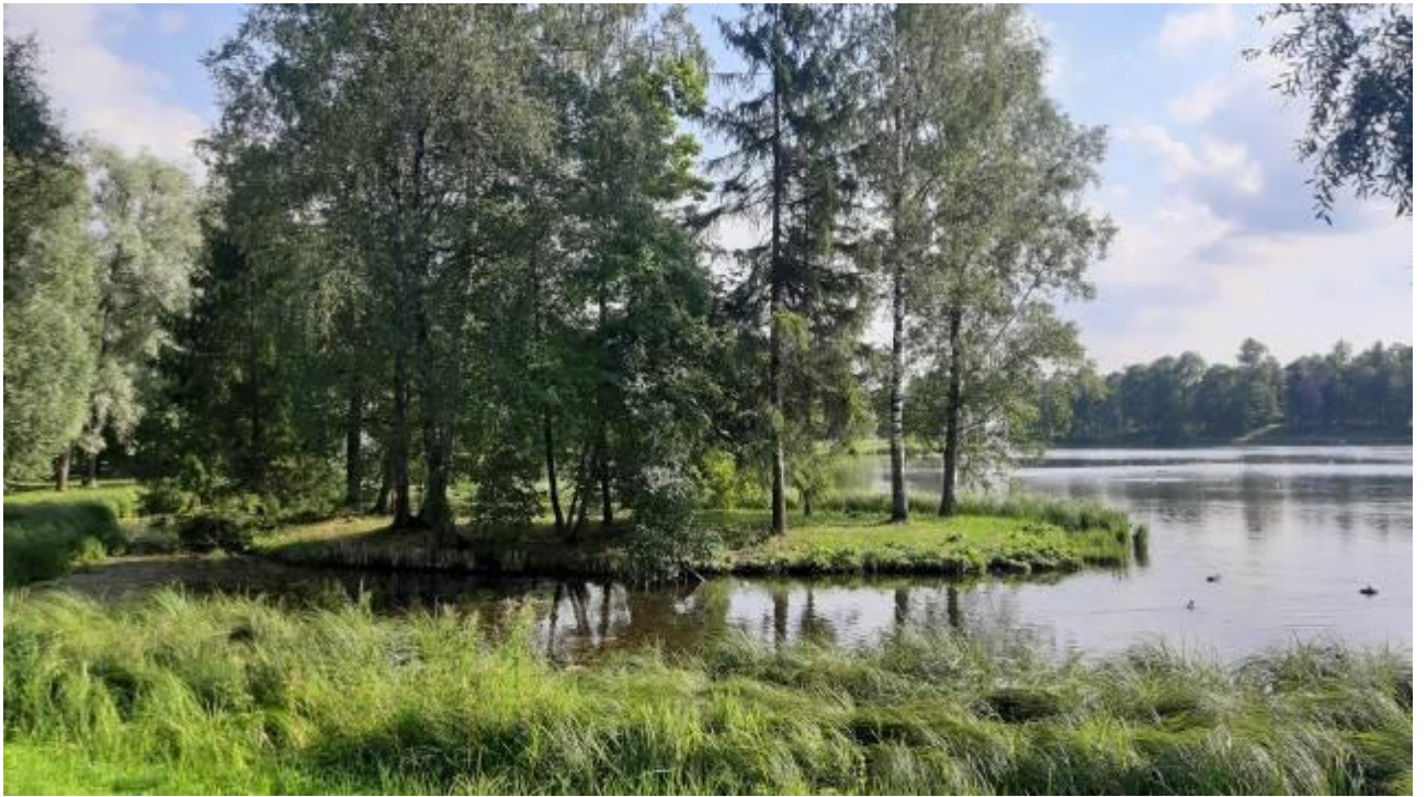
52. Дворцовый парк. Вид на остров Еловый. Разрушенный деревянный шпунт по периметру острова. Штиглиц М.С. 12.08.2023.
