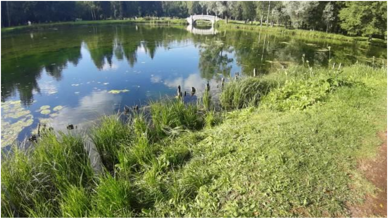
28. Дворцовый парк. Северо-западный берег острова Захаров. Разрушенный деревянный шпунт. Штиглиц М.С. 12.08.2023.
