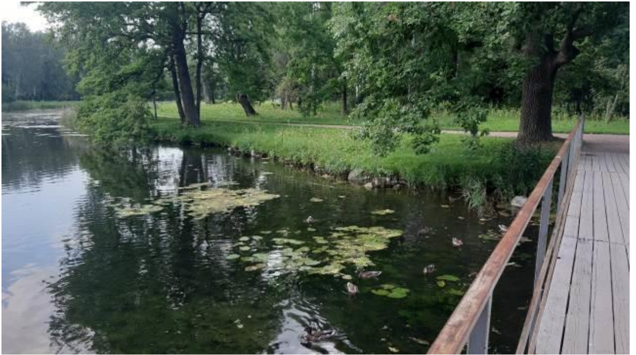
19. Дворцовый парк. Состояние берега у Малого Каменного моста. Вид на восток, слева от моста. Штиглиц М.С. 12.08.2023.
