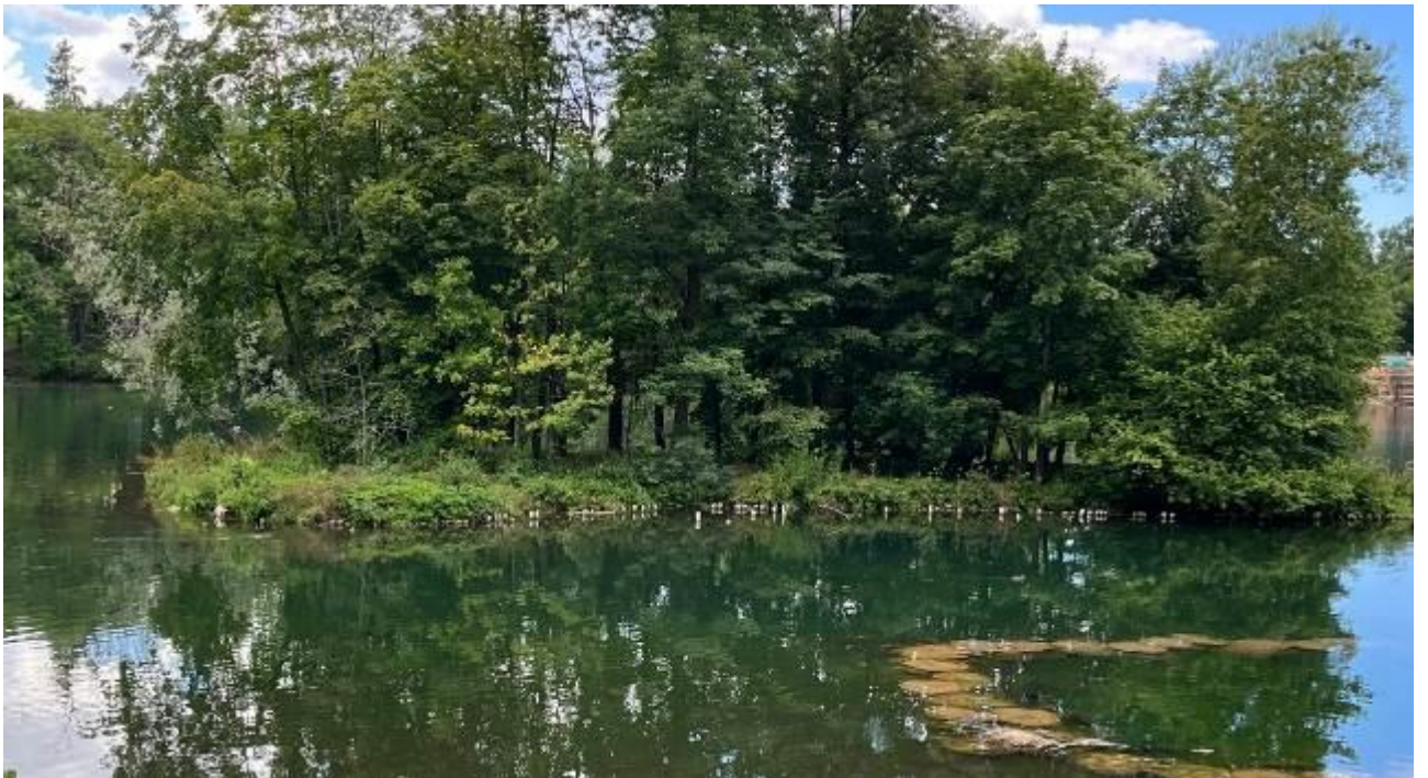
73. Дворцовый парк. Восточный берег о. Вороний. Разрушенные деревянные конструкции берегоукрепления. Штиглиц М.С. 12.08.2023.
