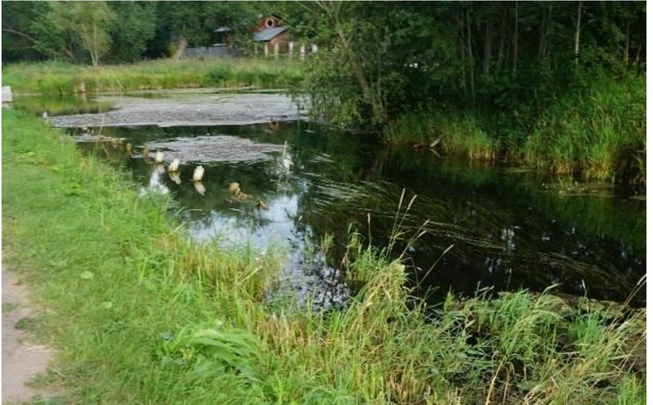
48. Дворцовый парк. Восточная часть Павловского канала. Остатки деревянного шпунта. Штиглиц М.С. 12.08.2023.
