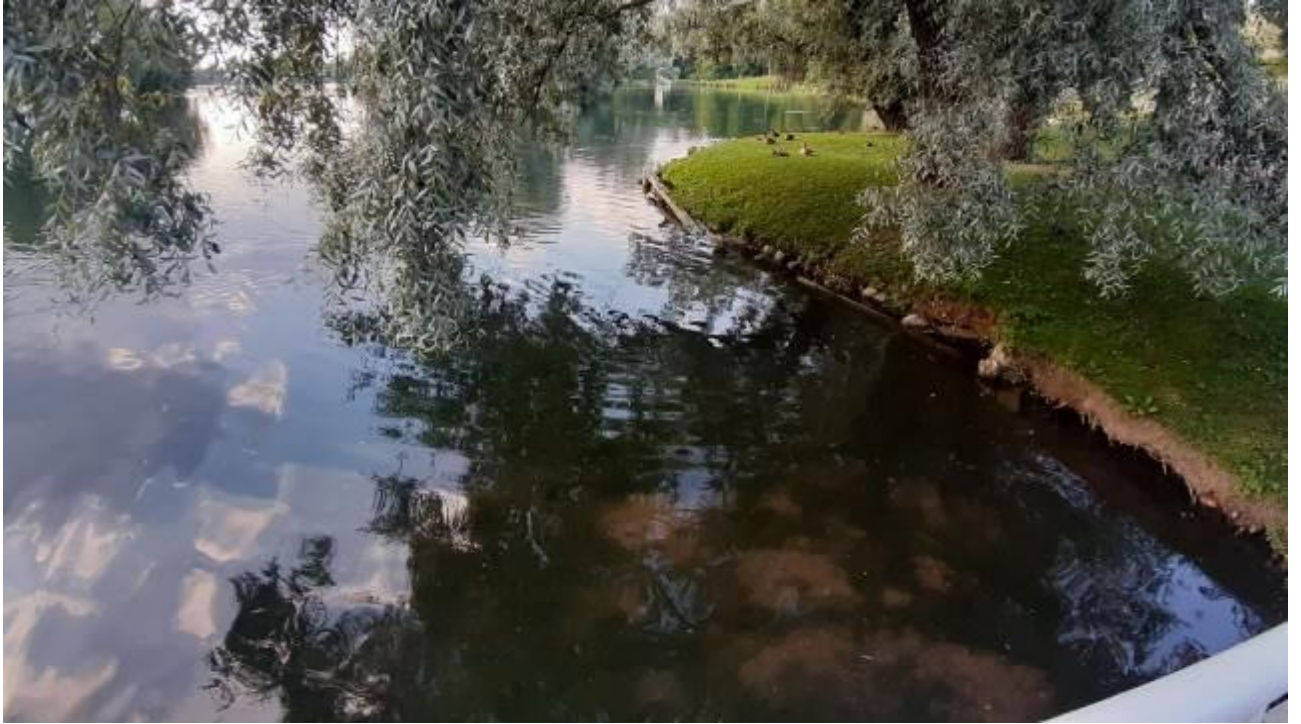
72. Дворцовый парк. Восточный берег Белого озера с северной стороны пешеходного моста. Разрушенные деревянные конструкции берегоукрепления. Штиглиц М.С. 12.08.2023.
