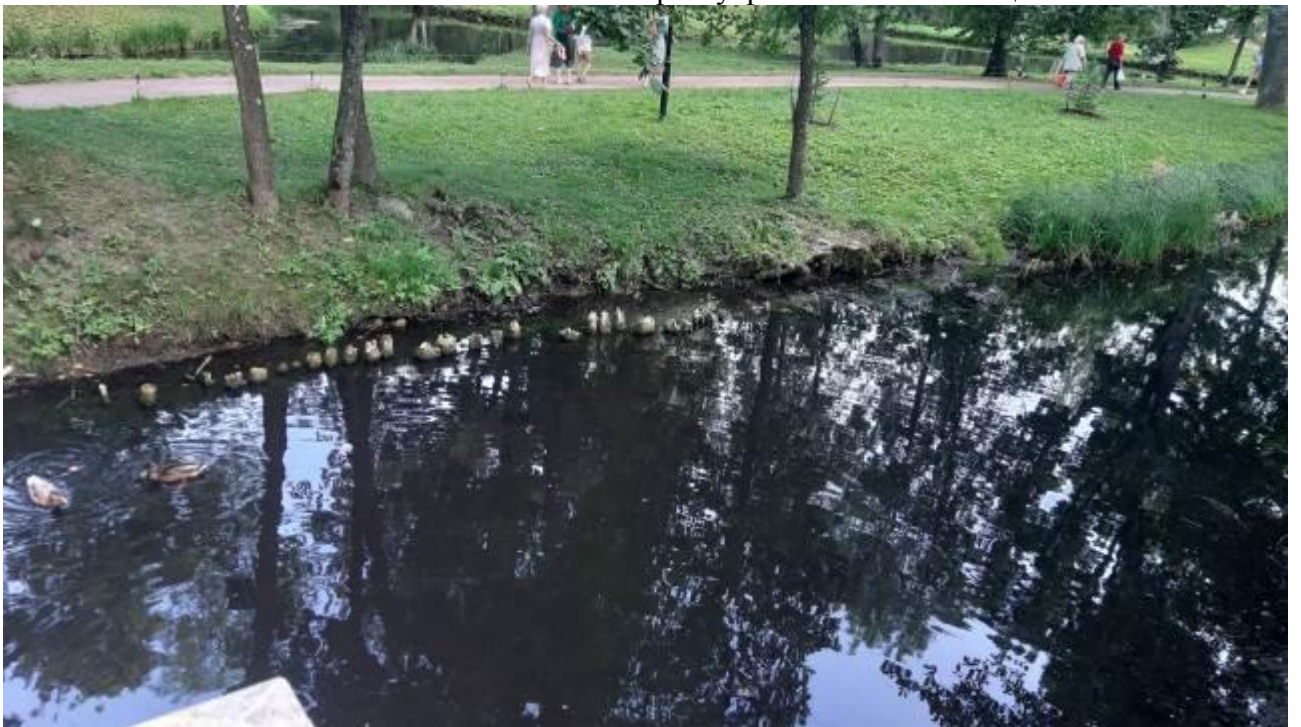
77. Дворцовый парк. Водный лабиринт. Разрушенные деревянные конструкции берегоукрепления. Штиглиц М.С. 12.08.2023.
