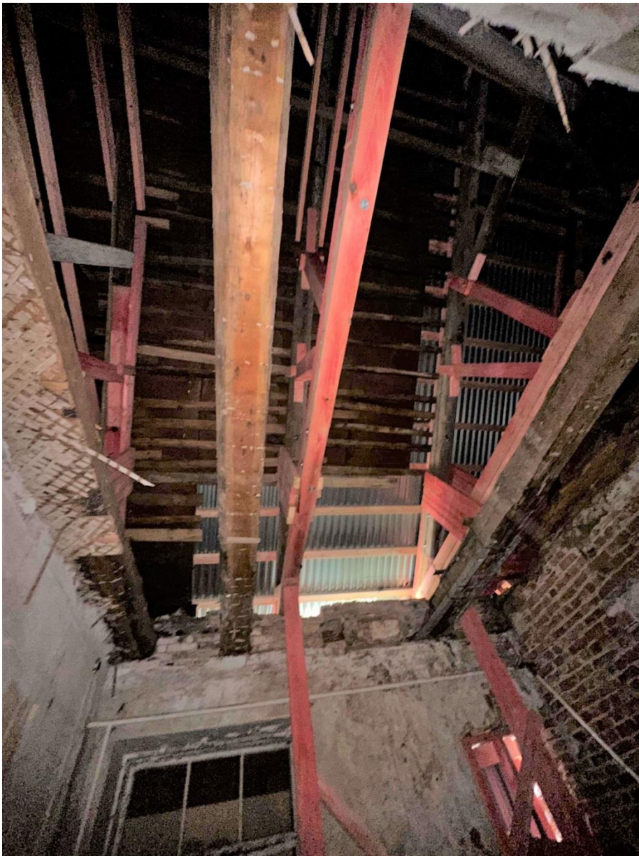
Фото 40. Пом. 1.11. Усиление конструкций крыши в помещении (первоочередные противоаварийные работы). Дата съемки: 30.08.2023 г. Автор съемки: Куваева Ю.П.
