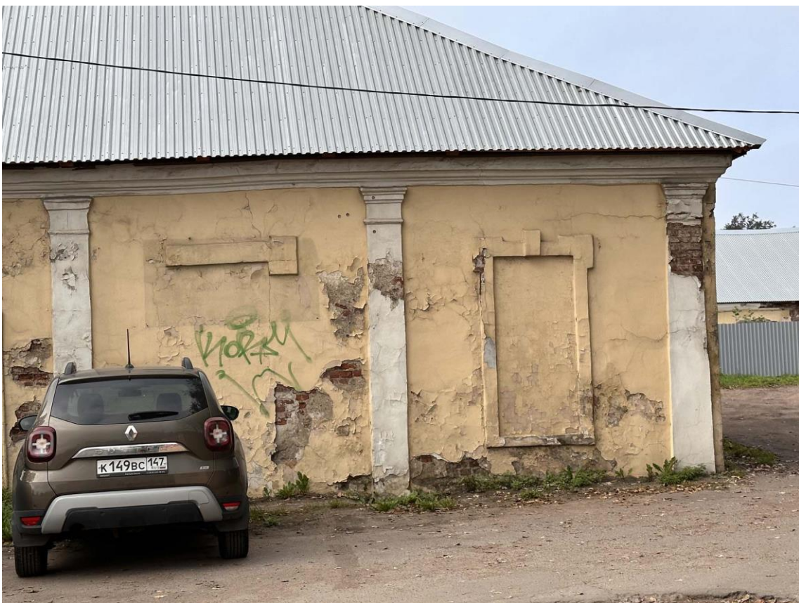
Фото 30. Фрагмент торцевого восточного фасада восточного крыла здания. Правая часть. Дата съемки: 30.08.2023 г. Автор съемки: Куваева Ю.П.
