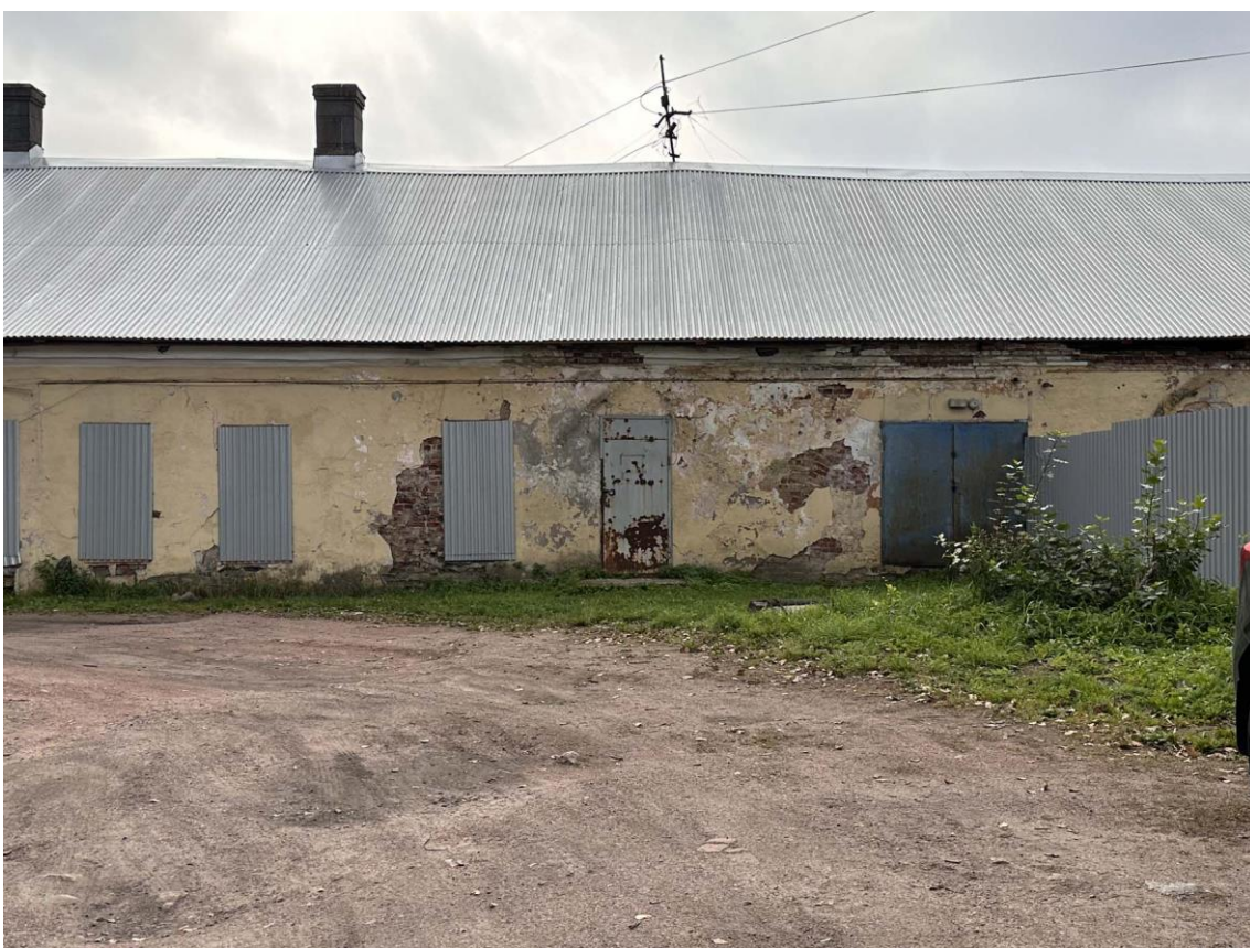
Фото 20. Фрагмент центральной части дворового северного фасада восточного крыла здания. Дата съемки: 30.08.2023 г. Автор съемки: Куваева Ю.П.
