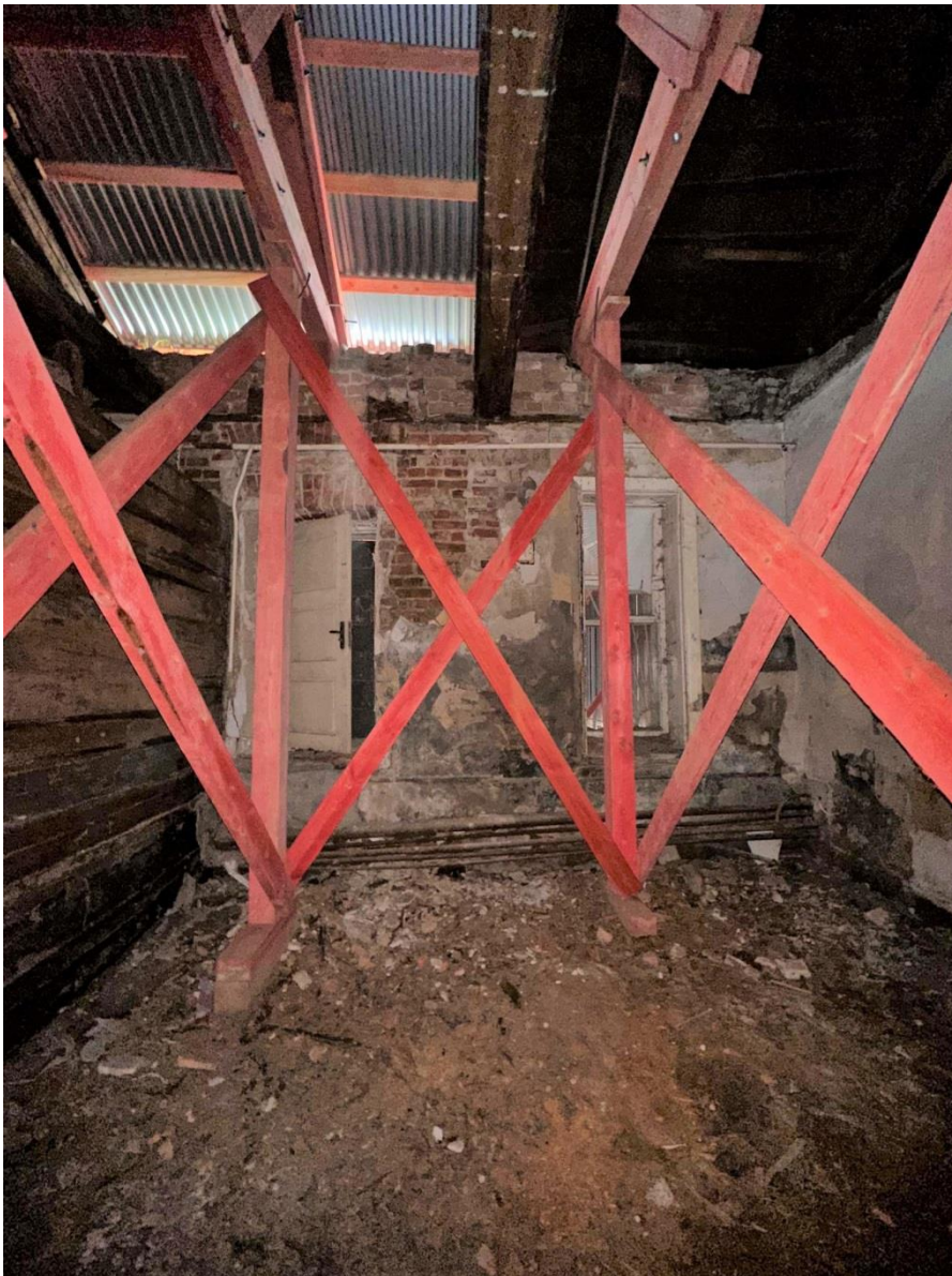
Фото 35. Пом. 1.5. Общий вид помещения после проведения первоочередных противоаварийных работ. Фото с запада. Дата съемки: 30.08.2023 г. Автор съемки: Куваева Ю.П.
