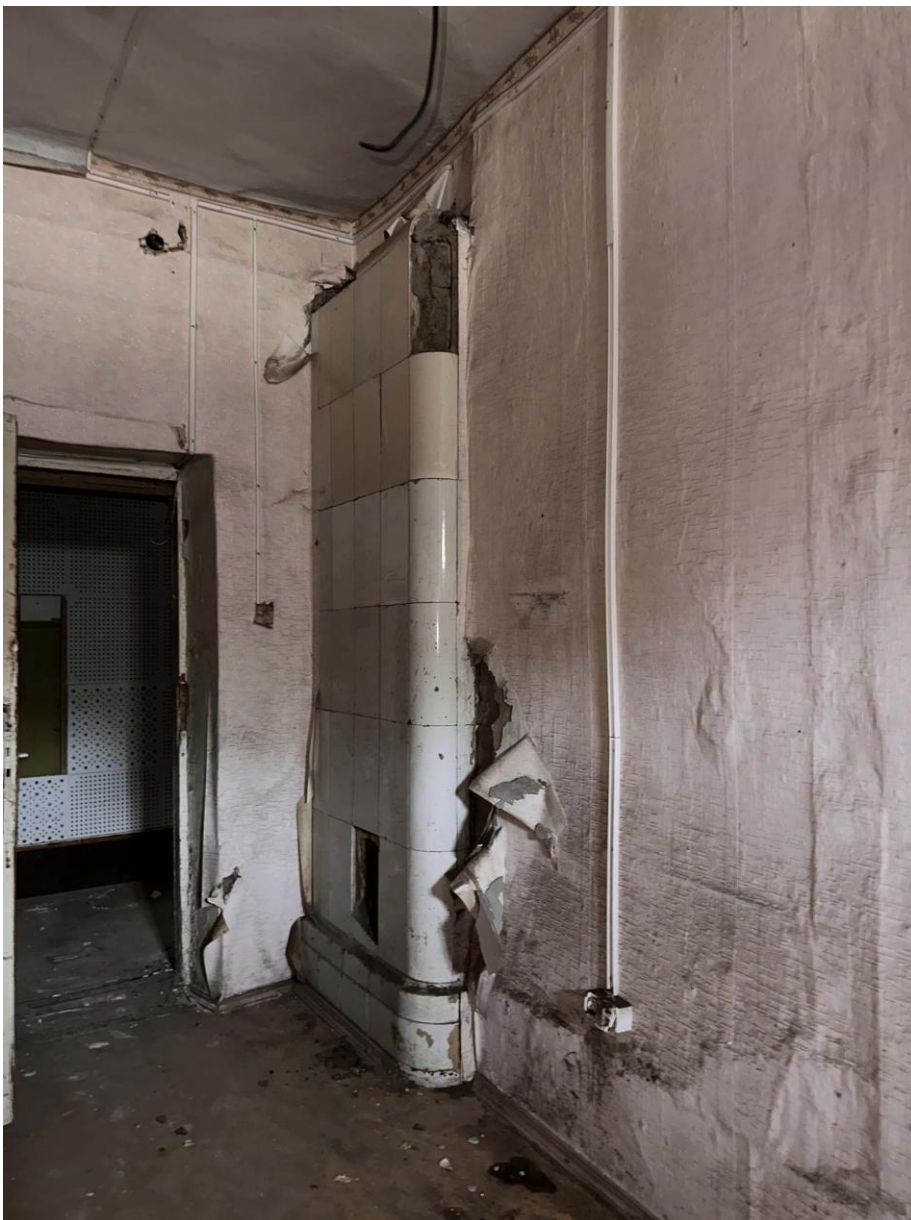
Фото 58. Пом. 1.53. Сохранившаяся печь в перегородке между помещениями 1.52-1.53. Фото с запада. Дата съемки: 30.08.2023 г. Автор съемки: Куваева Ю.П.
