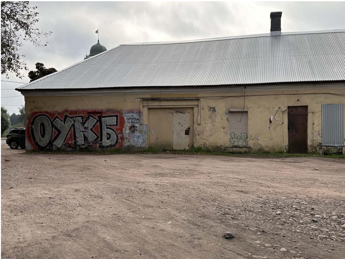
Фото 19. Фрагмент левой части дворового северного фасада восточного крыла здания. Дата съемки: 30.08.2023 г. Автор съемки: Куваева Ю.П.
