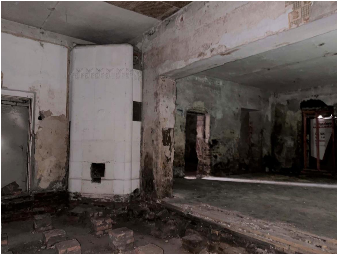
Фото 50. Пом. 1.36-1.37. Сохранившаяся печь. Фото с юго-запада. Дата съемки: 30.08.2023 г. Автор съемки: Куваева Ю.П.
