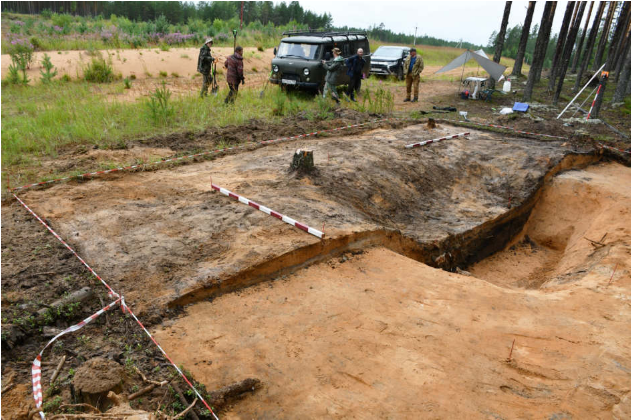
Илл. 22. Ленинградская область. Тихвинский муниципальный район. Выявленный ОАН «Углежогная яма Березовик-6». Кв. А-Д 3,4. Зачистка после снятия дерна. Вид с северо-запада.
